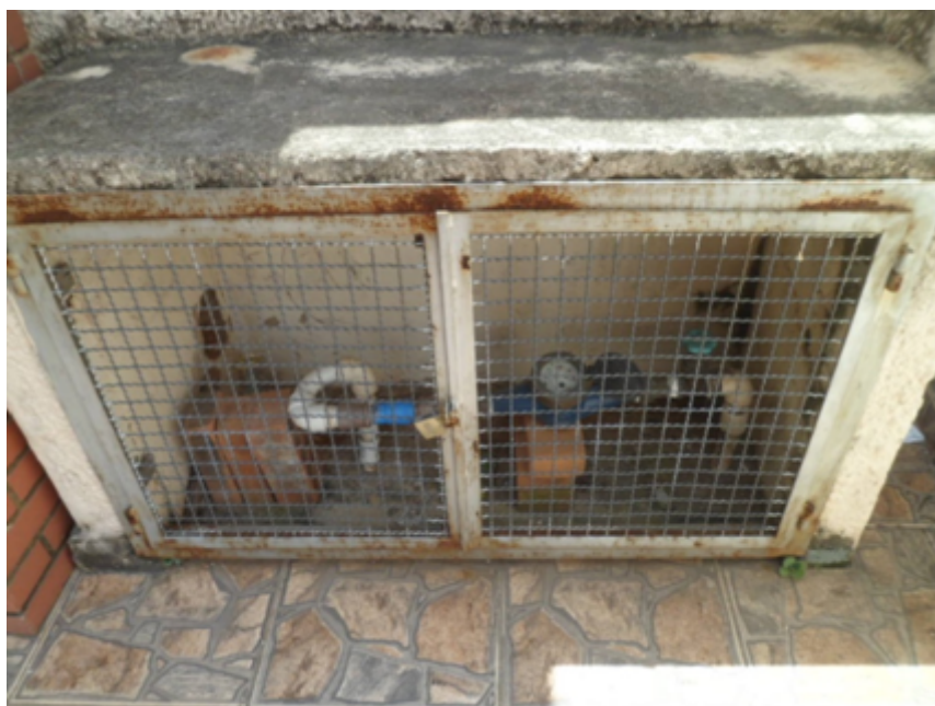
Foto 08 – Hidrômetro do Prédio
