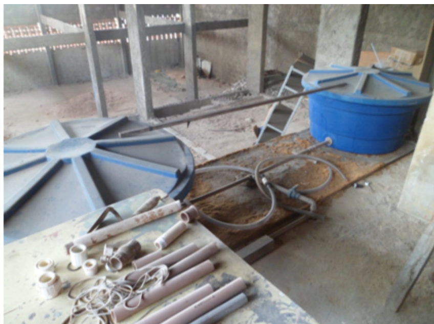
Foto 05 – 02 (dois) Reservatórios com 500 litros d'Água
