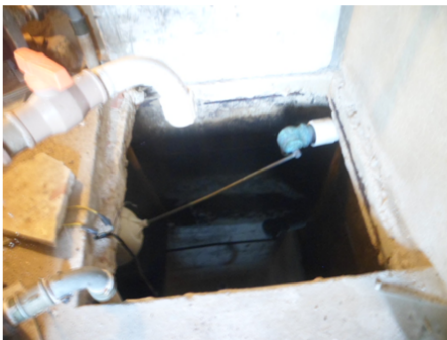
Foto 04 – Cisterna com 18.000 litros totalmente cheia
