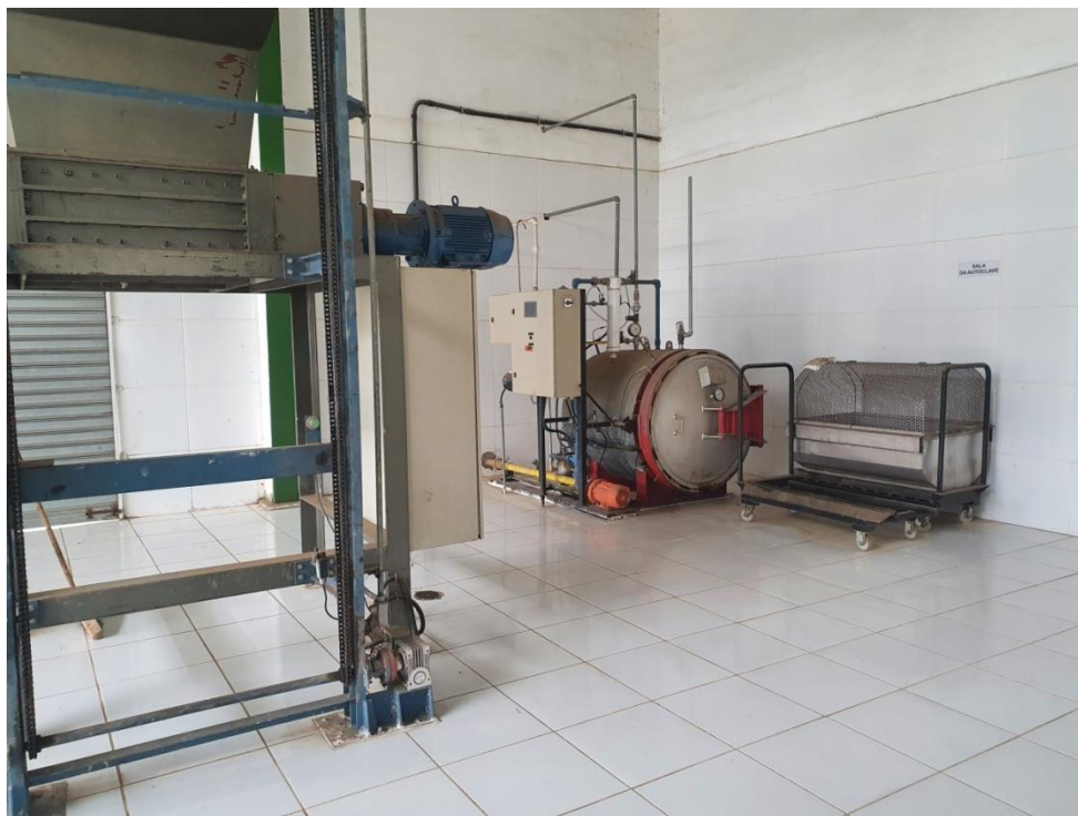
Figura 21: Sala da autoclave
