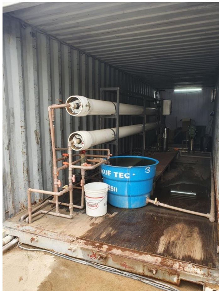
Figura 15: Container que abriga os equipamentos do tratamento de chorume por osmose reversa
