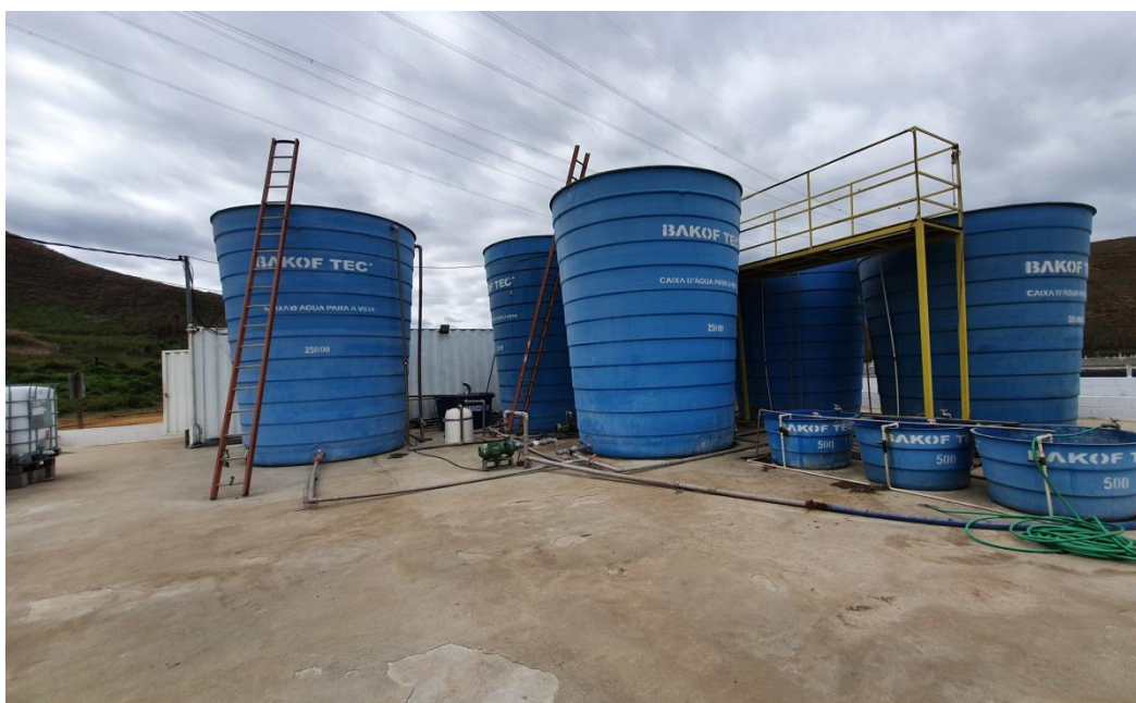
Figura 16: Sistema de tratamento de chorume
