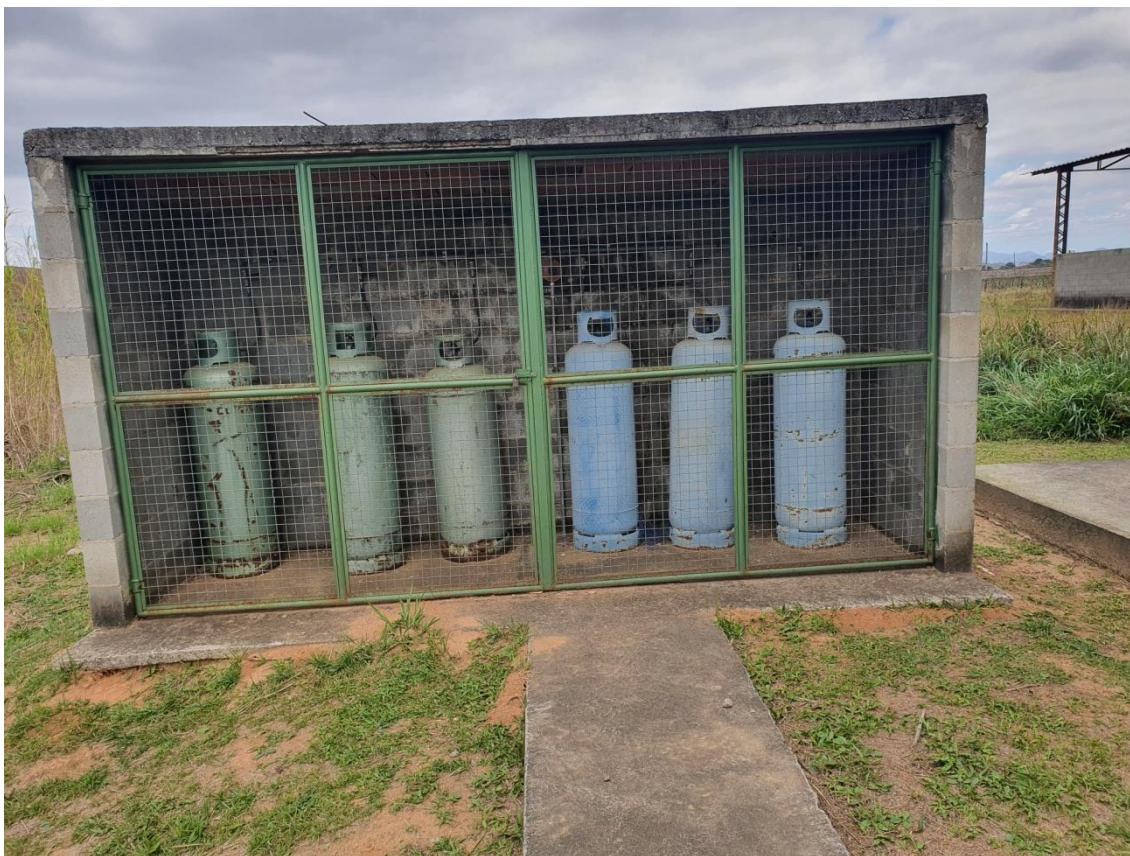
Figura 25: Cilindros de gás para alimentação da caldeira
