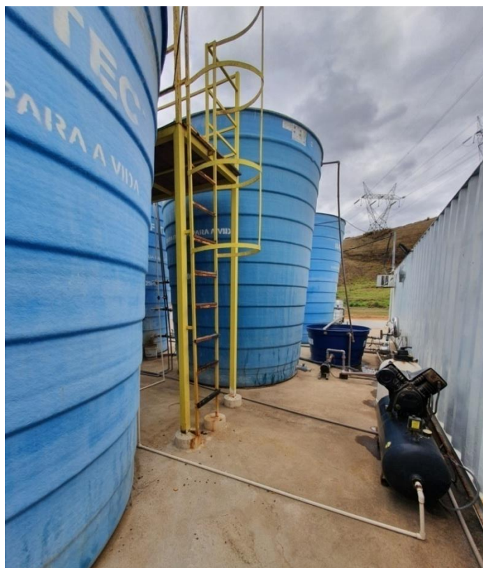
Figura 17: Sistema de tratamento de chorume
