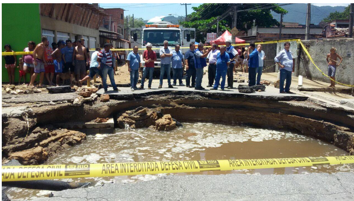
EQUIPE DE APOIO JUNTO À CRATERA FORMADA PELO VAZAMENTO
