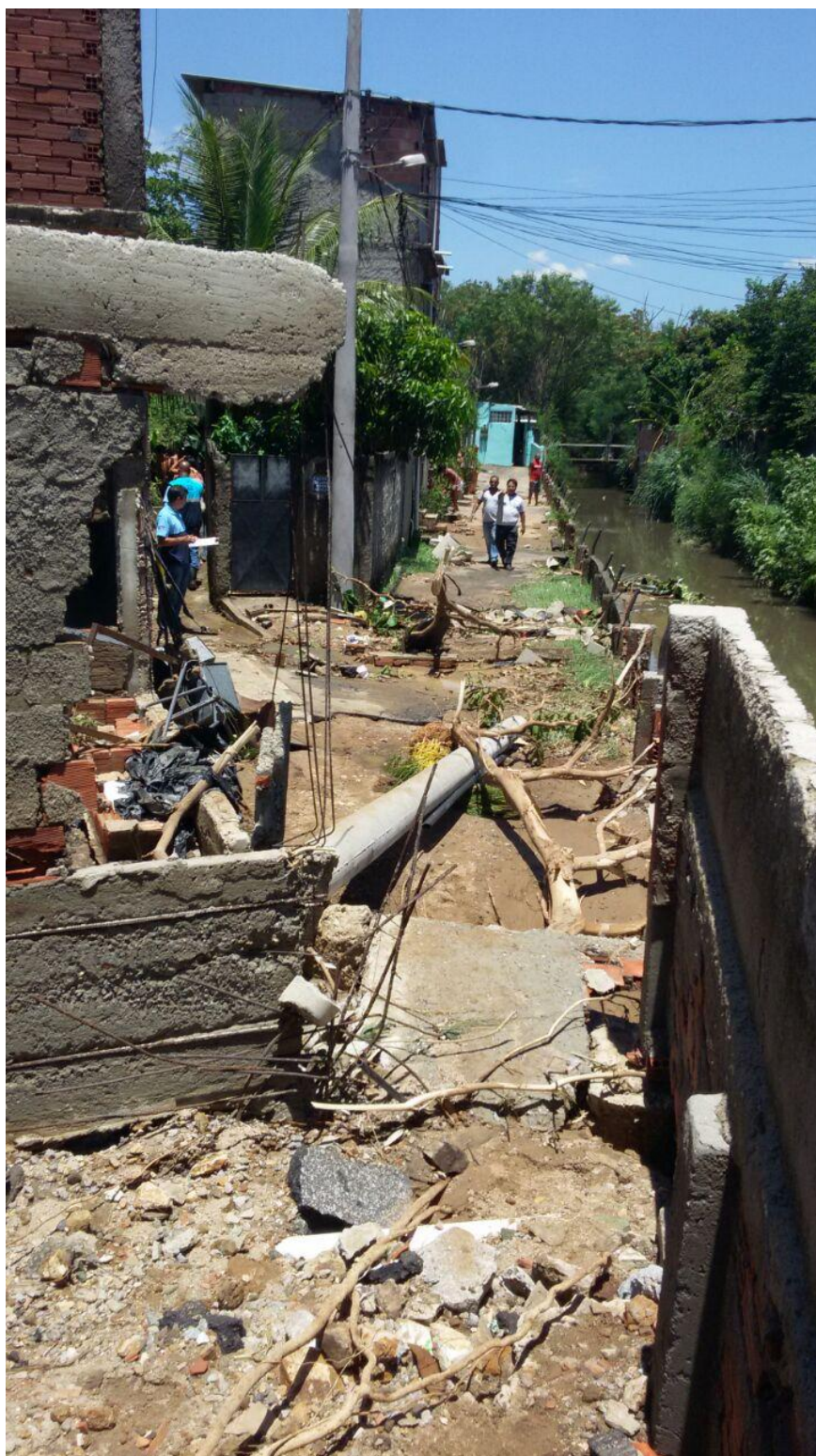
MURO E RESIDÊNCIA DANIFICADOS
