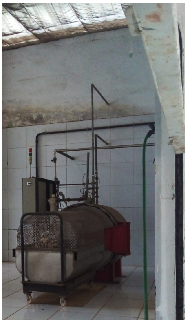
Figura 19: Autoclave disponibilizada para realizar o tratamento de RSS. Inoperante
