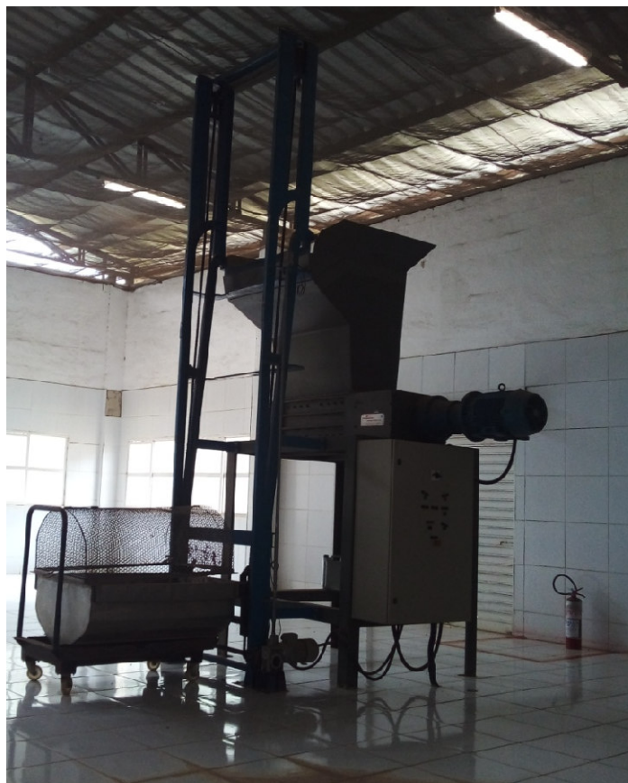
Figura 18: Autoclave disponibilizada para realizar o tratamento de RSS. Inoperante.
