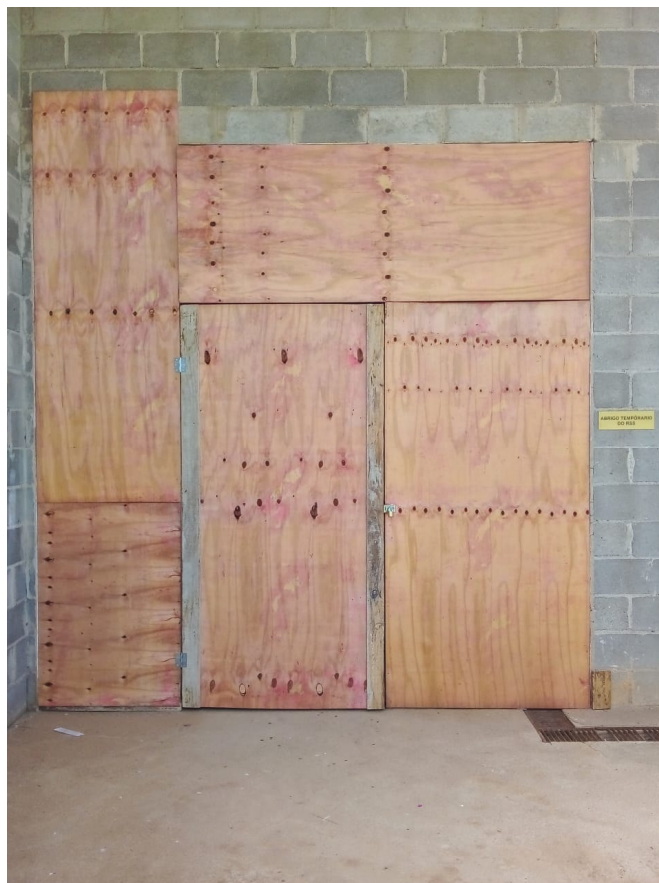
Figura 22: Acesso ao galpão de RSS .
