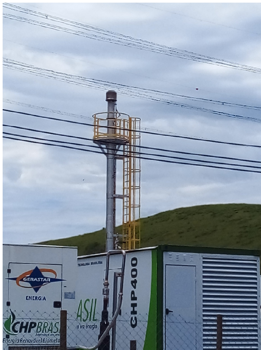
Figura 26: Flare da Estação de Biogás
