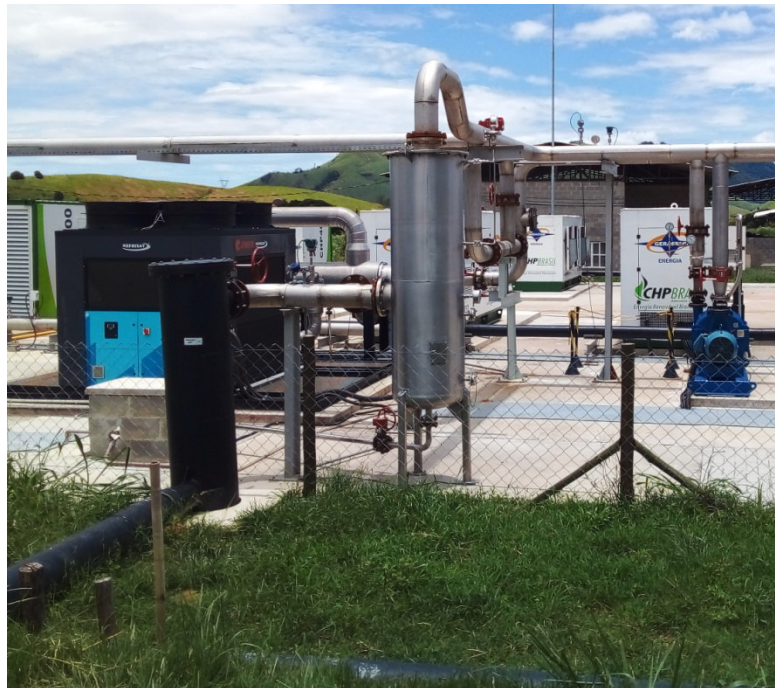
Figura 24: Estação de Biogás
