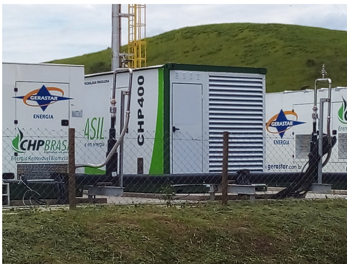
Figura 23: Geradores da Estação de Biogás
