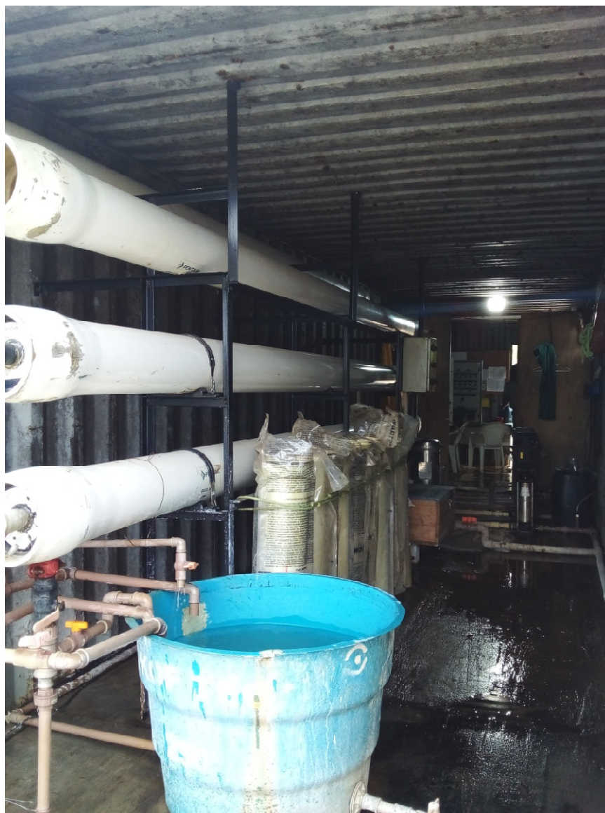
Figura 15 : Sistema de filtragem e membranas para a osmose reversa
