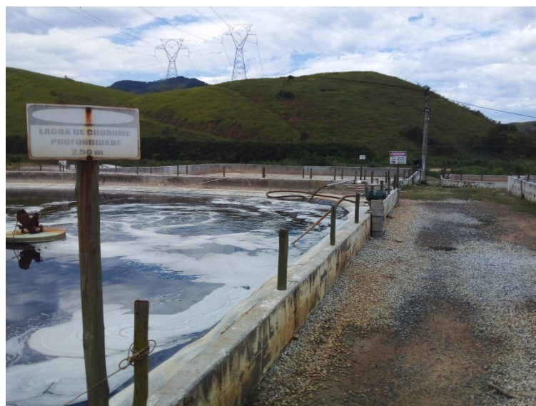
Figura 9: Lagoa de chorume primária com areador em funcionamento
