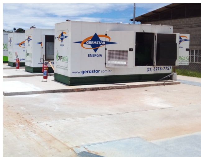
Figura 25: Vista dos geradores da estação de Biogás
