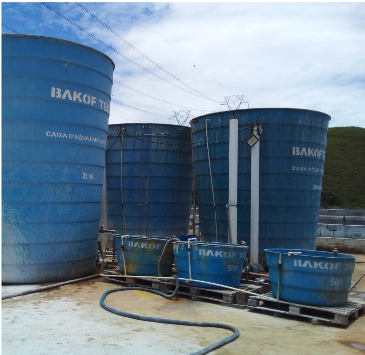
Figura 14 : Tanques de armazenamento para o tratamento da água em osmose reversa
