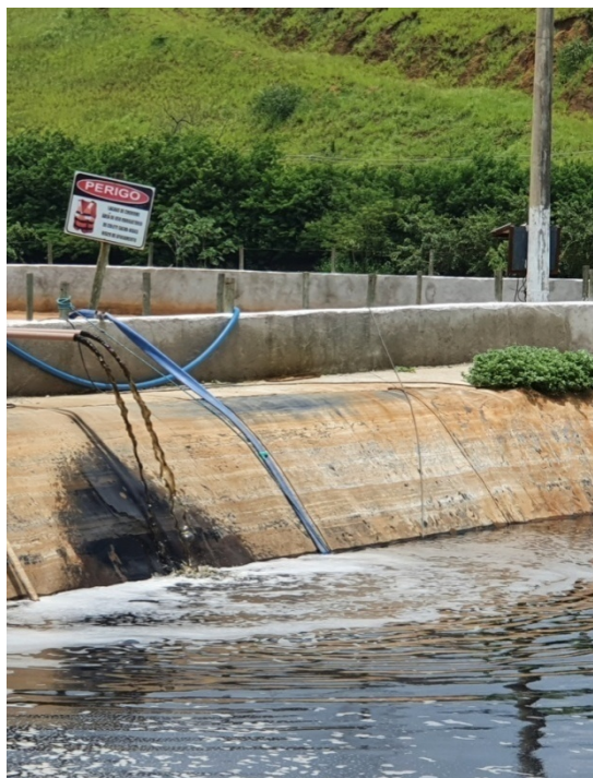
Figura 5: Lagoa de acumulação de chorume
