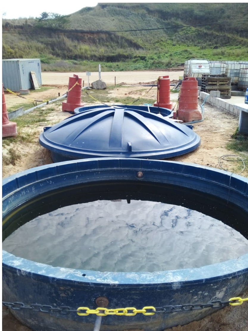
Figura 6: Local de armazenamento de água de reuso (efluente após passar pelo tratamento).
