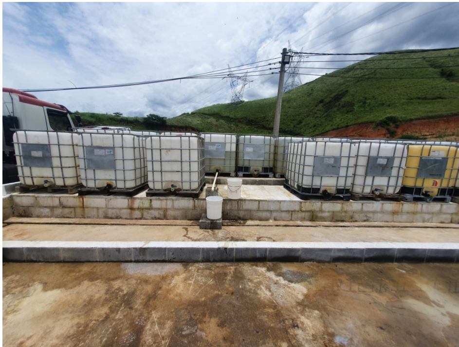
Figura 4: Local de armazenamento de produtos a serem realizados no tratamento do chorume.
