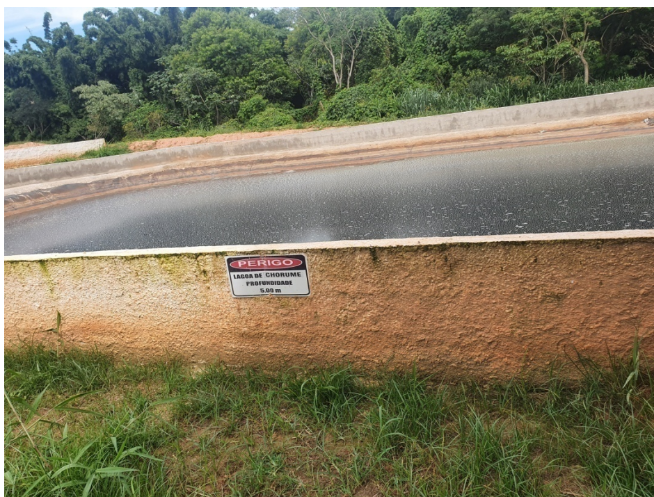
Figura 11: Lagoa de armazenamento de chorume, cujo efluente é recolhido por caminhões para posterior tratamento.
