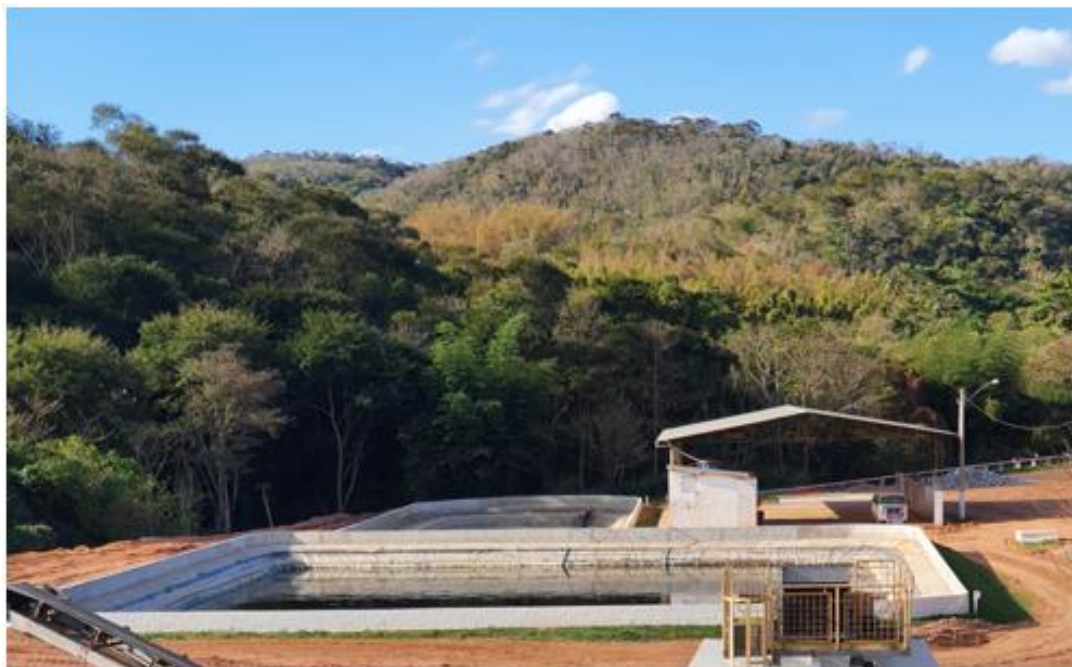
Figura 15: Lagoas de acumulação de chorume
