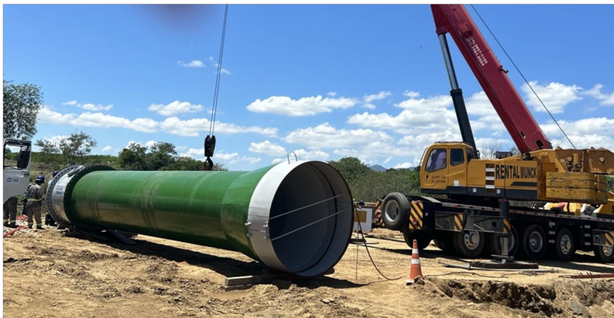
Foto 7 – Macro medidor já conectado ao tubo, no local
