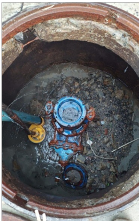
Foto 7 – Estado ventosa e registro após contido o vazamento, pré reparo
