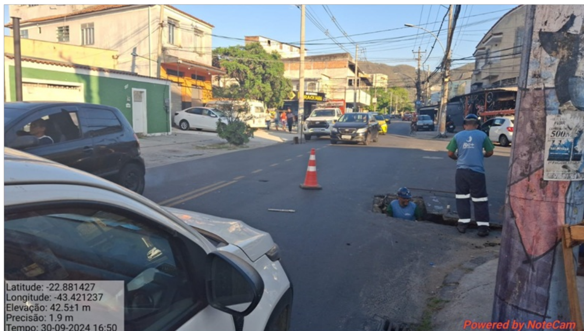
Foto 4 – Local válvulas Rua Piraquara
