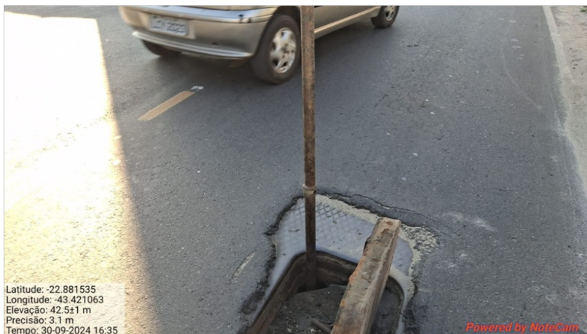
Foto 5 – Válvula tubulação menor porte Rua Piraquara
