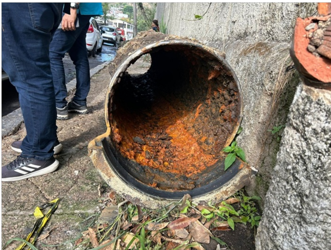
Foto 3 – Tubulação que apresentou vazamento, retirada do local
