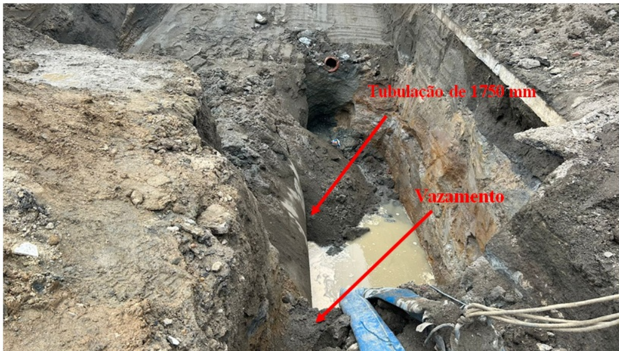
Foto 3 – Tubulação de DN 1750 mm com vazamento na bolsa
