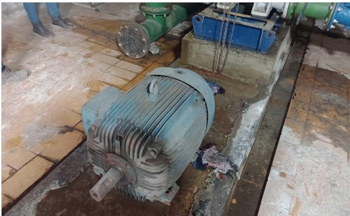
Foto 5 – Motor do conjunto reserva
