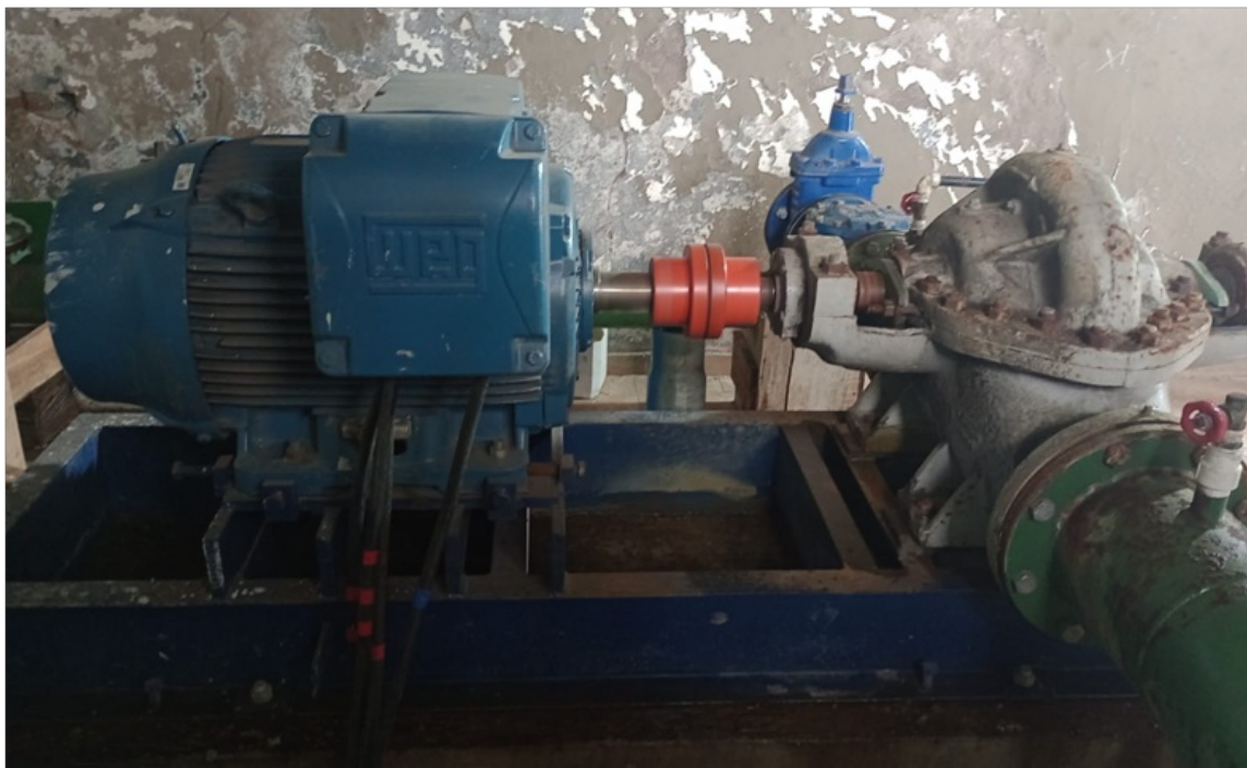
Foto 3 – Conjunto motobomba que está em operação
