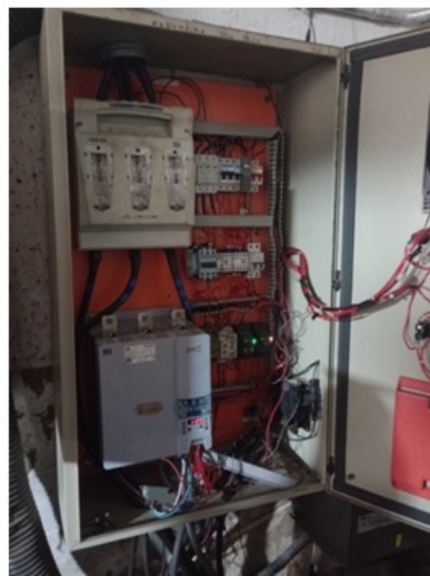
Foto 11 – Painele de automação aberto
