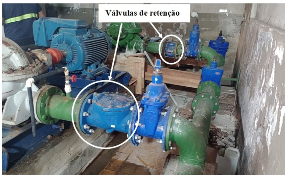
Foto 6 – Válvulas de retenção nos dois conjuntos
