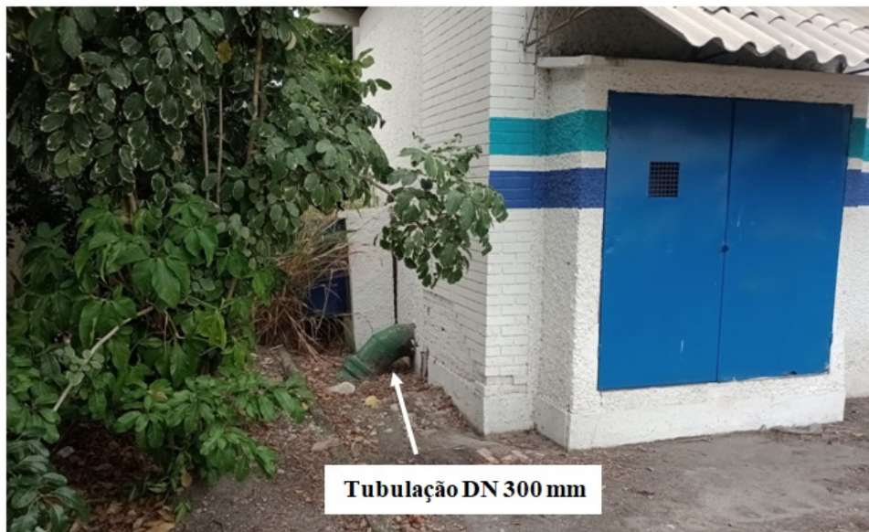
Foto 7 – Tubulação que entra no abrigo
