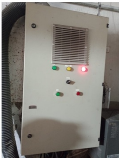
Foto 10 – Painele de automação fechado sem sinalização
