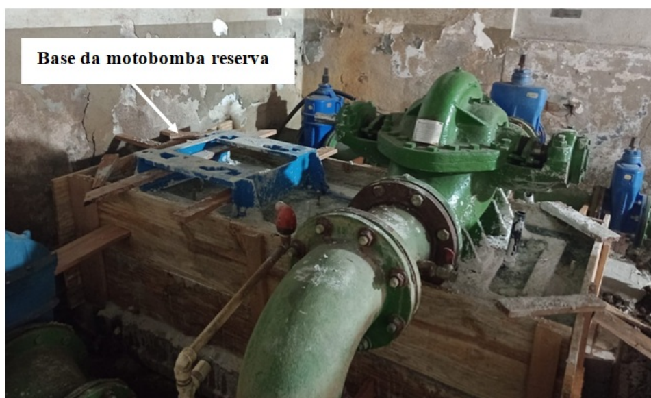
Foto 4 – Local onde se situa o conjunto motobomba reserva
