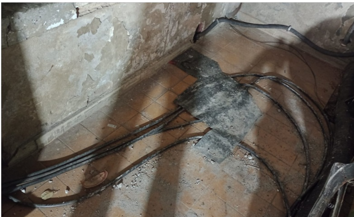
Foto 17 – Fiação sem proteção
