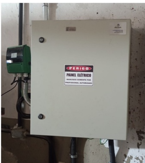
Foto 12 – Painele elétrico com sinalização de perigo
