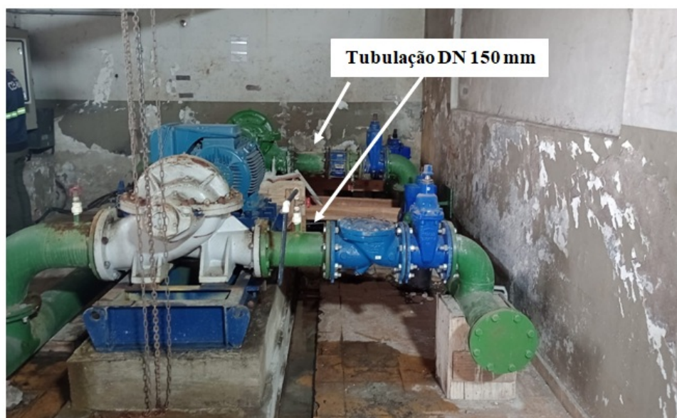
Foto 9 – Tubulação de recalque
