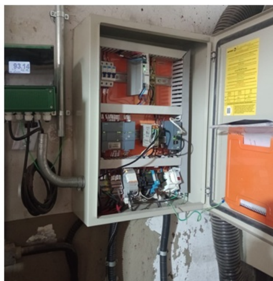
Foto 13 – Painele elétrico aberto
