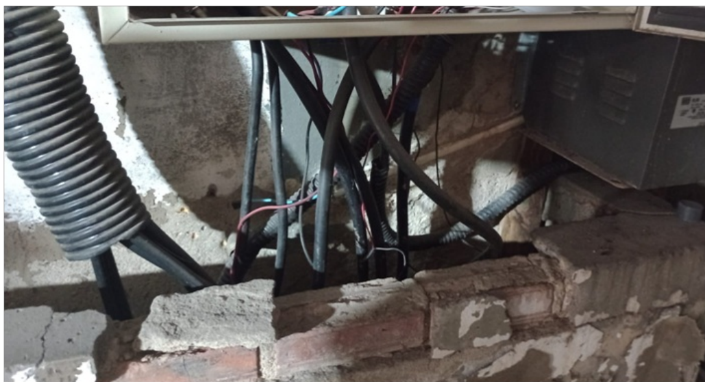
Foto 16 – Fiação sem proteção
