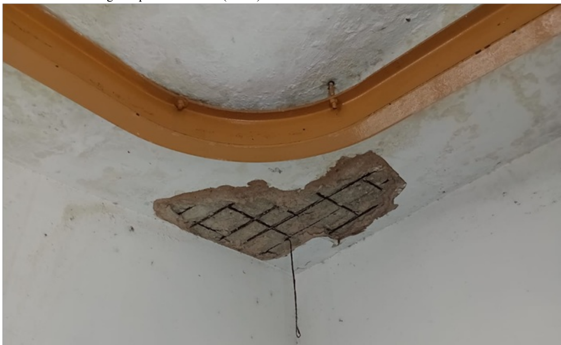
Foto 8 – Ferragens aparentes no teto do abrigo da EEAT
