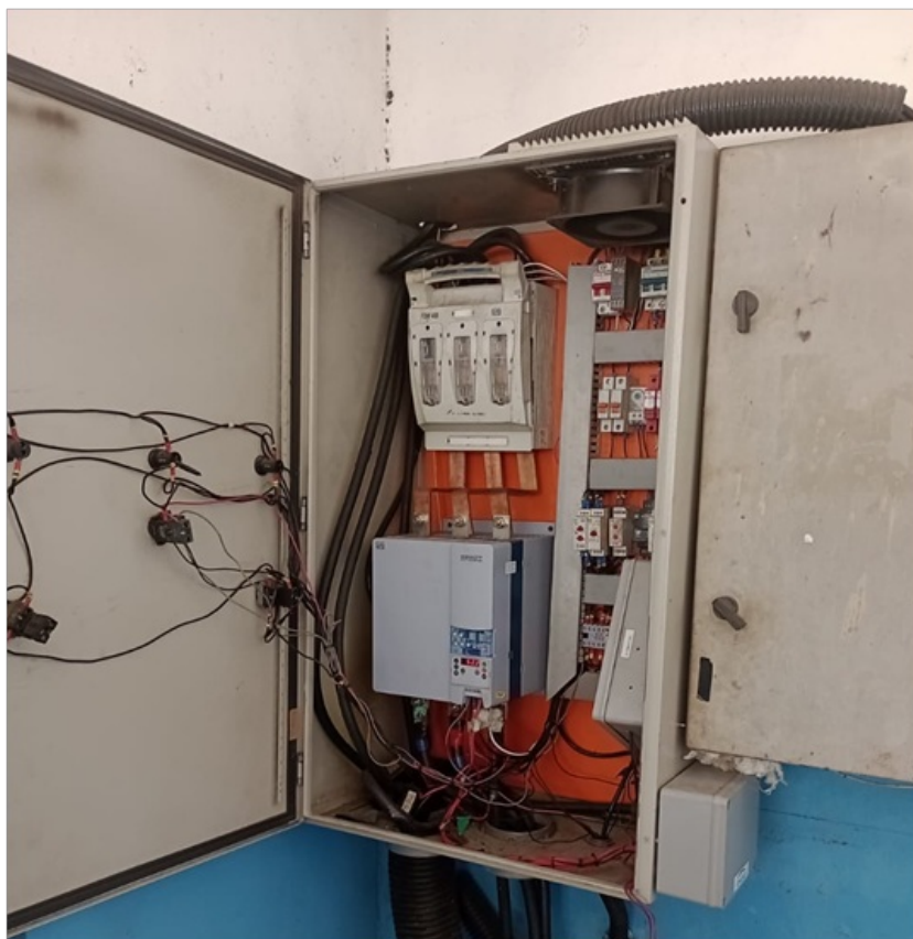
Foto 7 – Interior do painel de automação
