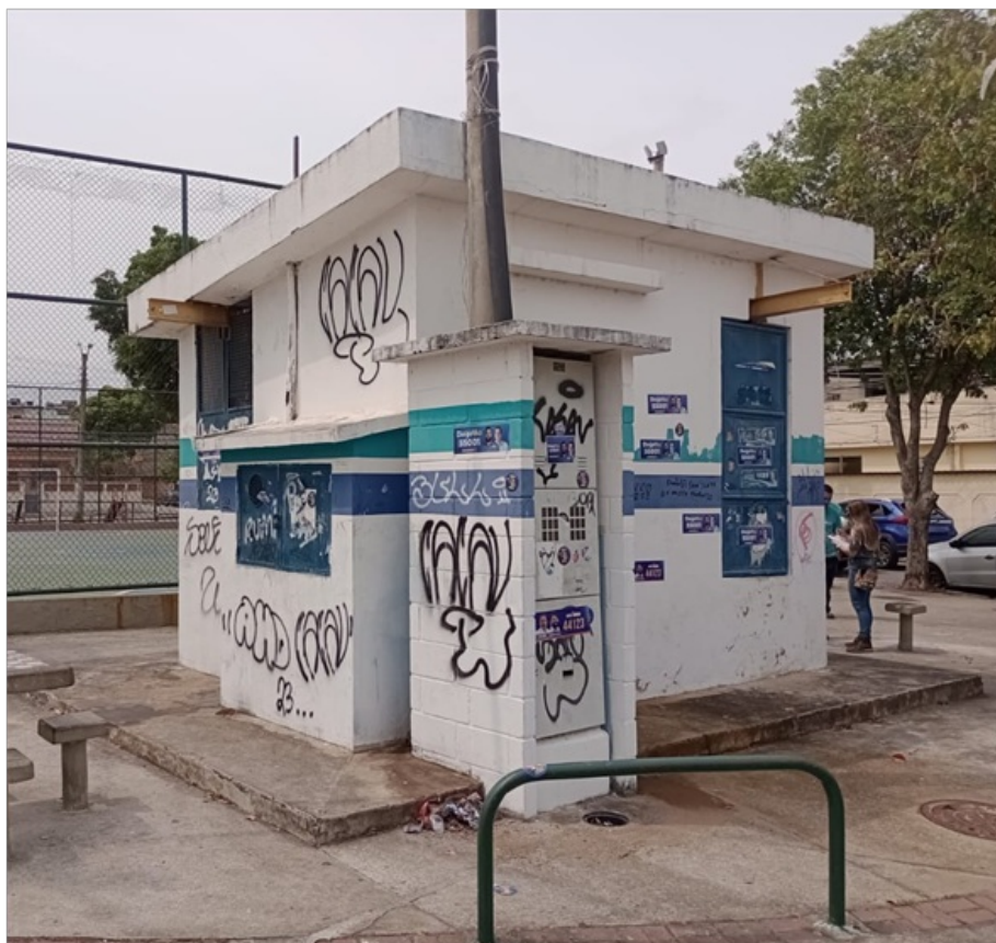
Foto 1- Abrigo da EEAT sem identificação
