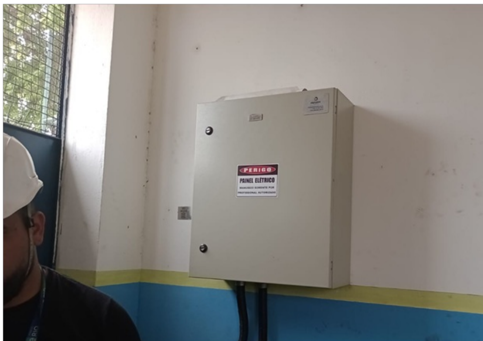
Foto 4 - Painel elétrico sinalizado quanto ao risco de choque elétrico
