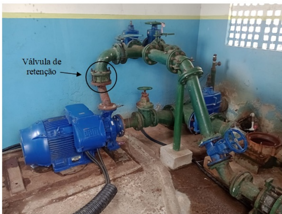
Foto 2 – Conjunto motobomba da EEAT com válvula de retenção
