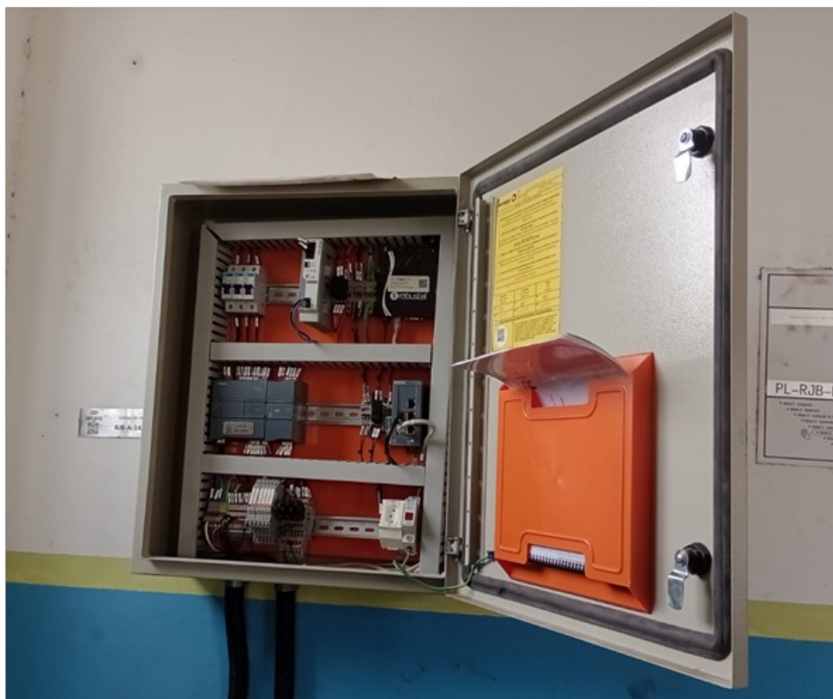
Foto 5 – Interior do painel elétrico
