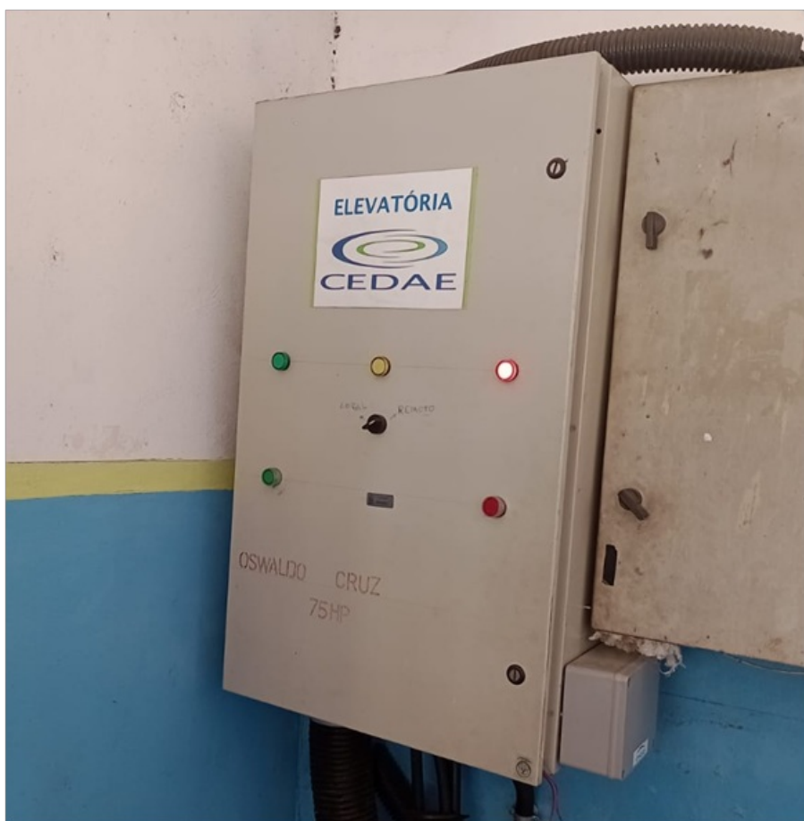
Foto 6 - Painel de automação sem sinalização de risco de choque elétrico
