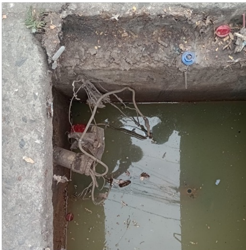
Foto 4 – Abrigo subterrâneo com acúmulo de água
