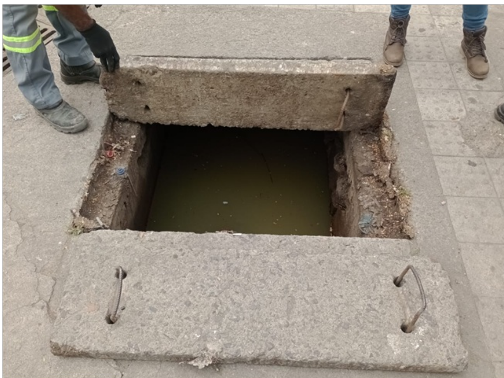
Foto 3 – Abrigo subterrâneo com acúmulo de água
