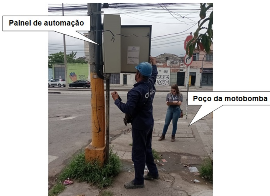
Foto 1 – Localização da EEAT sem identificação
