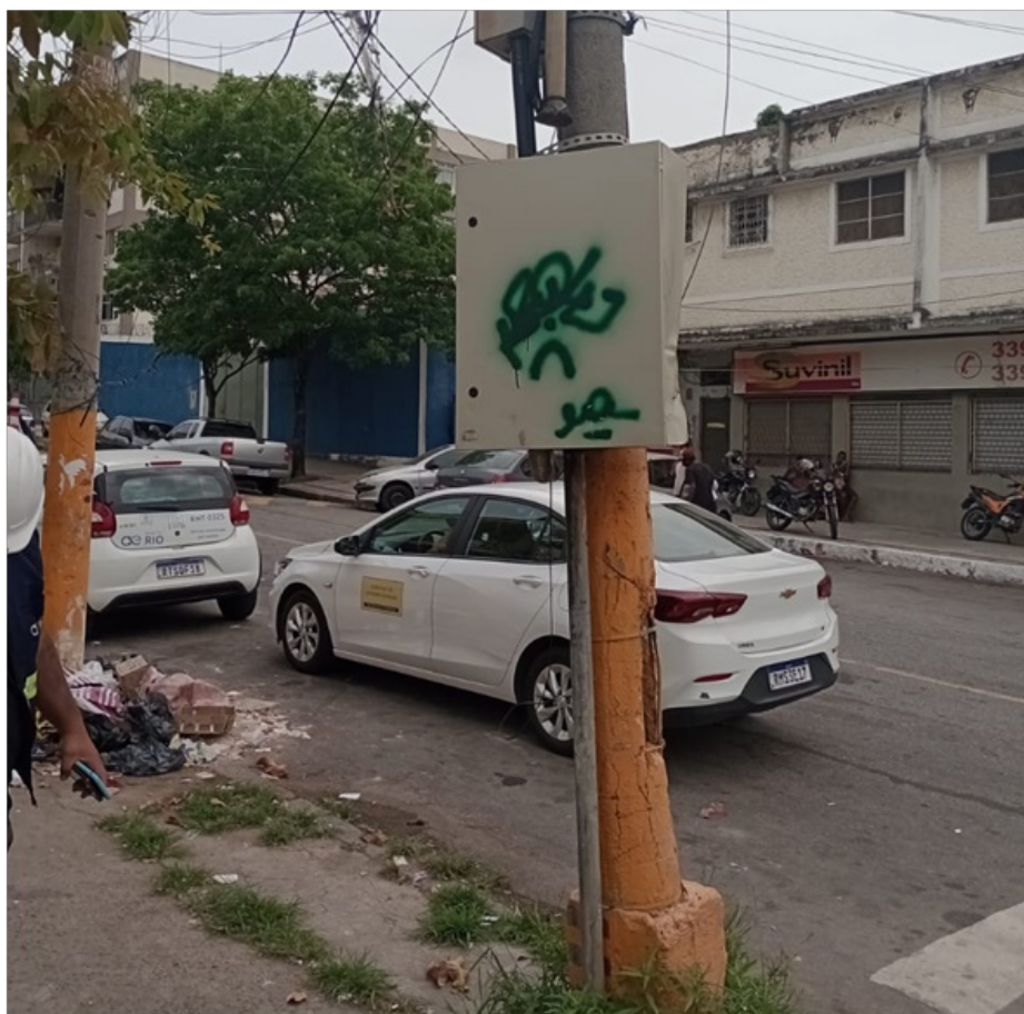
Foto 5 – Painel de automação sem sinalização de risco de choque elétrico
