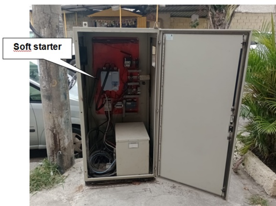
Foto 5 – Painel de automação sem sinalização de risco de choque elétrico
