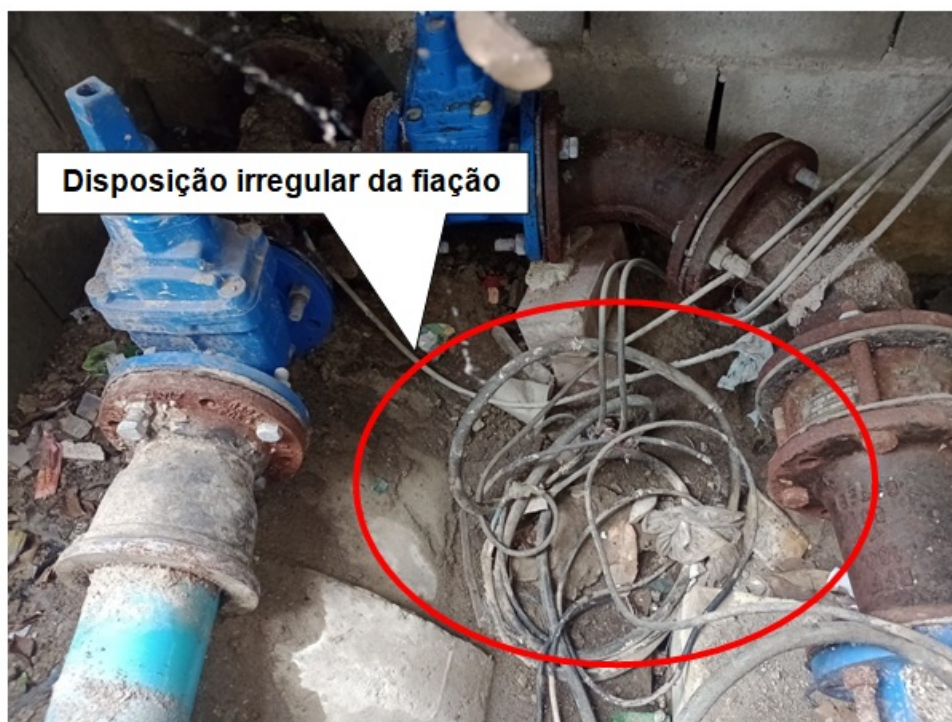
Foto 4 – Interior do abrigo subterrâneo com fiação disposta de maneira irregular
