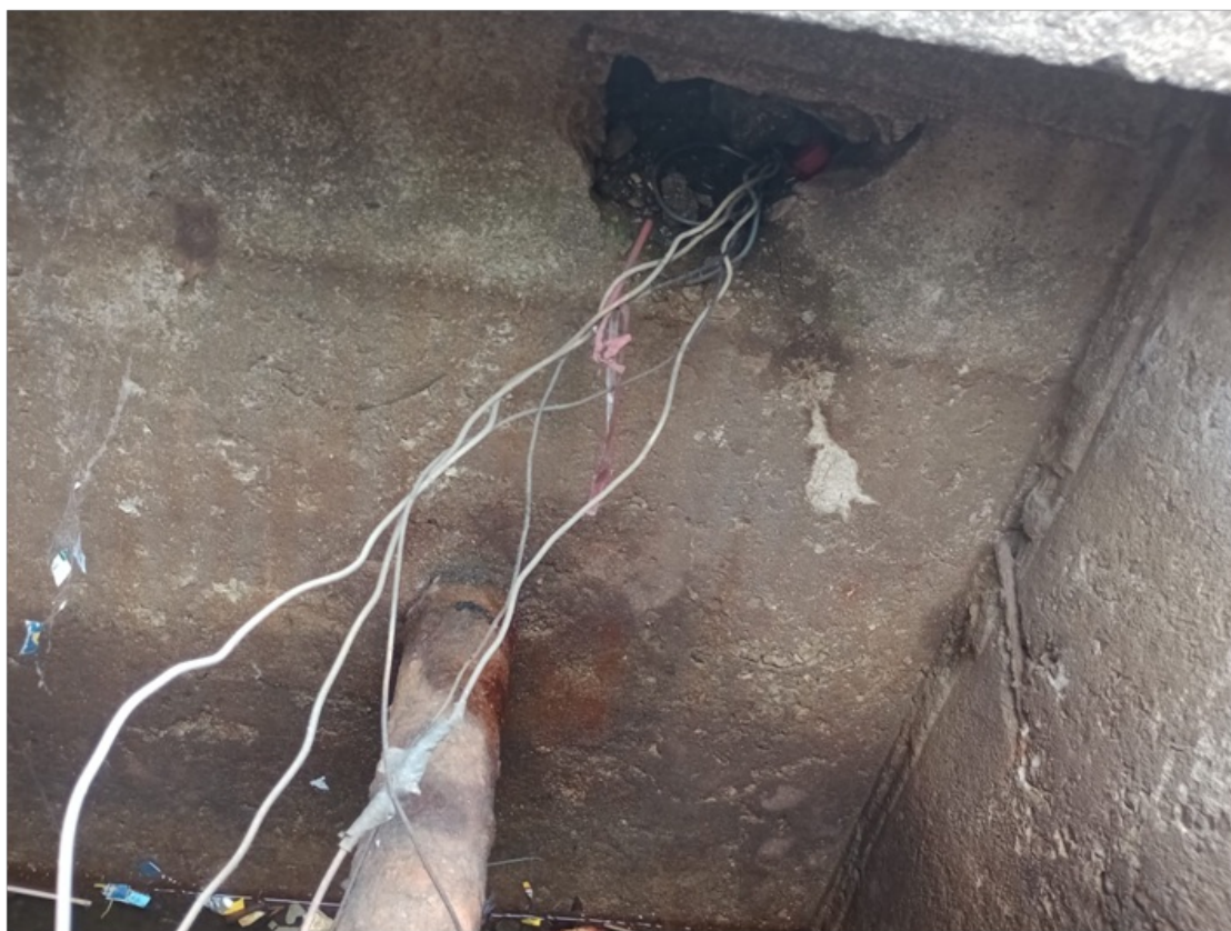
Foto 3 – Fiação disposta de maneira irregular
