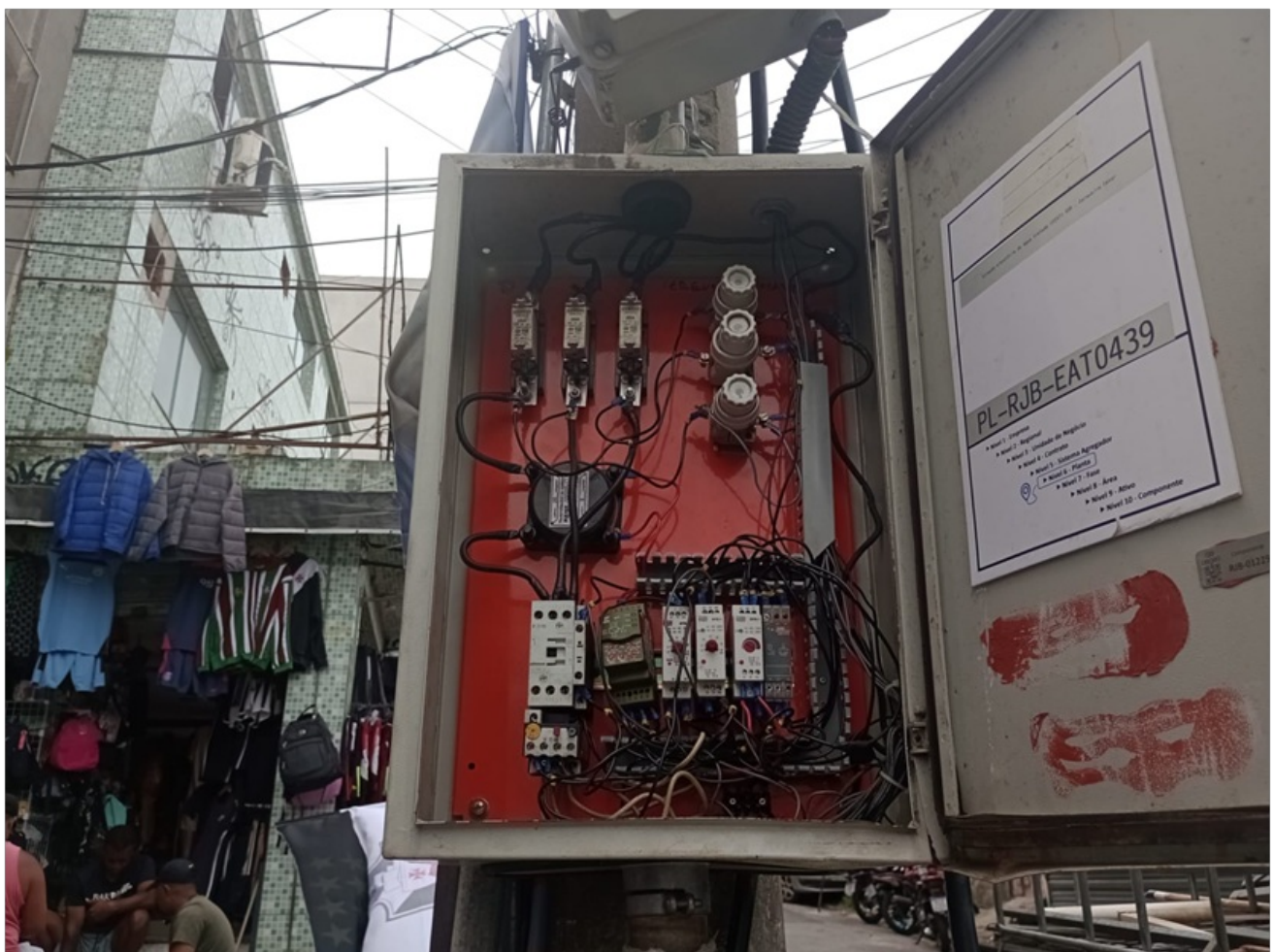
Foto 5 – Interior do pannel de automação
