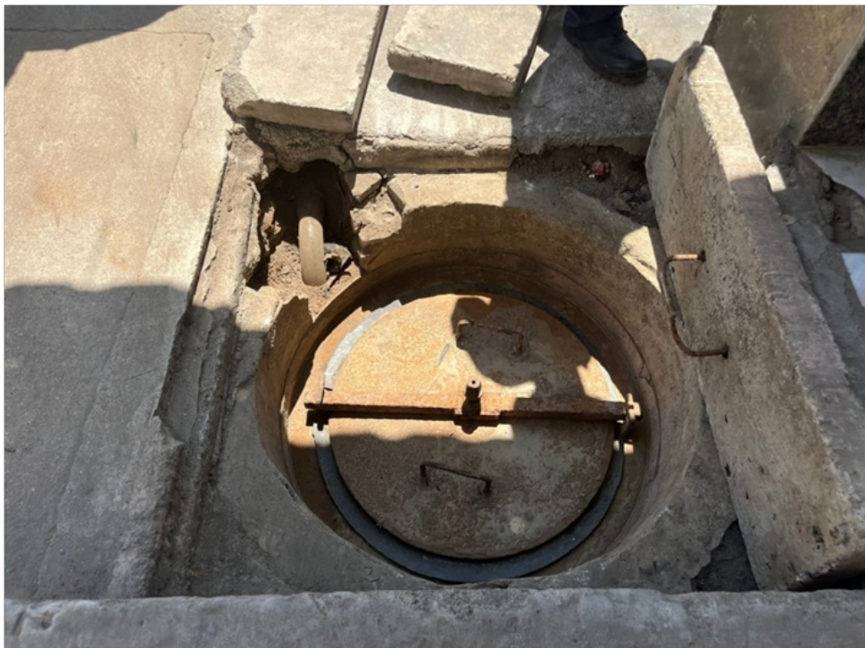
Foto 3 – Tapa de aço do panelão vedada
