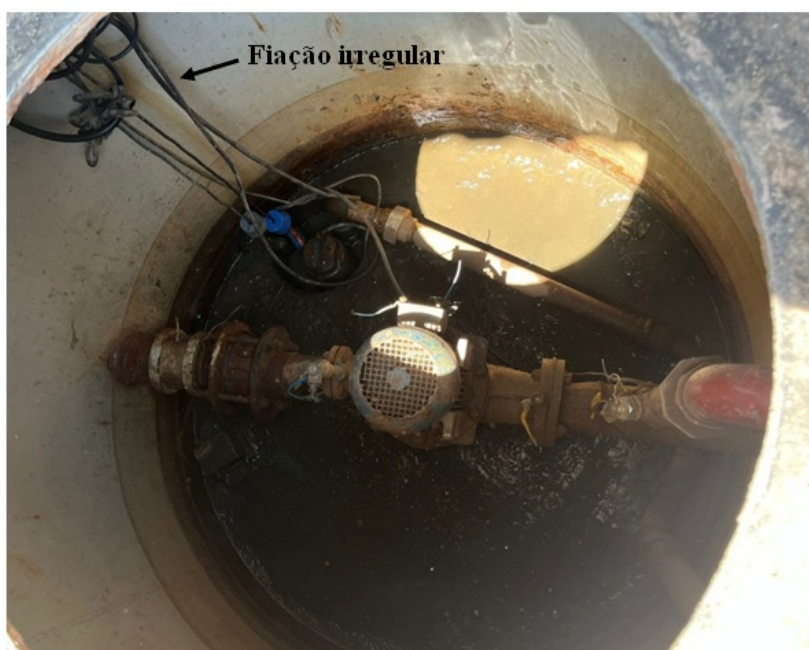
Foto 4 – Conjunto motobomba da EEAT
