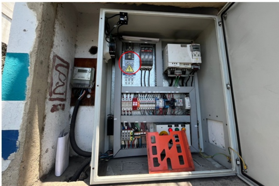
Foto 5 – Vista interna do painel de automação com sinalização de risco de choque elétrico
