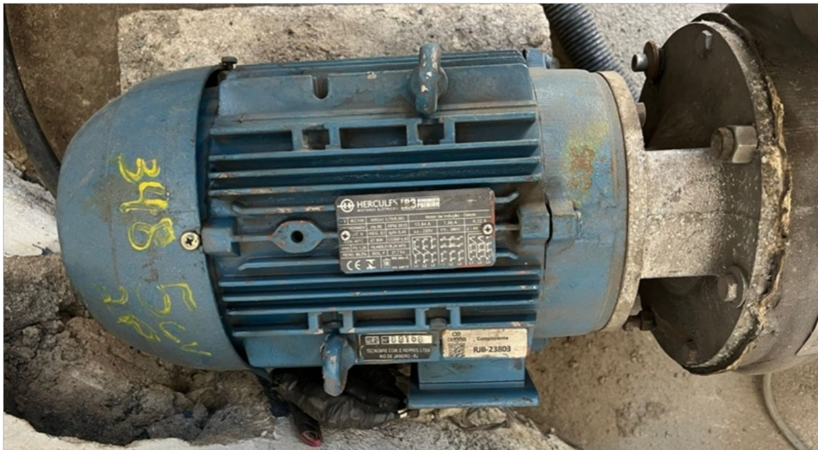
Foto 2 – Conjunto motobomba da EEAT do tipo centrífuga
