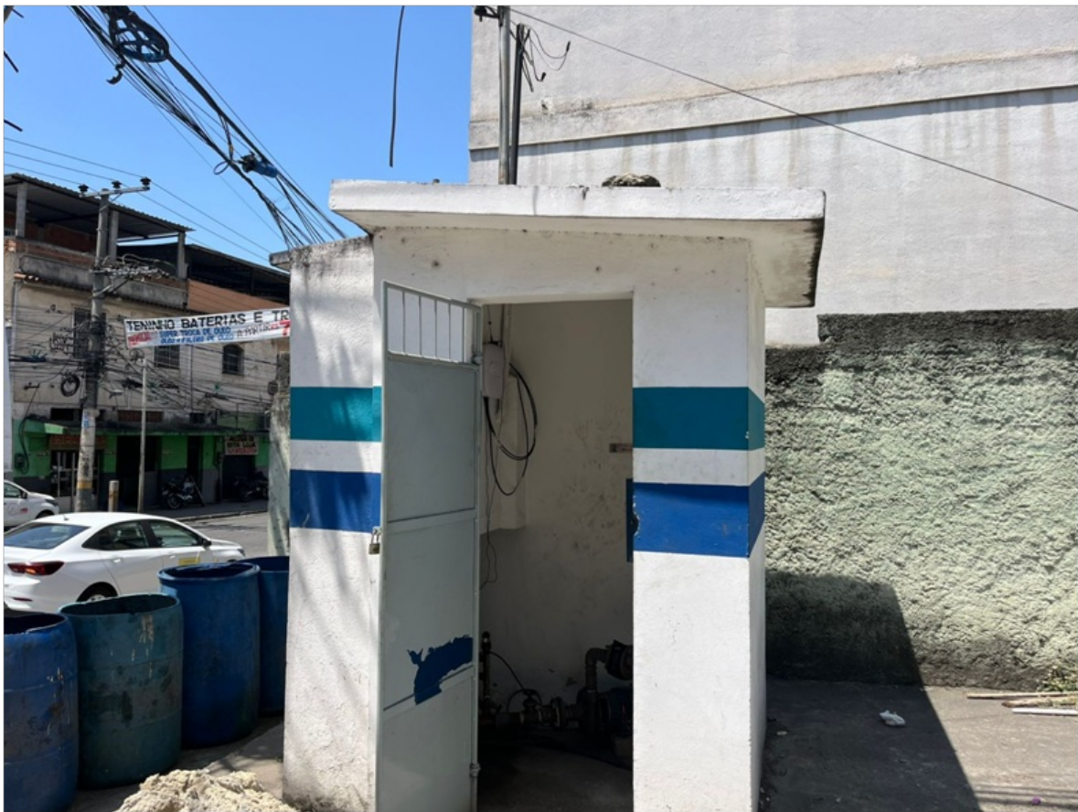
Foto 1– Localização da EEAT sem identificação
