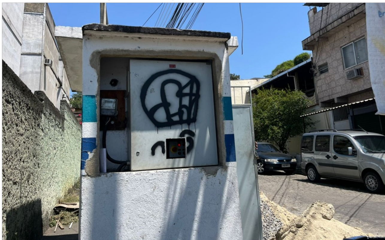
Foto 4 – Abrigo do painel de automação
