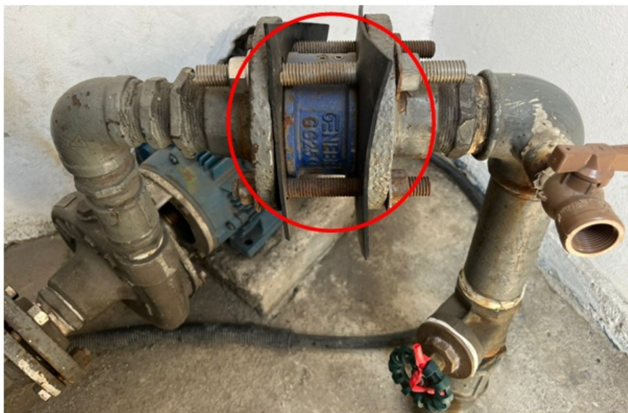
Foto 3 – Válvula de retenção da motobomba
