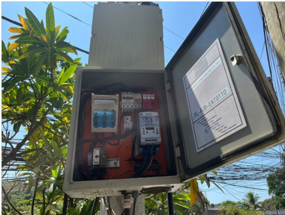
Foto 3 – Painel de automação, sem sinalização de risco de choque elétrico
