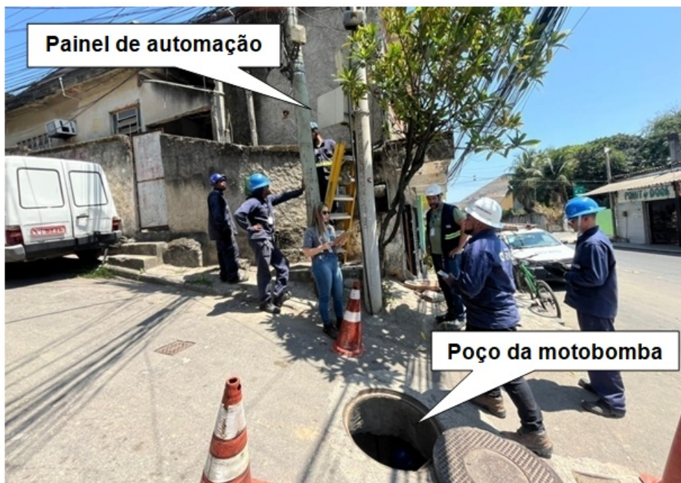
Foto 1 – Localização da EEAT sem identificação
