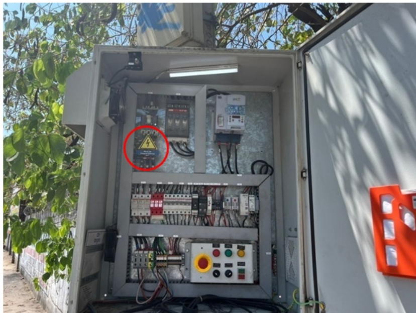
Foto 5 – Painele de automação com sinalização de risco de choque elétrico apenas na parte interna
