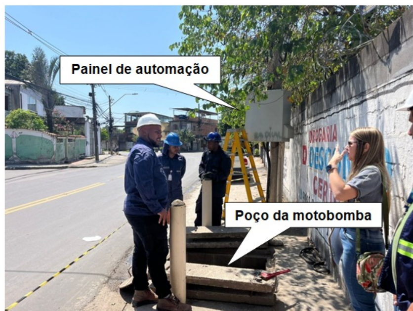
Foto 1– Localização da EEAT sem identificação
