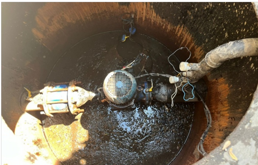
Foto 4 – Conjunto motobomba da EEAT
