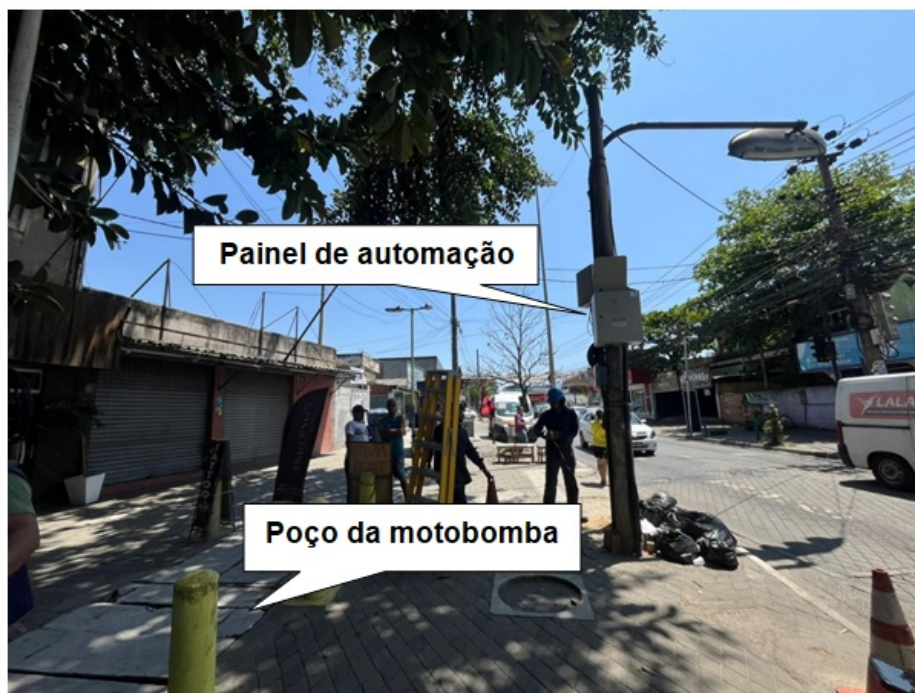
Foto 1 – Localização da EEAT sem identificação
