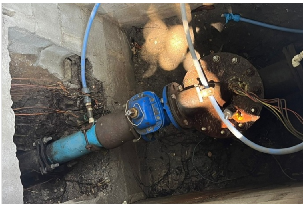
Foto 4 – Entrada da tubulação da motobomba submersa
