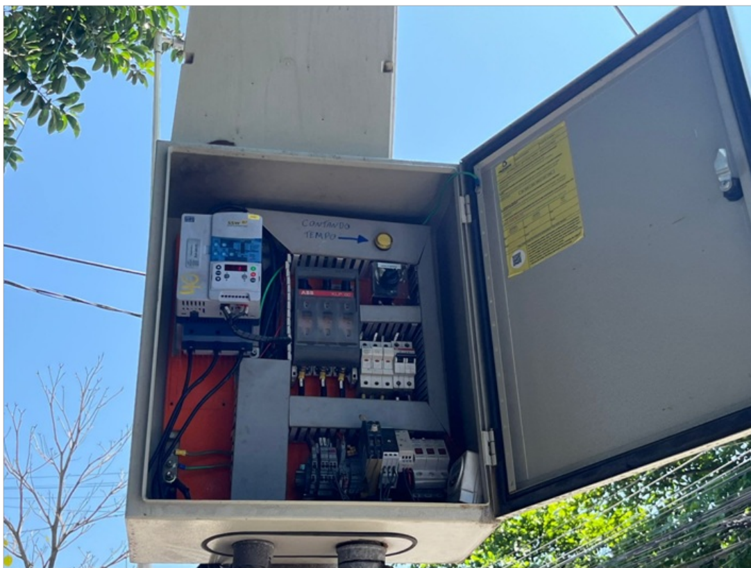
Foto 5 – Pannel de automação com sinalização de risco de choque elétrico na parte externa
