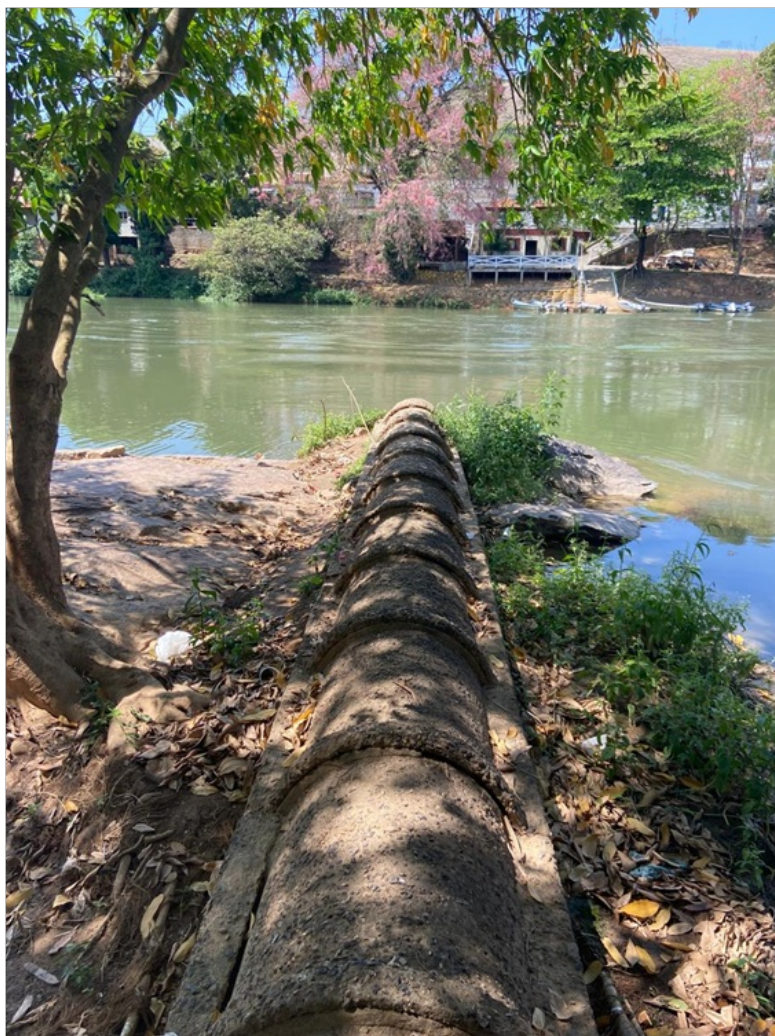
Foto 04 – Tubulação da rede pluvial (drenagem) por onde é feito o lançamento do esgoto in natura, no Rio Paraíba do Sul.
