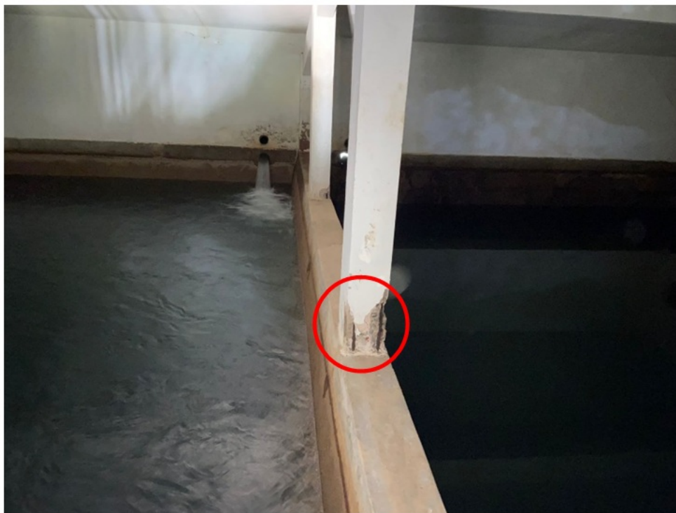
Foto 6 - Coluna estrutural com desgaste
