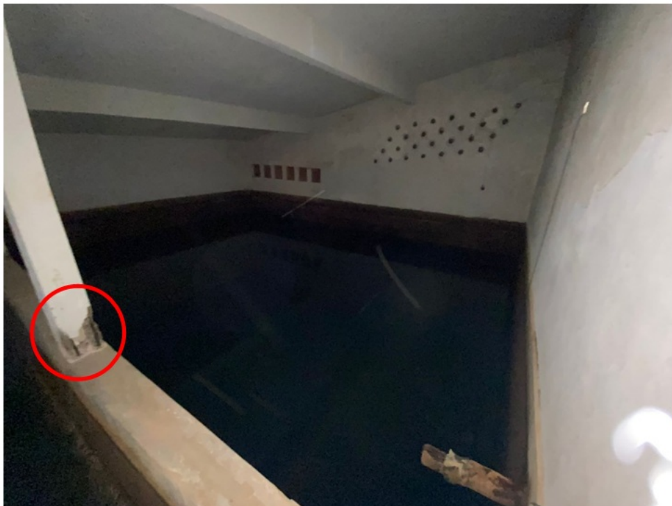
Foto 7 – Interno Reservatório Central 2 com coluna estrutural com desgaste
