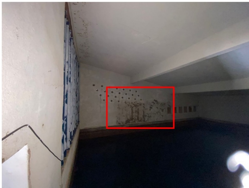
Foto 8 - Interno Reservatório Central 2 com falta de manutenção (impermeabilização)
