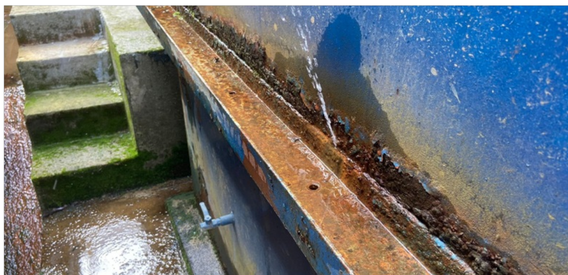
Foto 19 Corrosão acentuada na lateral do módulo da ETA
