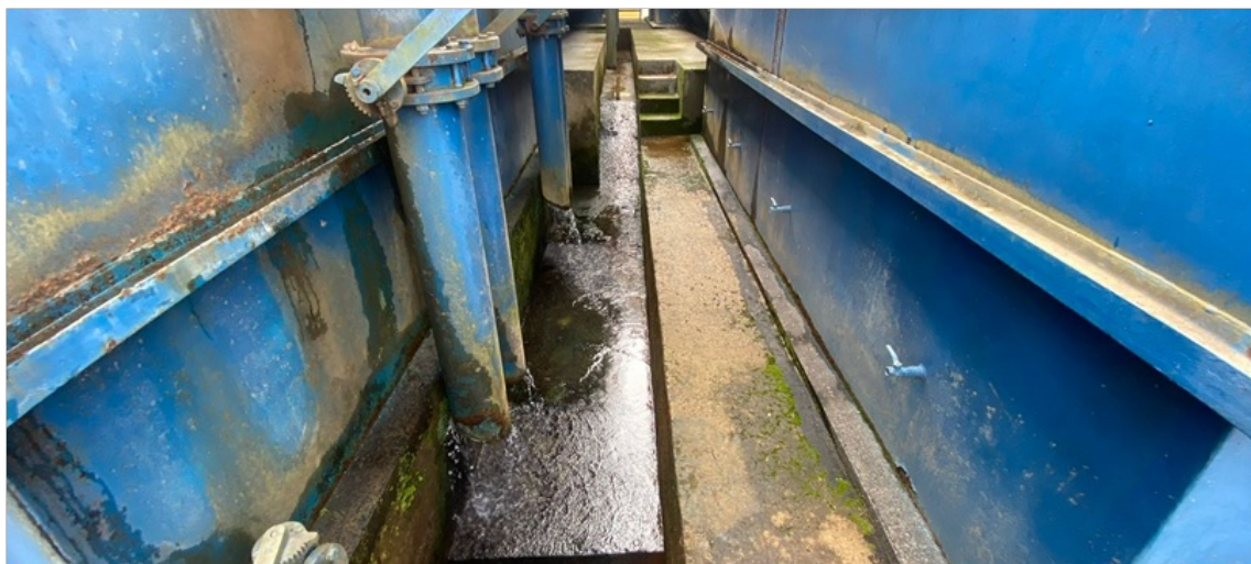
Foto 20 Válvulas com passagem/vazamentos de água
