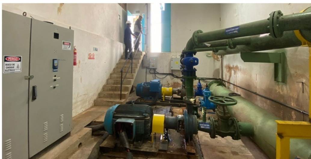
Foto 12 Sala de Motores Elevatória de Água Tratada Fragoso
