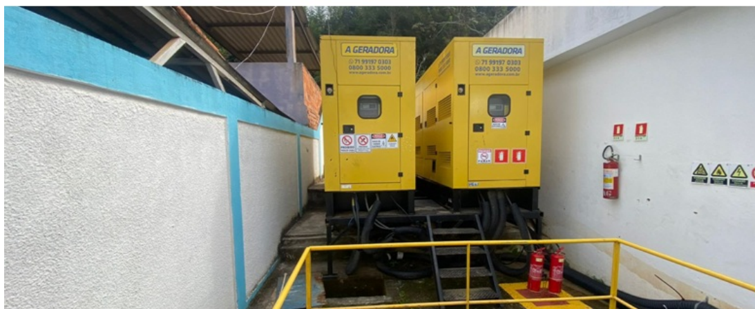
Foto 22 Geradores de energia
