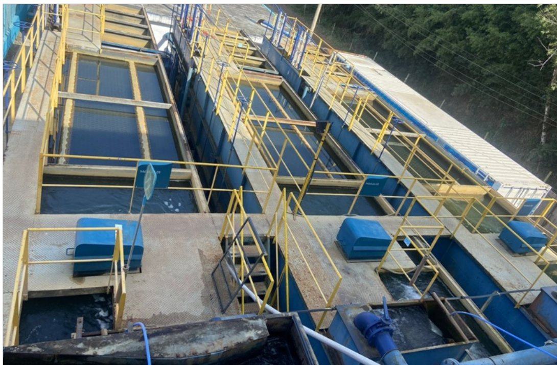
Foto 2 Módulos da estação metálica, ETA móvel
