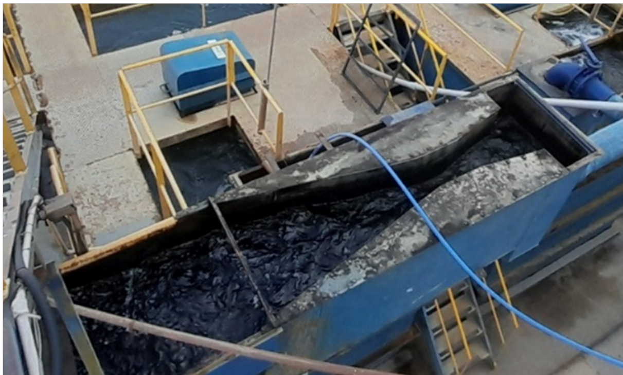
Foto 4 Calha Parshall chegada de água bruta
