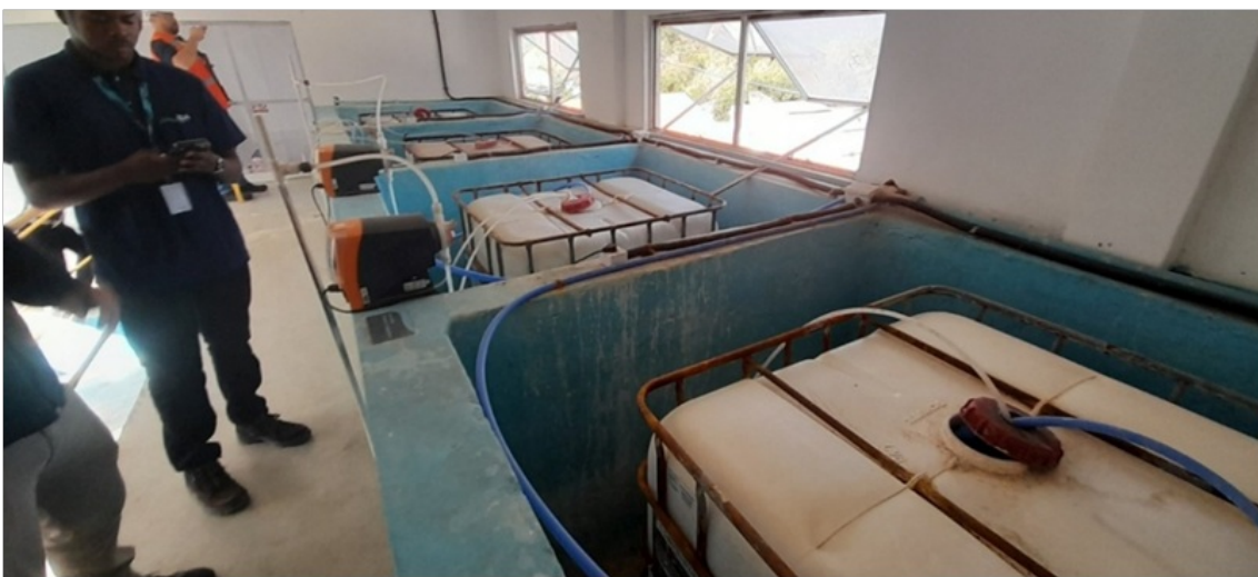
Foto 7 Bombas Dosadoras, IBC's de produtos químicos
