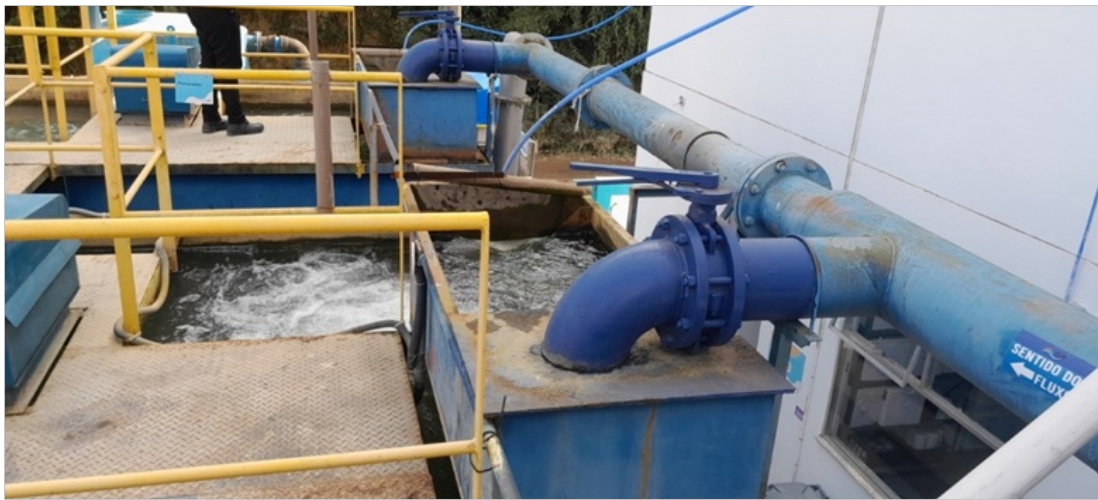
Foto 3 Adutora de D 400mm Água Bruta
