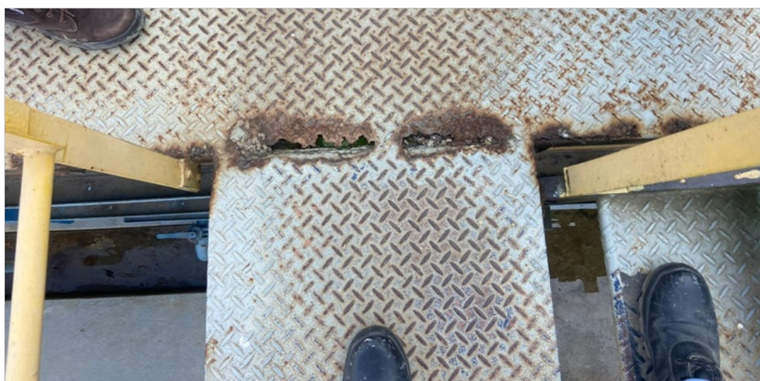
Foto 18 Corrosão acentuada na passarela
