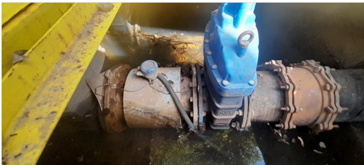
Foto 5 – Válvula chegada da água e macromedidor
