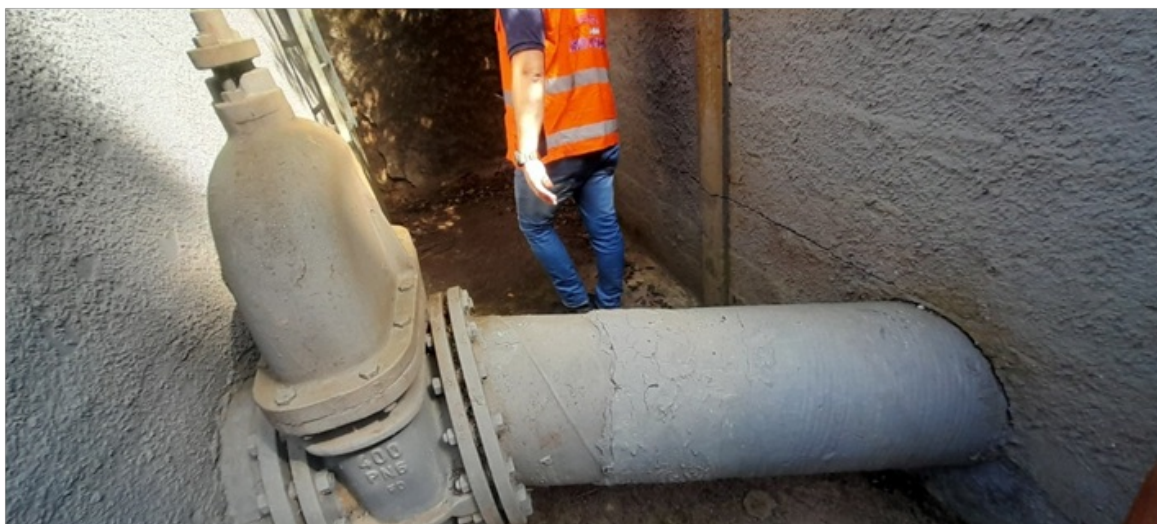
Foto 3 – Caixa de passagem
