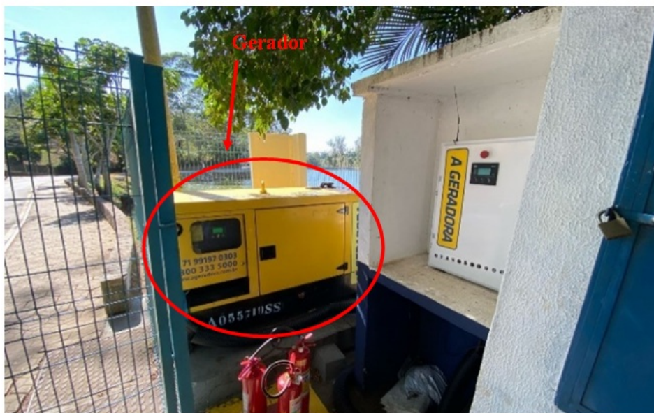
Foto 3 - Gerador de energia elétrica
