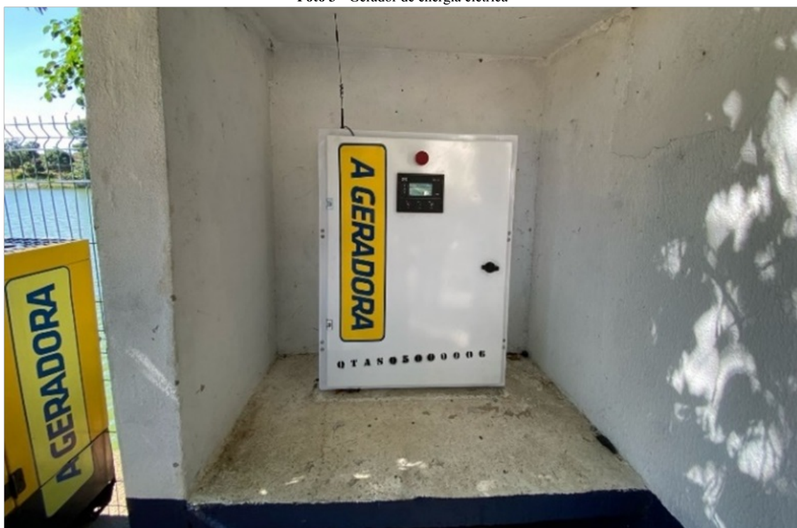
Foto 4 - Paineis de comandos elétricos
