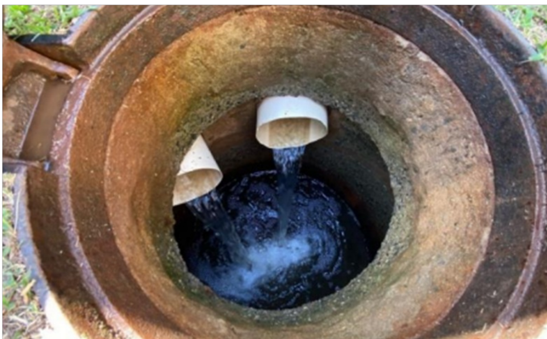
Foto 13 – Poço de visita
