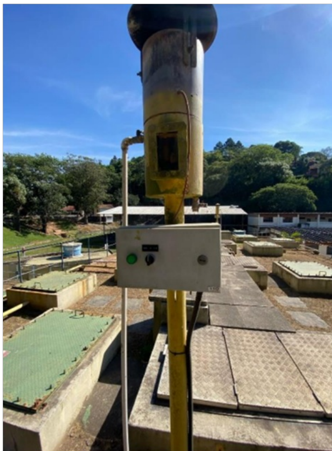
Foto 11 – Queimador de gases
