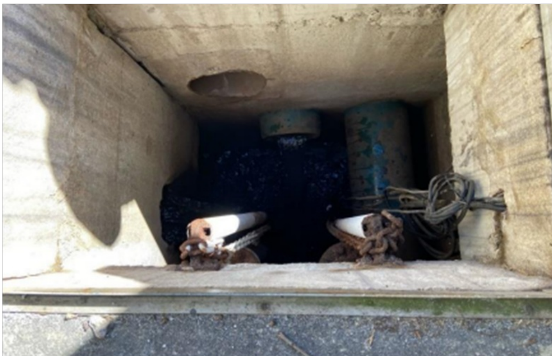
Foto 9 – Caixa de distribuição
