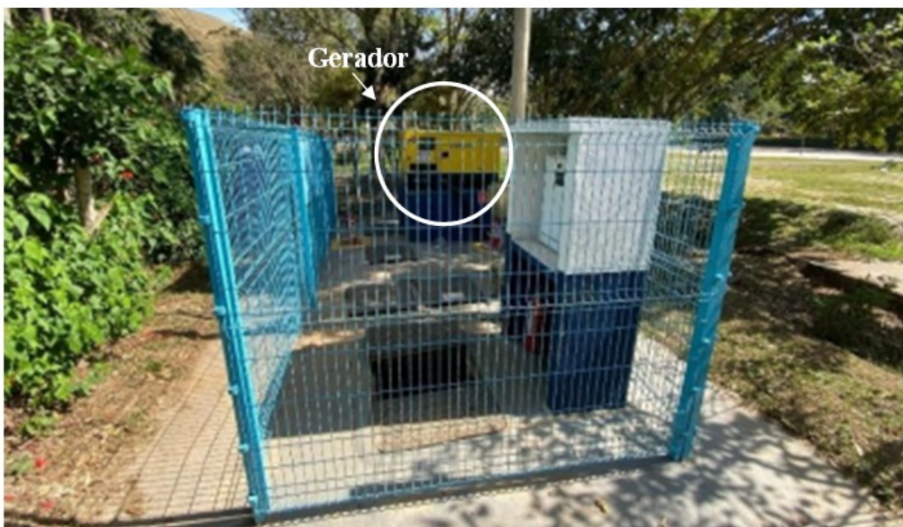
Foto 3 – Gerador de energia elétrica
