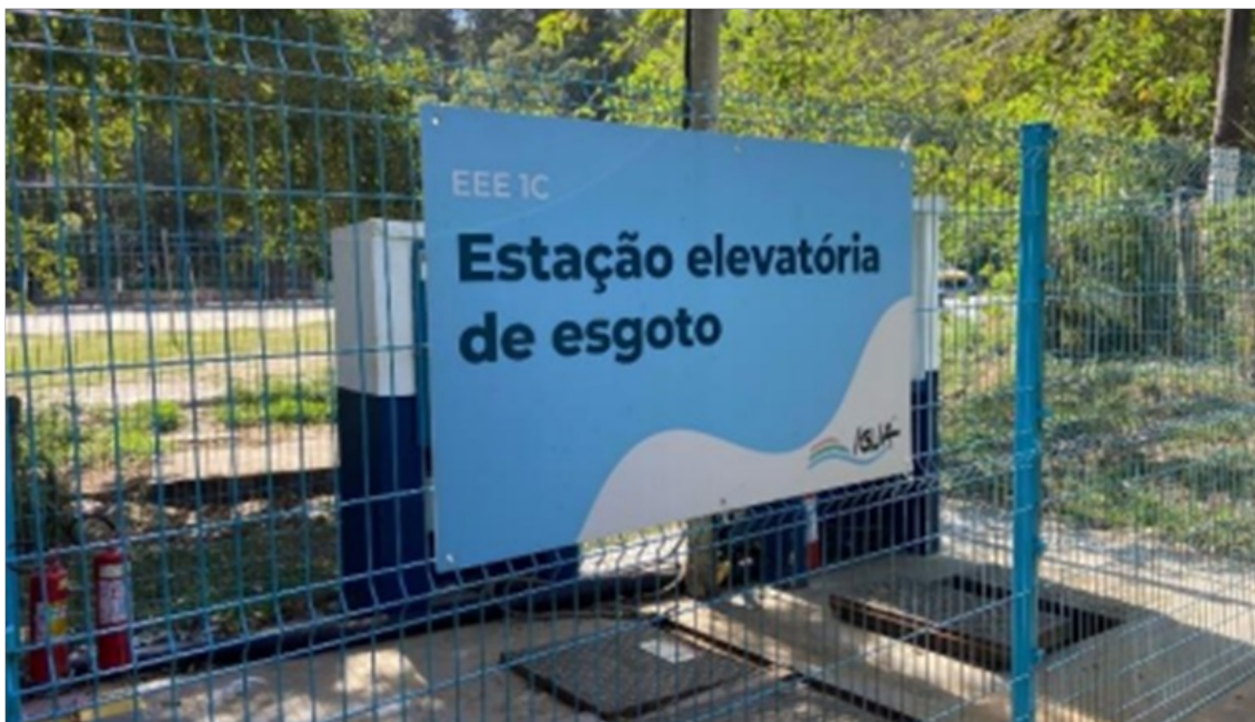
Foto 1 – Cerca da EEEB
