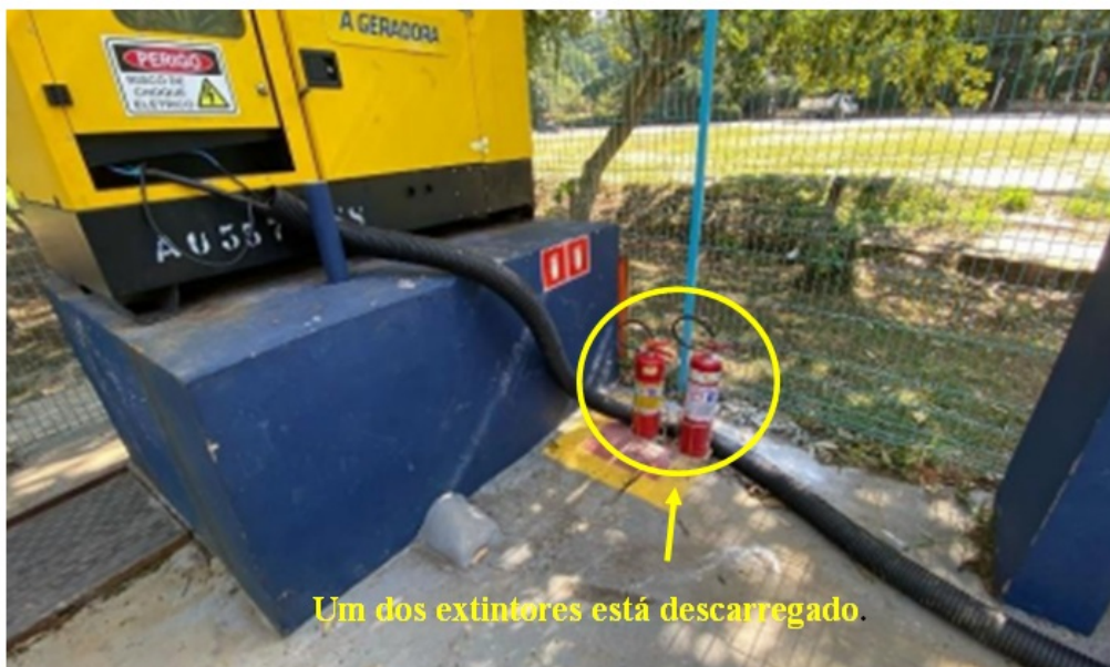
Foto 5 – Extintores de incêndio
