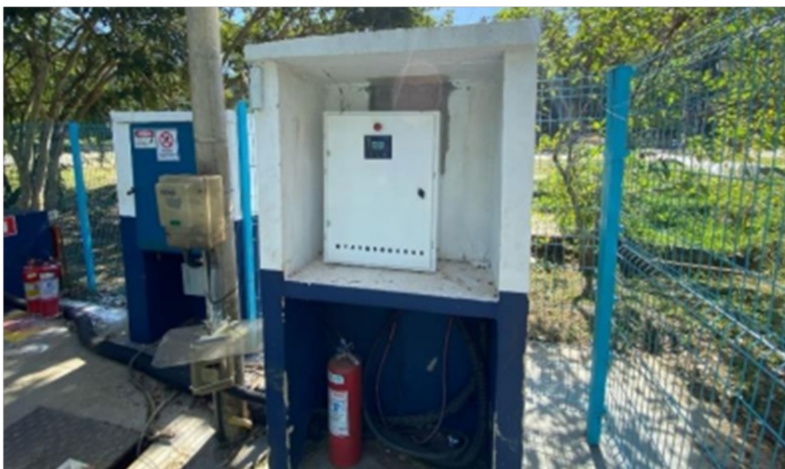
Foto 4 – Painel de comandos elétricos
