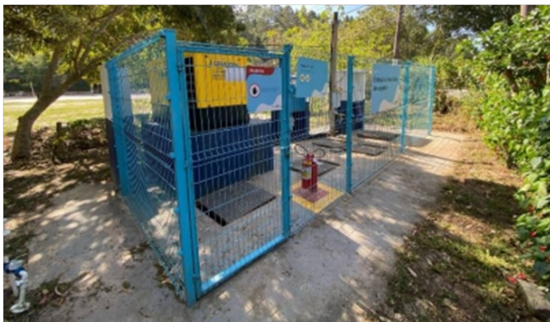
Foto 2 – Cerca da EEEB
