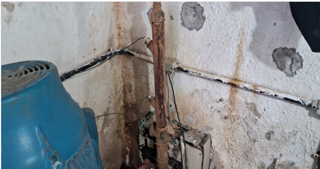
Foto 15 – Torre de eletrodos deteriorada
