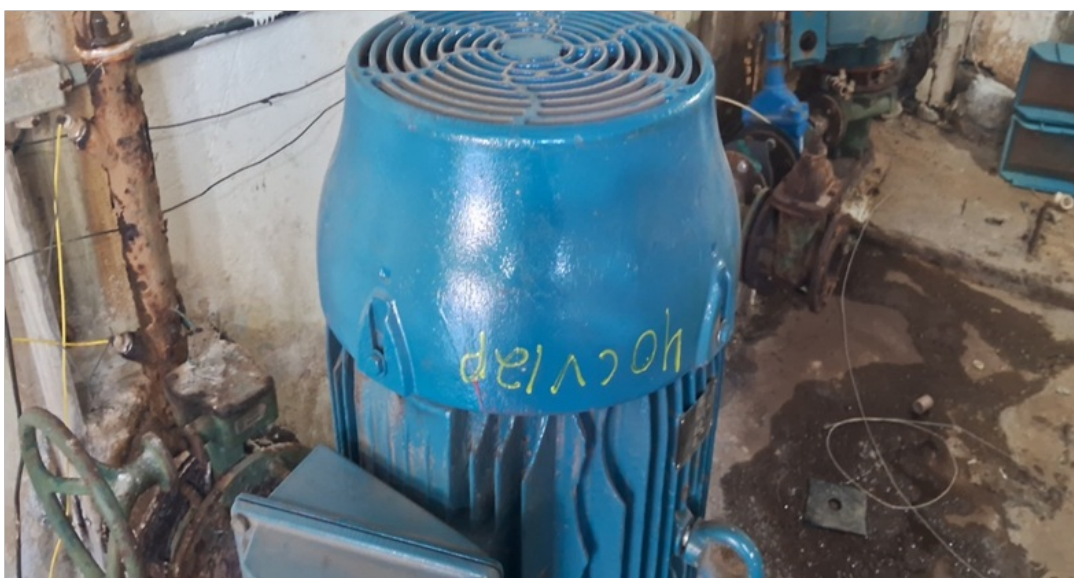
Foto 11 – Conjunto motobomba de 40 CV
