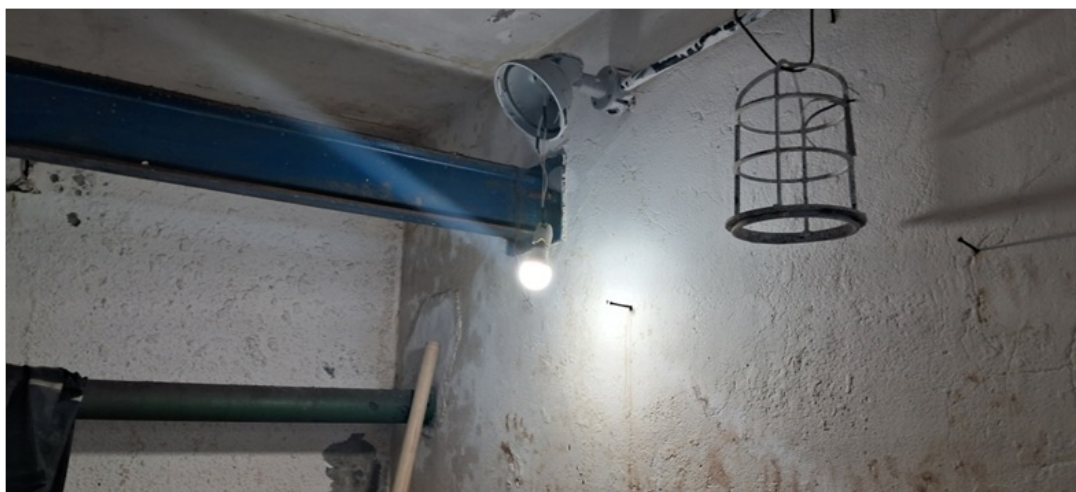
Foto 19 – Iluminação sem proteção
