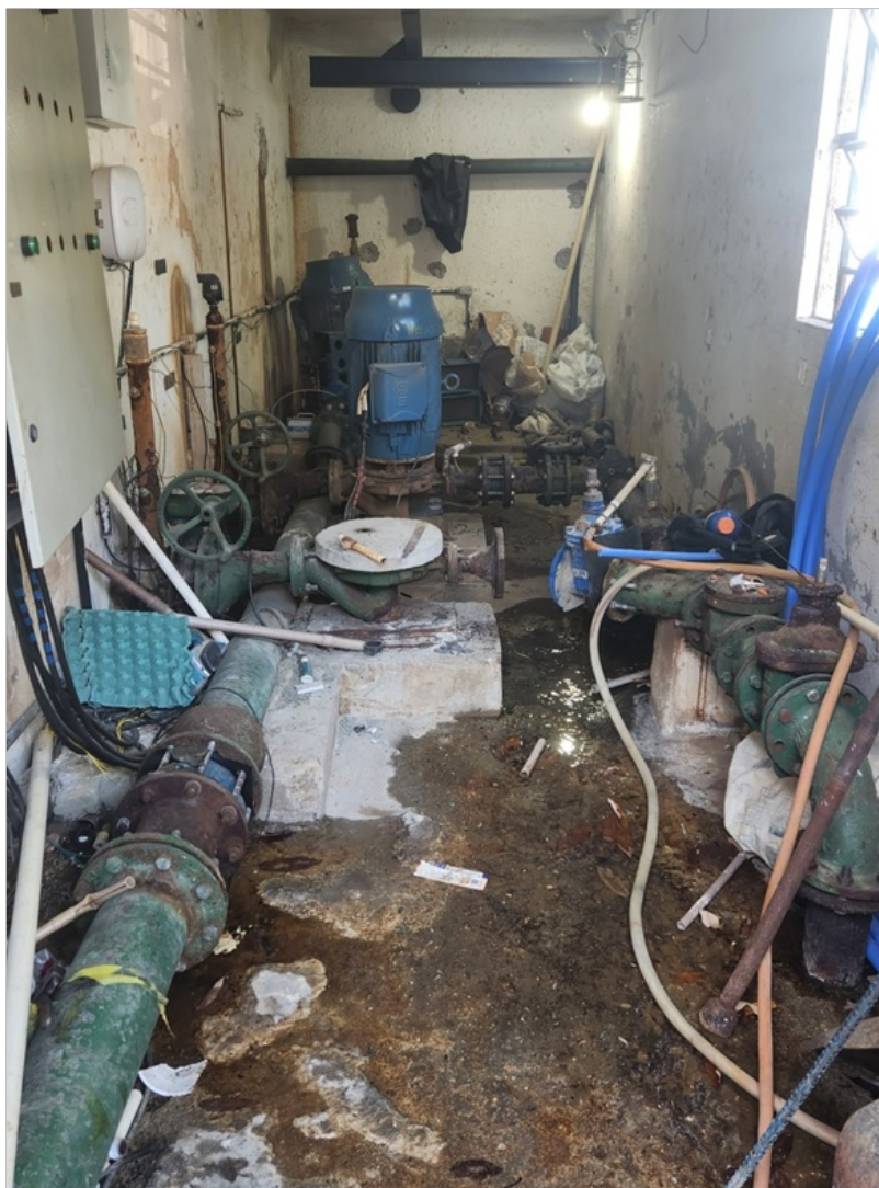
Foto 18 – Lixo no interior do abrigo
