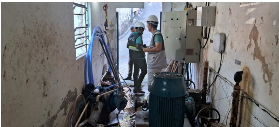
Foto 22 – Fiação desprotegida e vazamento
