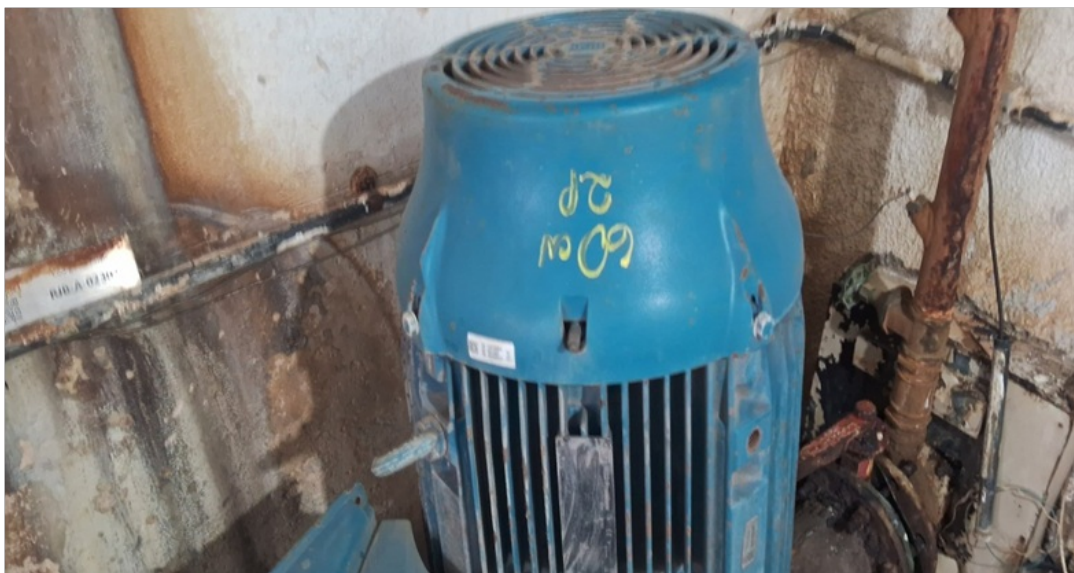
Foto 10 – Conjunto motobomba de 60 CV
