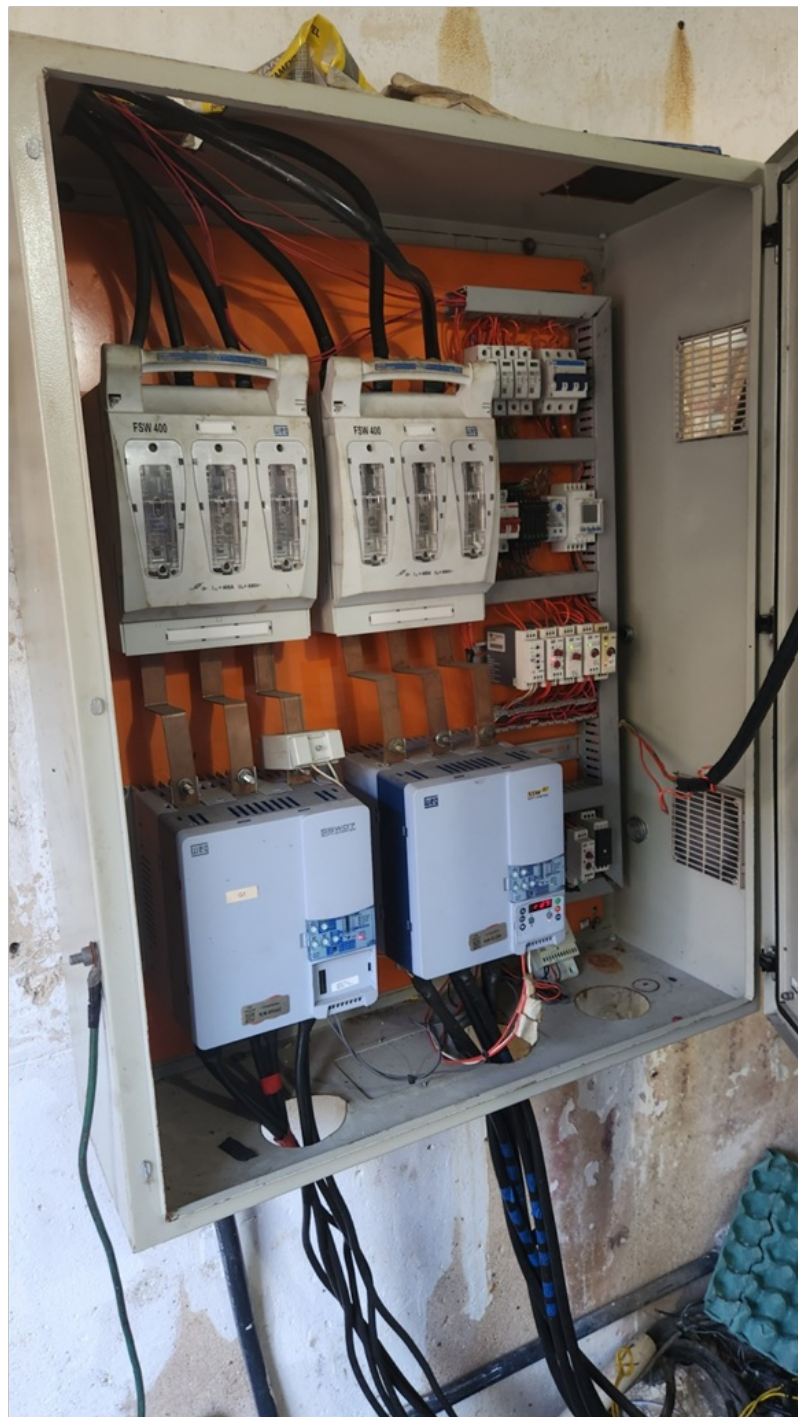
Foto 24 – Painel das elevatórias
