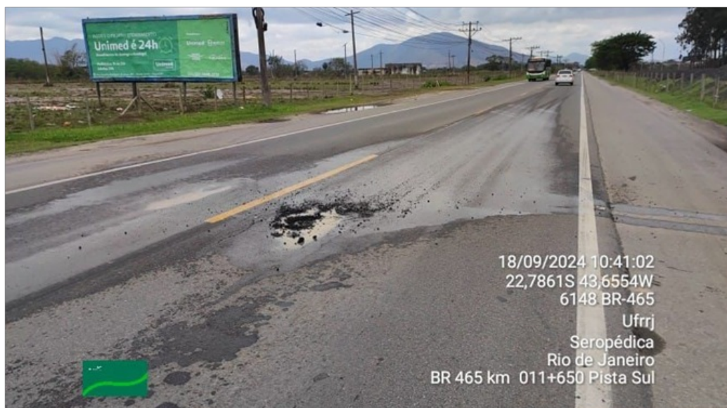
Foto 1- Identificação do vazamento no asfalto da BR – 465
