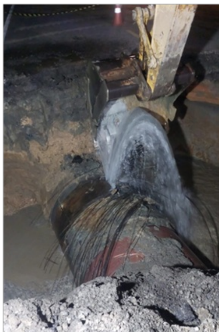
Foto 2 - Ponto do vazamento localizado na 2ª ARL
