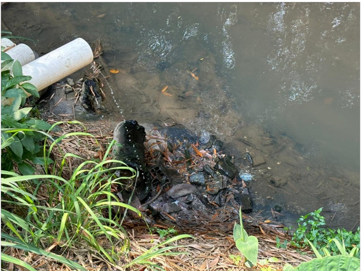
Foto 04 – Lançamento de esgoto in natura no córrego do Lucas em frente ao nº 106
