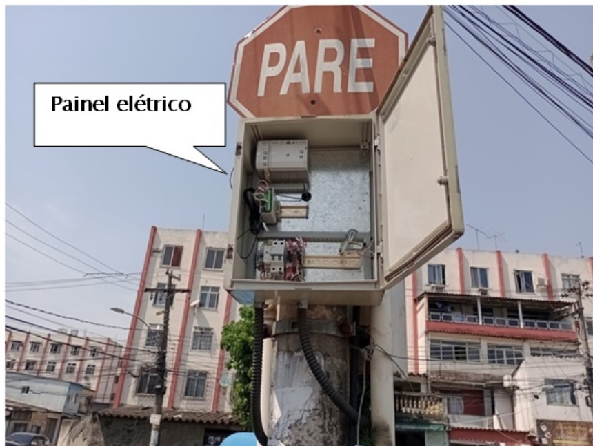
Foto 5 – Painel elétrico da EEAT
