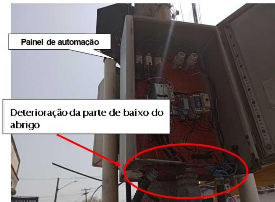
Foto 6– Abrigo do painel de automação deteriorado na parte de baixo
