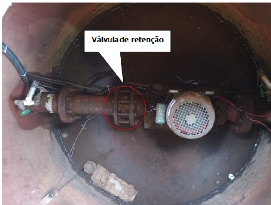
Foto 4 – Conjunto motobomba da EEAT
