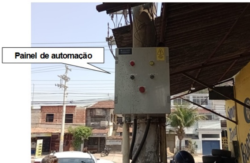
Foto 6 – Painel de automação
