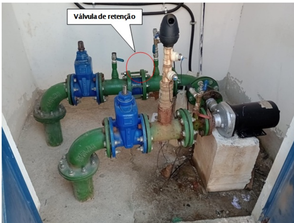
Foto 2 – Conjunto motobomba da EEAT e seus equipamentos
