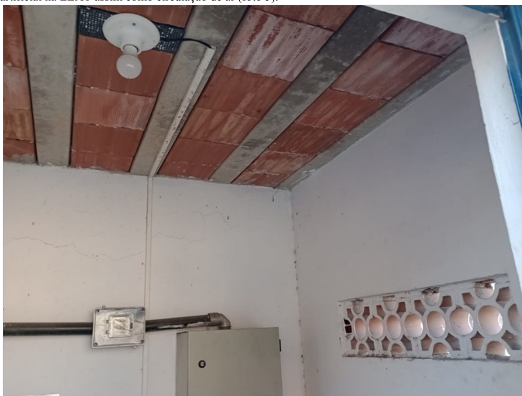
Foto 5 – Interior do abrigo da EEAT com iluminação artificial e entrada para ventilação.
