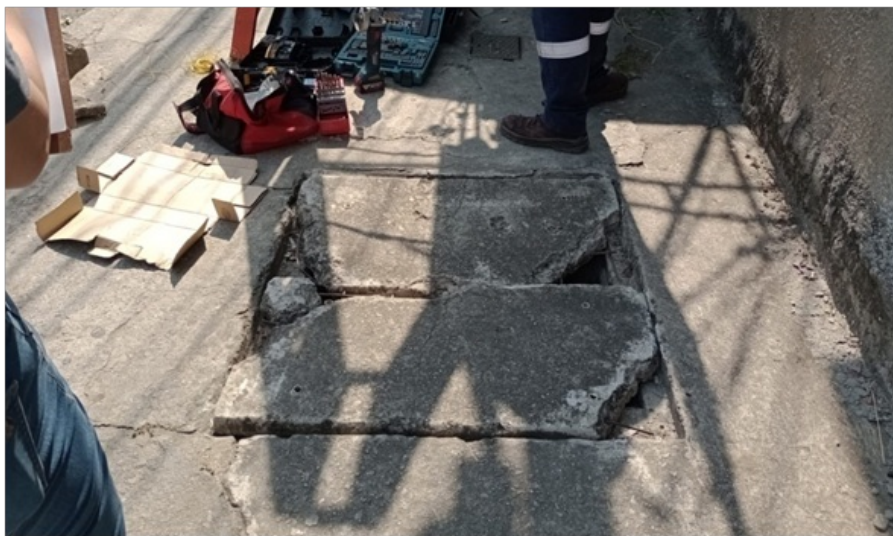
Foto 2 - Tampa de concreto quebrada
