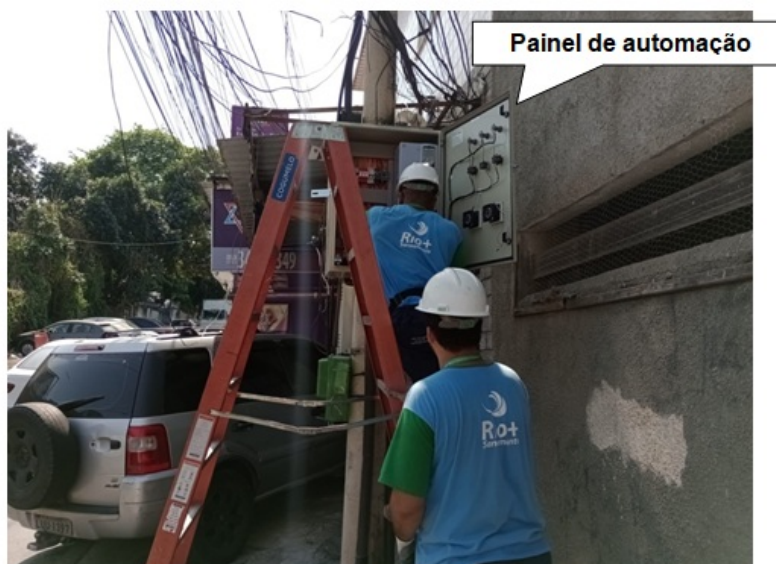
Foto 5 – Painel de automação
