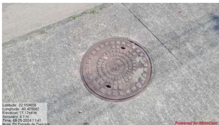
Fig. 11. - Poço de Visita no início da Estrada de Curicica (próximo a passarela).
