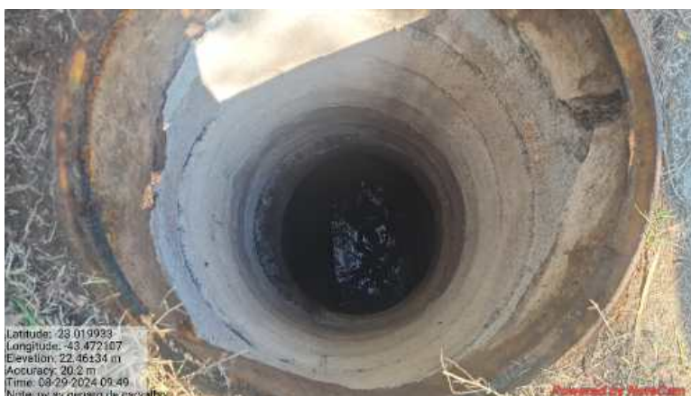
Fig. 4. - Poço de Visita de rede coletora DN150 na esquina da Av. Genaro de Carvalho
