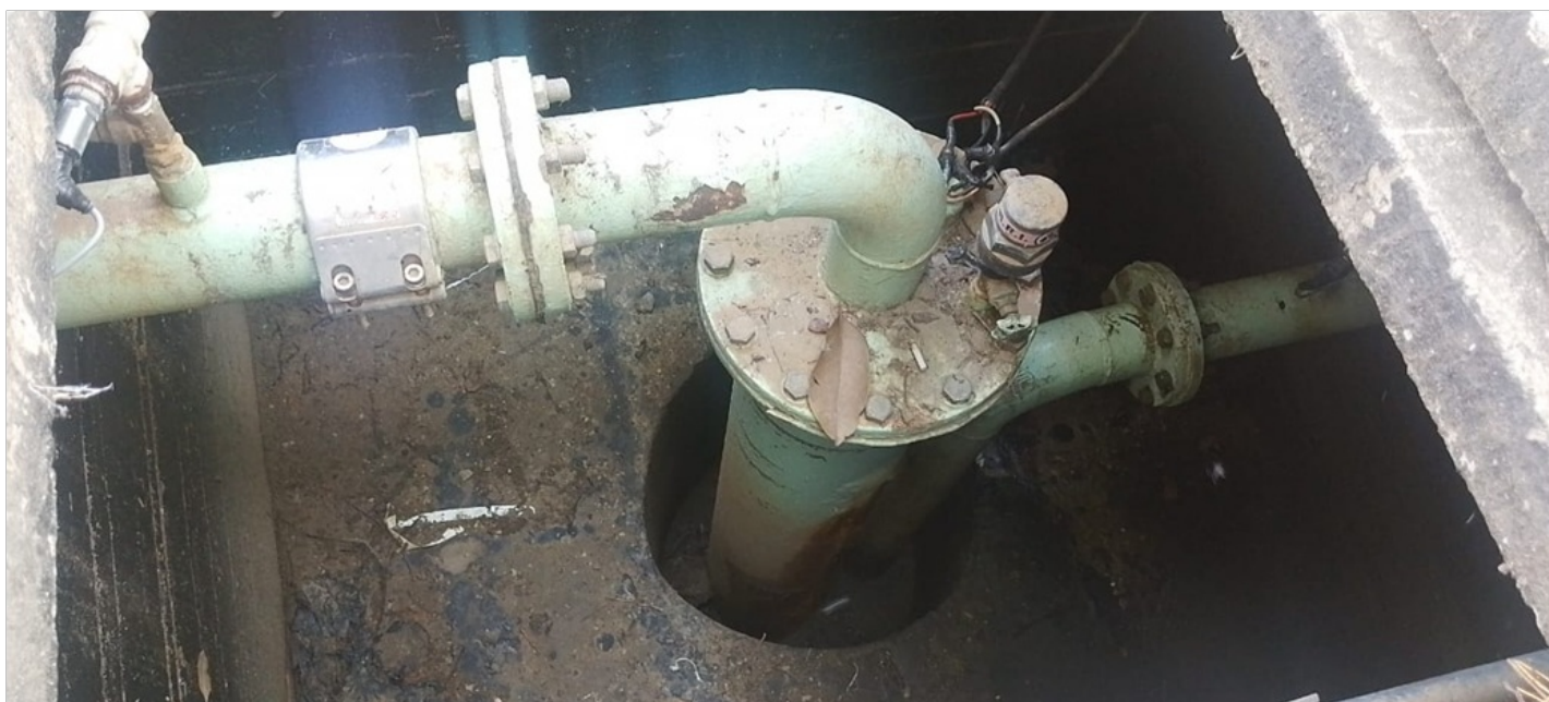
Foto 03 – Motobomba do tipo Submersa.
