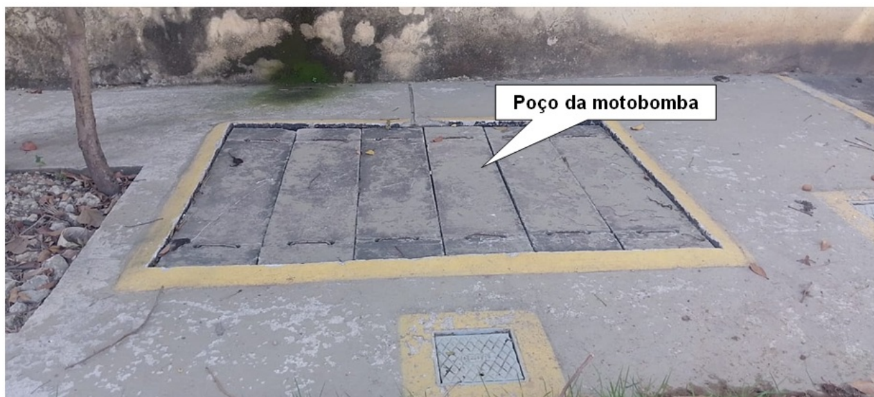
Foto 02 – Tampa de concreto do poço da motobomba
