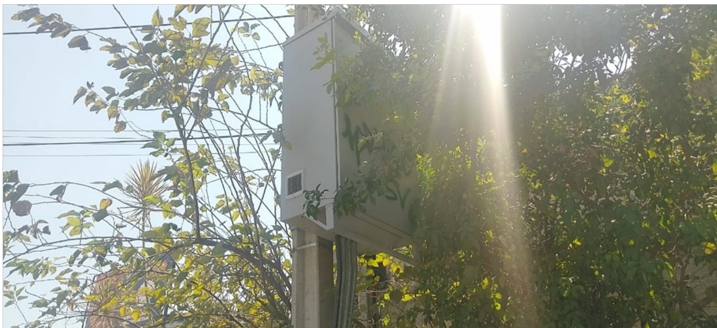
Foto 01 Abrigos dos painéis da EEAT.
