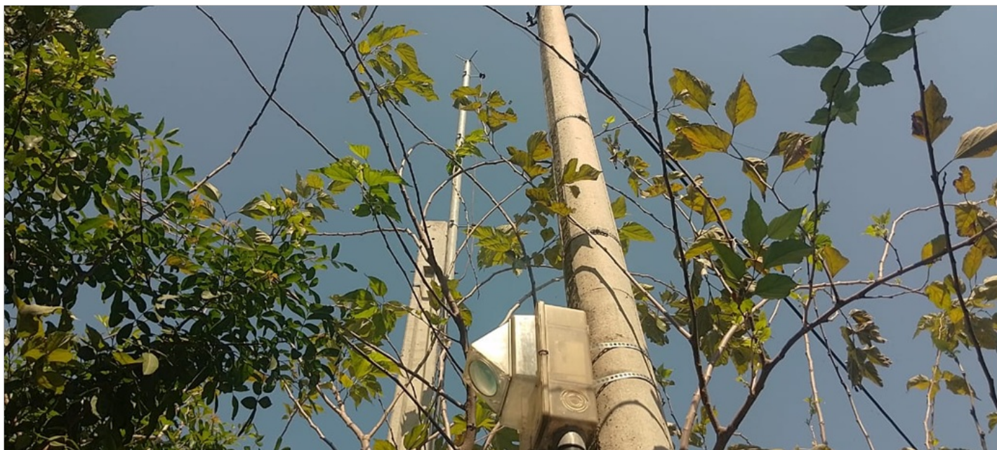
Foto 04 – Sistema de proteção contra descargas atmosféricas.
