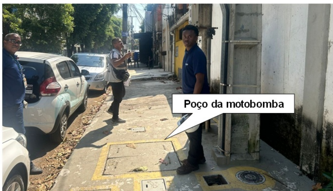
Foto 2 – Tampa de concreto do poço da motobomba
