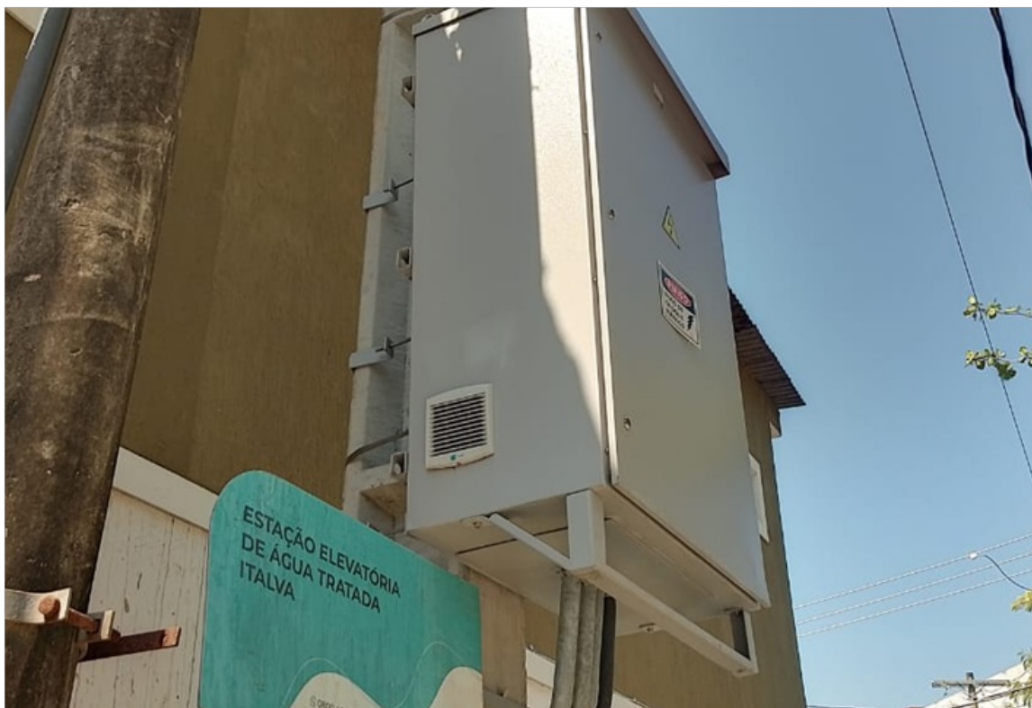
Foto 1 – Identificação da EEAT André Rocha
