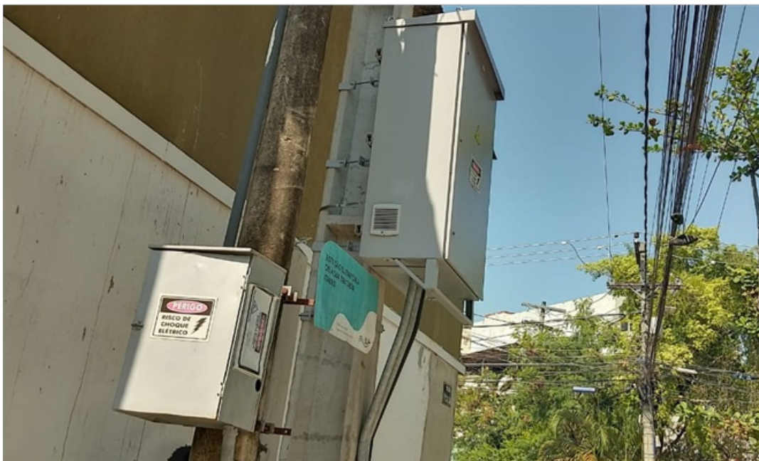
Foto 5 – Abrigos dos painéis da EEAT
