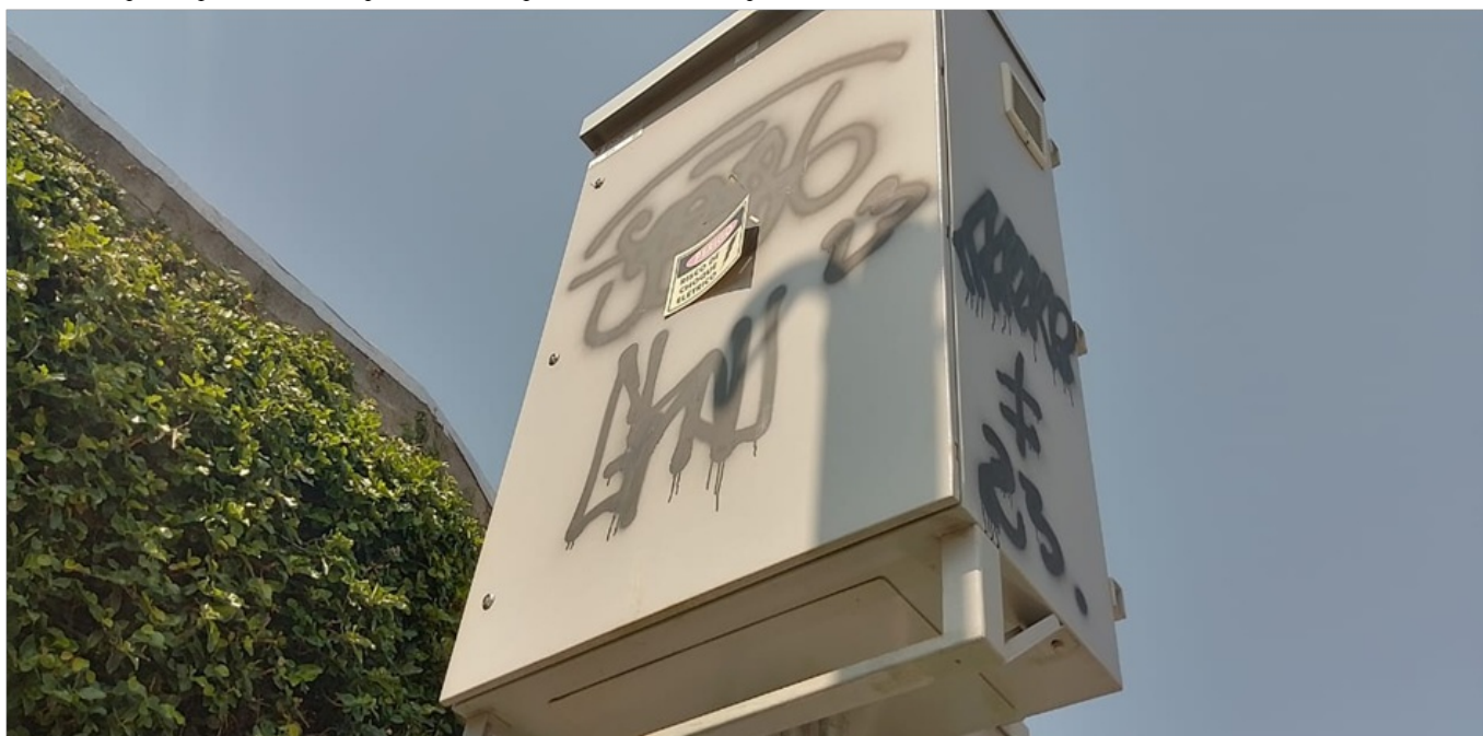
Foto 05 – Abrigos dos painéis da EEAT.
