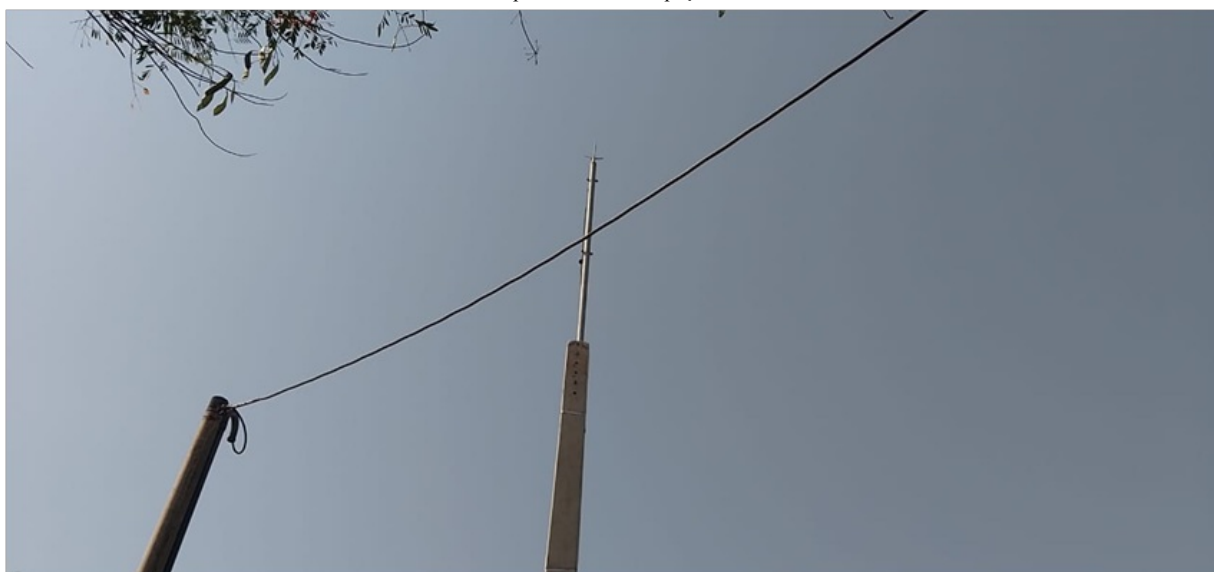
Foto 03 – Sistema de proteção contra descargas atmosféricas.
