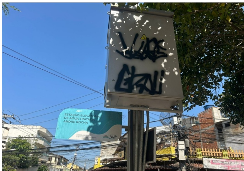
Foto 1 – Identificação da EEAT André Rocha
