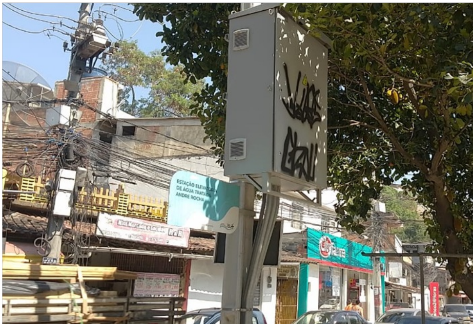
Foto 5 – Abrigo do painel de automação da EEAT
