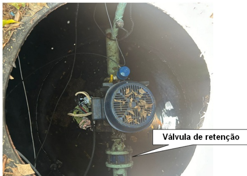
Foto 4 – Motobomba do tipo centrífuga “in line”
