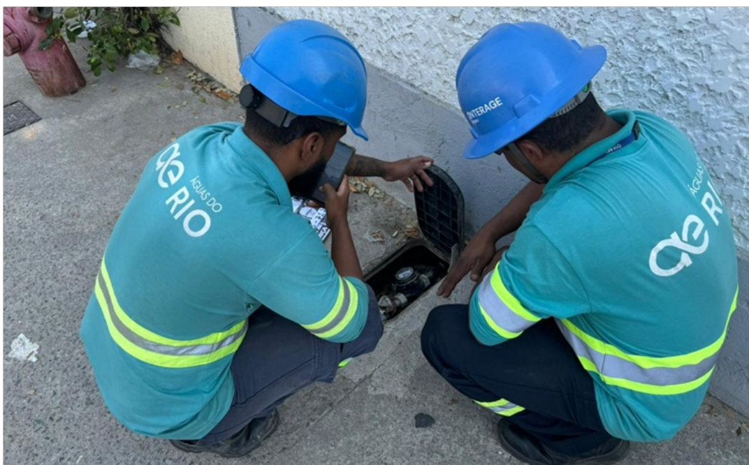
Foto 8 – Hidrômetro instalado no passeio público
