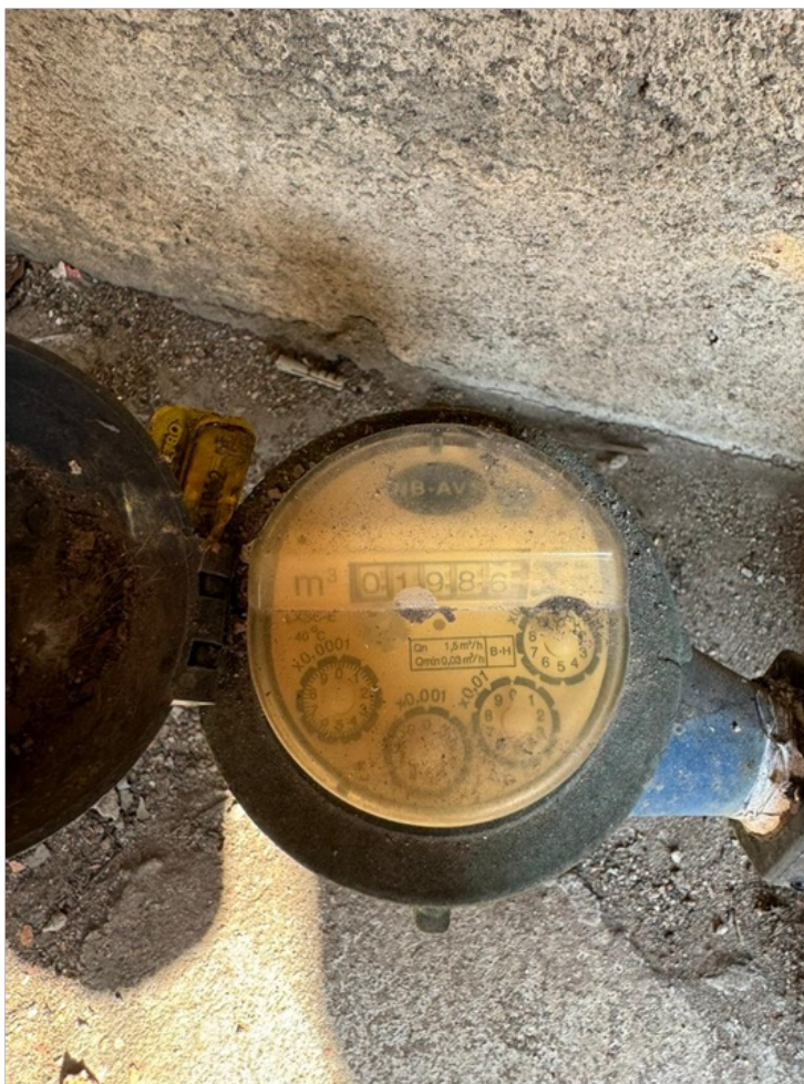
Foto 9 – Hidrômetro instalado no interior do imóvel
