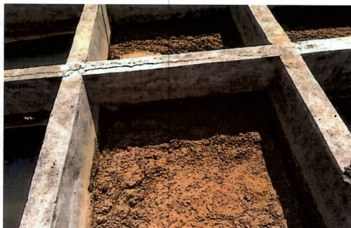
Foto 43: Material flotado nos floculadores da NETA.
