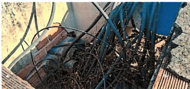
Foto 26: Caixa de passagem dos condutores elétricos que saem da subestação. Nota-se condutores expostos ao tempo, desorganizados e resíduos acumulados no interior da caixa.
