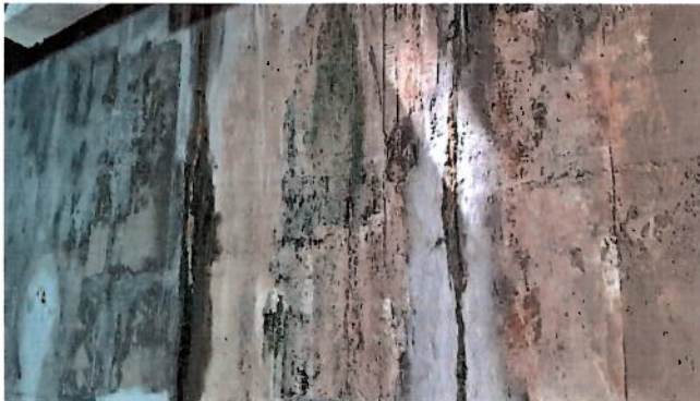
Foto 52: Infiltrações nas paredes dos decantadores da NETA. Área passou por reforma parcial.
