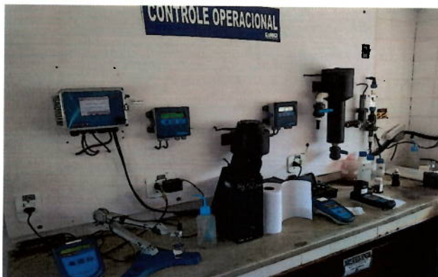
Foto 94: Sala de controle operacional - bancada.
