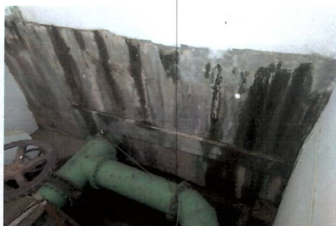
Foto 57: Casa de válvulas do filtro 6 com presença de infiltrações na parede do filtro, vazamento e corrosão nas tubulações.
