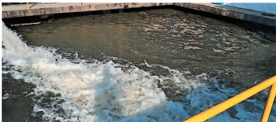
Foto 11: Vista superior do poço de sucção, destaca-se extravasamento.
