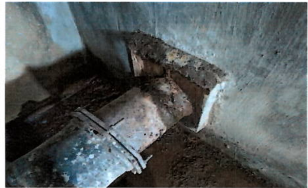
Foto 53: Ponto com vazamento no barrilete de descarga dos decantadores da NETA.
