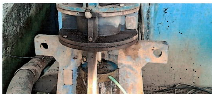
Foto 6: CMB apresenta vazamento.
