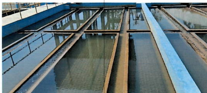
Foto 47: Vista de montante para jusante dos decantadores da VETA no trecho de alta taxa.
