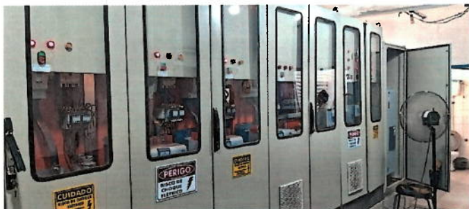
Foto 17: Sala dos painéis elétricos
