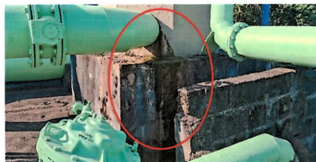
Foto 22: Área com vazamento no TAU.
