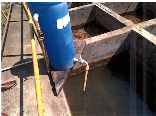
Foto 44: Ponto de aplicação de polímero nos floculadores da NETA. Nota-se que a bombona está apoiada em base que não está fixada.
