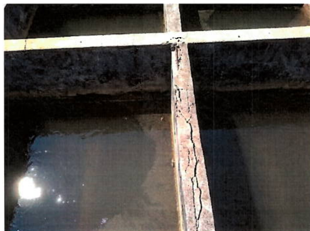
Foto 45: Rachaduras e armadura exposta sobre umas das chicanas.
