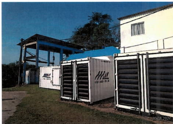
Foto 25: geradores de energia elétrica.
