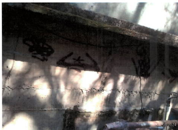
Foto 110: Área sujeita a ações de vandalismo.
