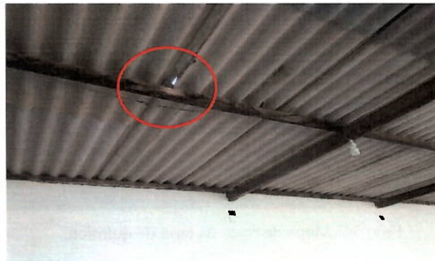
Foto 81: Telha danificada na área de armazenamento de hipoclorito de cálcio.
