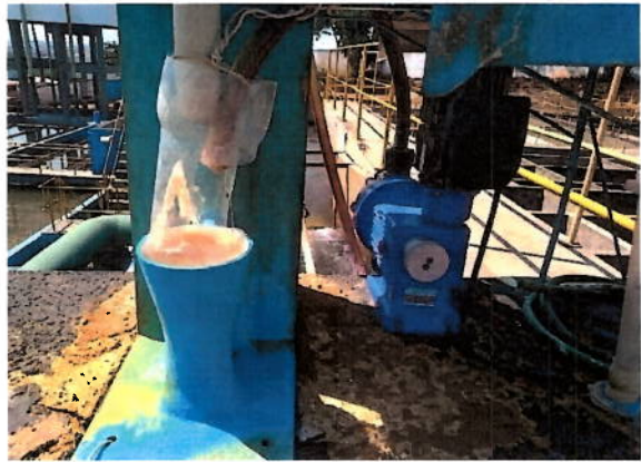
Foto 38: Bomba dosadora de sulfato de alumínio da NETA.
