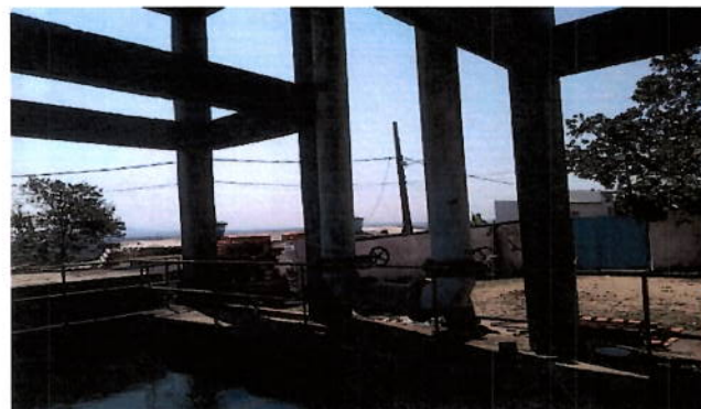
Foto 65: Vista da tubulação, que necessita reparos nas conexões, do reservatório de água de lavagem dos filtros sobre o filtro 6.
