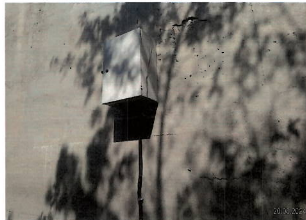
Foto 111: Caixa de telemetria. Área sujeita a ações de vandalismo.
