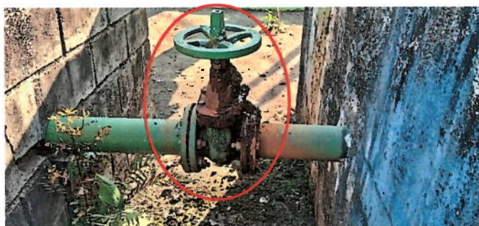
Foto 21: Registro necessitando manutenção.
