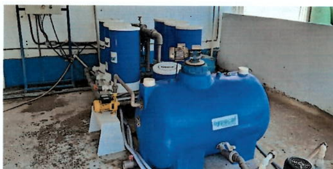
Foto 78: Sistema de dosagem de cloro. Necessária instalação de contenção.
