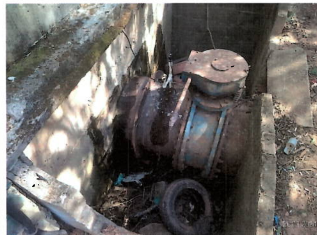
Foto 109: adutora e medidor de vazão sem proteção. Área sujeita a ações de vandalismo.
