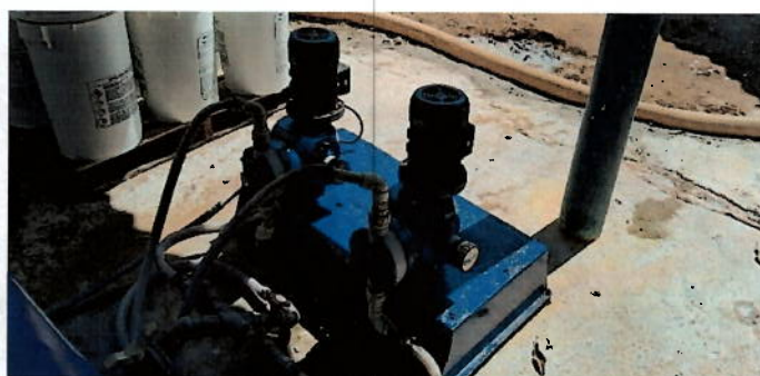
Foto 79: Bombas dosadora de cloro.
