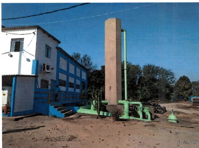
Foto 19: Vista do TAU e das tubulações de alívio de pressões na adutora de recalque de água bruta.
