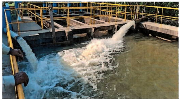
Foto 10: Chegada na água no poço de sucção. As águas vindas dos dutos laterais são provenientes das bombas submersíveis e não passa pelos canais desarenadores e carrega sólidos para o sistema. Nota-se também o uso improvisado de madeiras para evitar o retorno da água.
