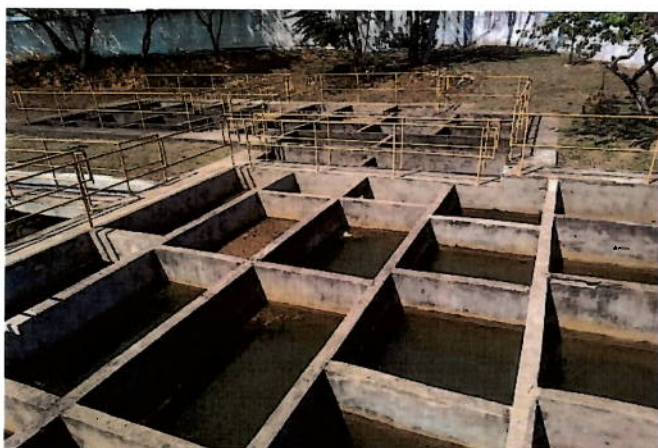
Foto 42: Módulos de floculação da NETA.
