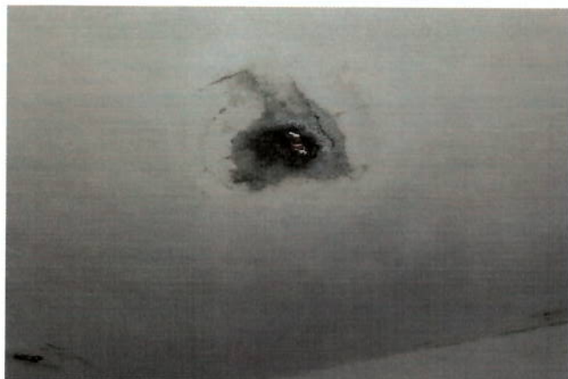
Foto 58: Casa de válvulas do filtro 6 com teto danificado.
