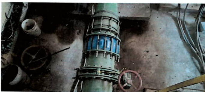
Foto 13: Tubulação de recalque dotada de válvula de retenção.
