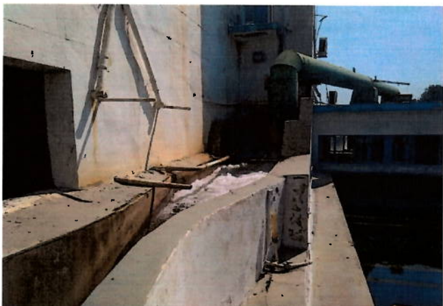
Foto 33: Primeiro ponto de chegada de água bruta na VETA.
