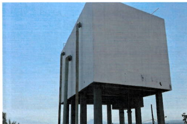
Foto 63: Vista do reservatório de água de lavagem dos filtros que fica sobre o filtro 6. Destaca-se a necessidade de instalação de escada com gaiola e guarda-corpo e ao redor da laje.
