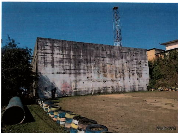
Foto 112: vista de fundos do reservatório com vazamentos.
