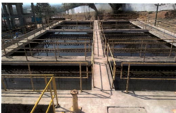
Foto 48: Vista de montante para jusante dos decantadores da NETA. Nota-se em primeiro plano corpo de registro sem volante.
