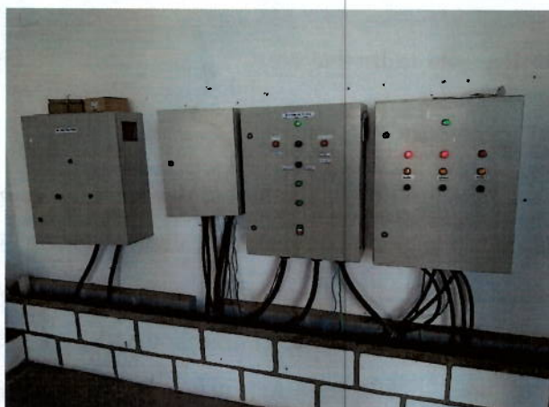
Foto 89: Painéis elétricos dos grupos motobombas.
