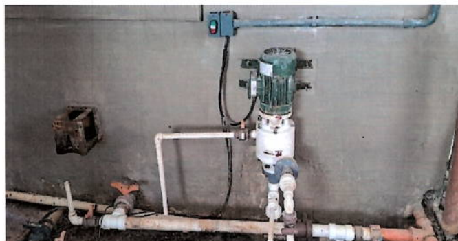
Foto 72: Bomba dosadora de coagulante.
