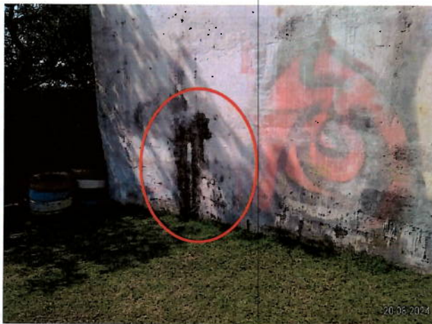
Foto 113: parede de fundos do reservatório com vazamentos.
