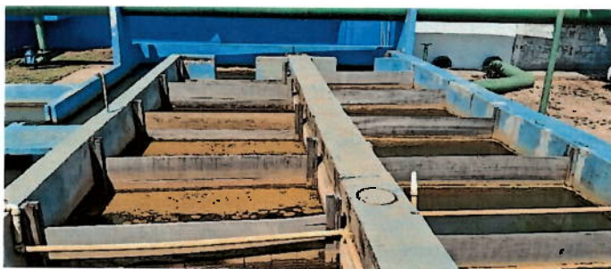
Foto 40: Módulos de floculação da VETA.
