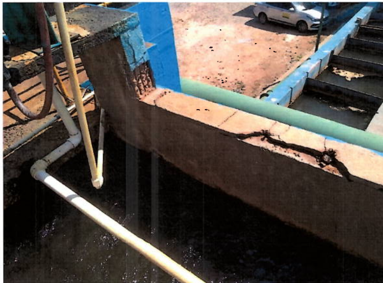
Foto 39: Área precisando de reparo no emboço das paredes do trecho de coagulação.
