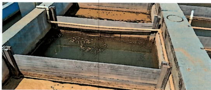
Foto 41: Detalhe da aplicação de polímero nos módulos de floculação da VETA.
