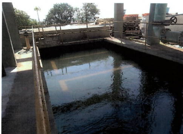
Foto 56: Vista superior do filtro 6.
