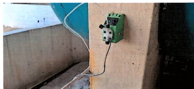
Foto 83: Sistema automático de dosagem e aplicação de flúor.
