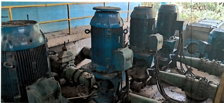
Foto 12: Casa de bombas do alto recalque.
