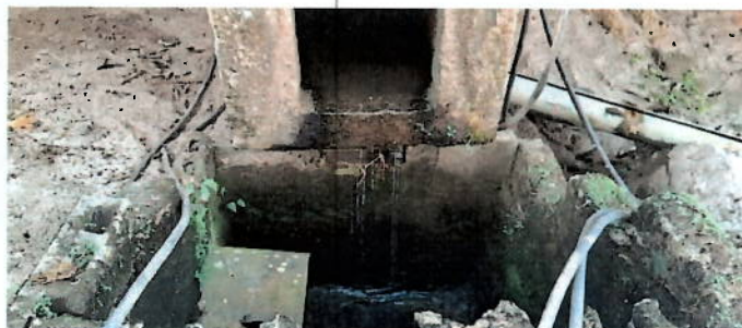
Foto 16: Saída de água por um dos canais de descarga do poço de sucção, observa-se a água oriunda do extravasamento do poço de sucção
