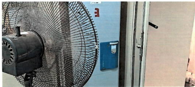
Foto 18: Inversor de frequência. Embora a sala dos painéis elétricos seja climatizada, necessita de equipamento com maior capacidade de refrigeração.
