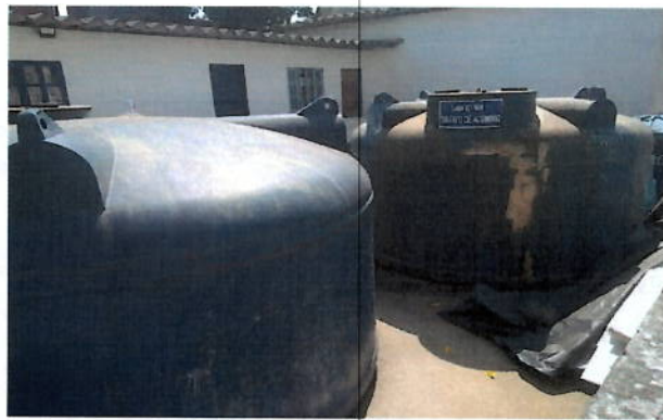
Foto 75: Armazenamento de bombonas vazias de sulfato de alumínio sobre o reservatório de água.
