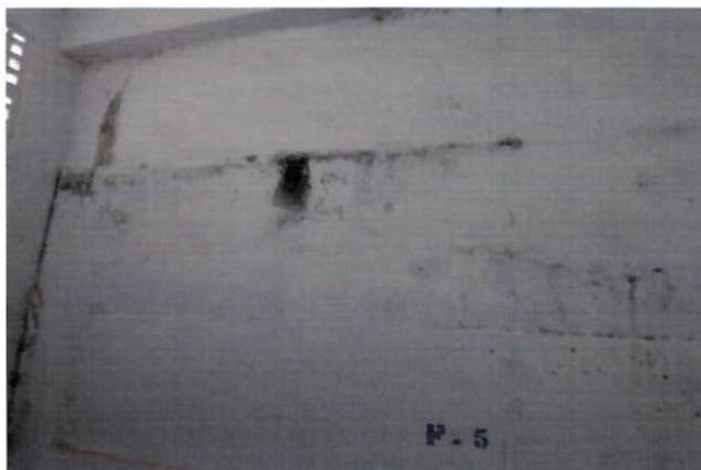
Foto 61: Casa de válvulas dos filtros 1 ao 6 com presença de pequena infiltração na parede do filtro 5.
