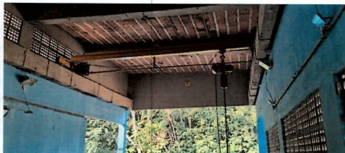
Foto 14: Vista da ponte rolante da casa de bombas.
