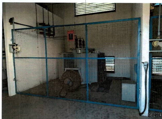
Foto 24: Vista interna da subestação.
