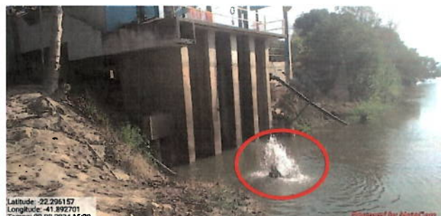
Foto 2: Estrutura de captação. Em primeiro plano vê-se uma das bombas submersíveis que apresentava problema na vedação.
