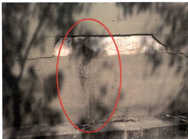
Foto 108: parede lateral do reservatório com vazamentos.
