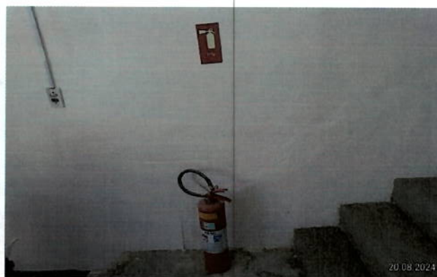
Foto 77: Extintor de incêndio na casa de química.
