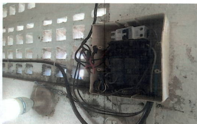
Foto 59: Casa de válvulas do filtro 6 com quadro elétrico sem tampa.
