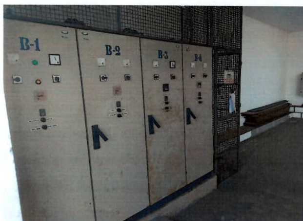
Foto 88: Painéis elétricos dos grupos motobombas.
