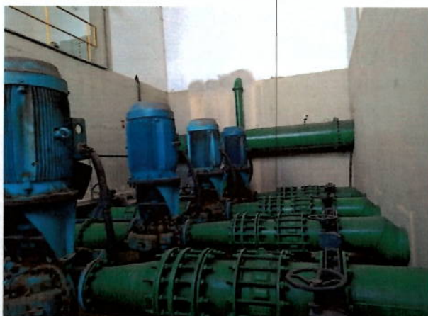
Foto 87: grupos motobombas da EEAT.
