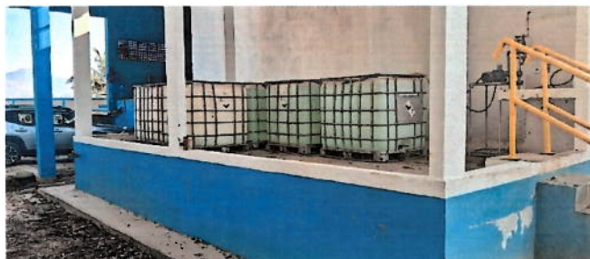
Foto 30: Área reservada para o peróxido de hidrogênio que pode ser usado em pré-tratamento dependendo da qualidade da água bruta. Área coberta e dotada de contenção.
