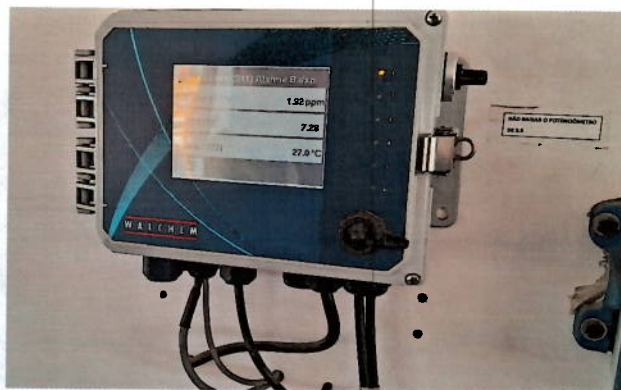
Foto 97: Sala de controle operacional – medição de cloro, pH e temperatura.
