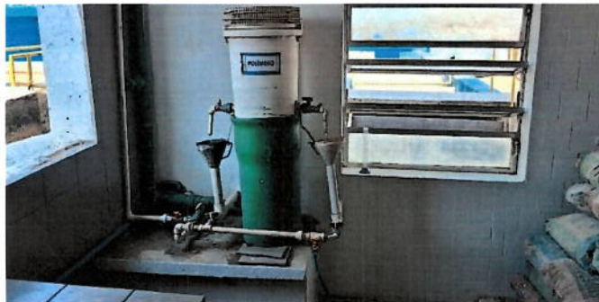
Foto 69: Sistema manual de dosagem de polímero.
