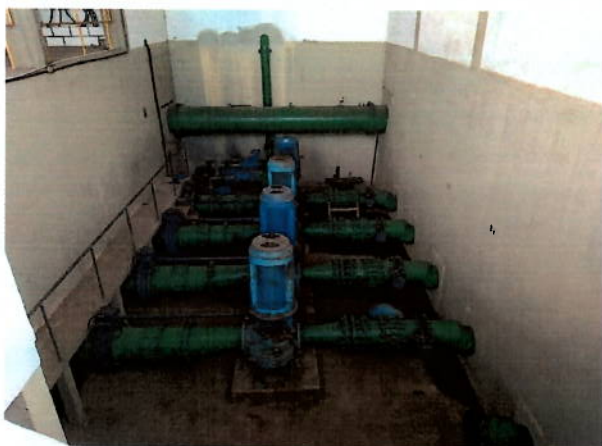
Foto 86: grupos motobombas da EEAT.
