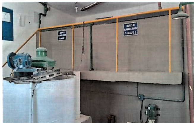
Foto 71: Tanques de sulfato de alumínio identificados e dotados de tampas.
