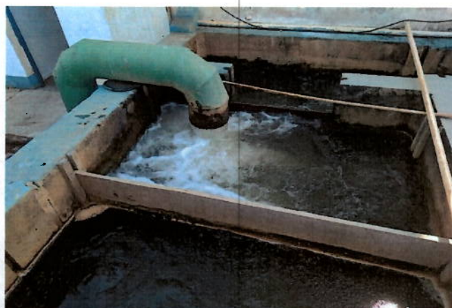
Foto 34: Segundo ponto de chegada de água bruta na VETA.
