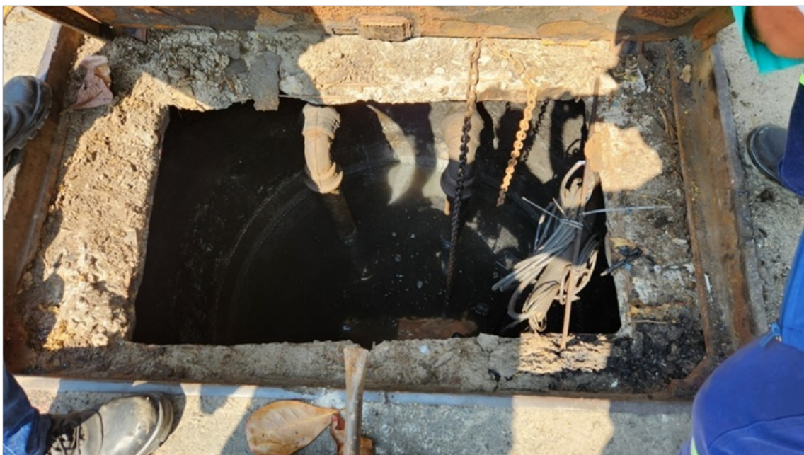
Foto 2 - Poço de sucção
