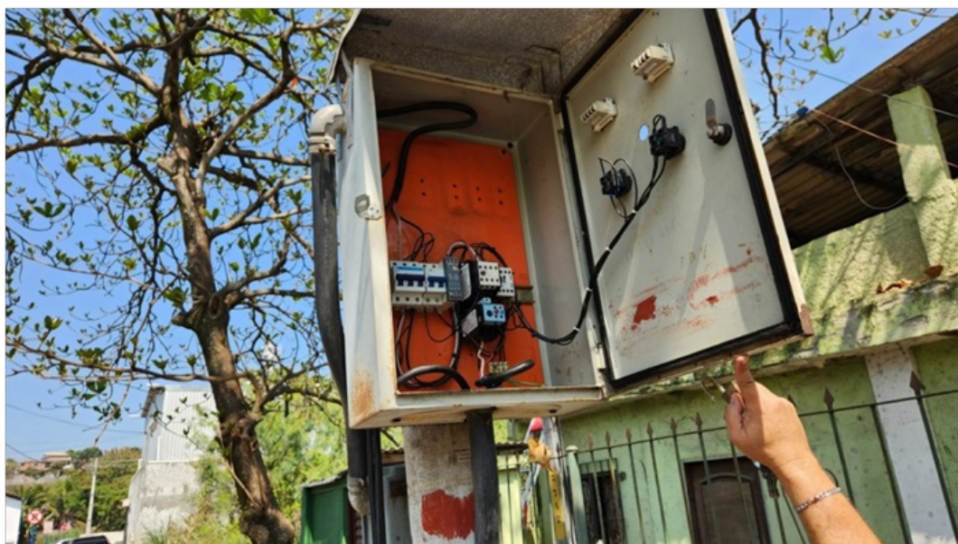
Foto 3 - Quadro de elétrica
