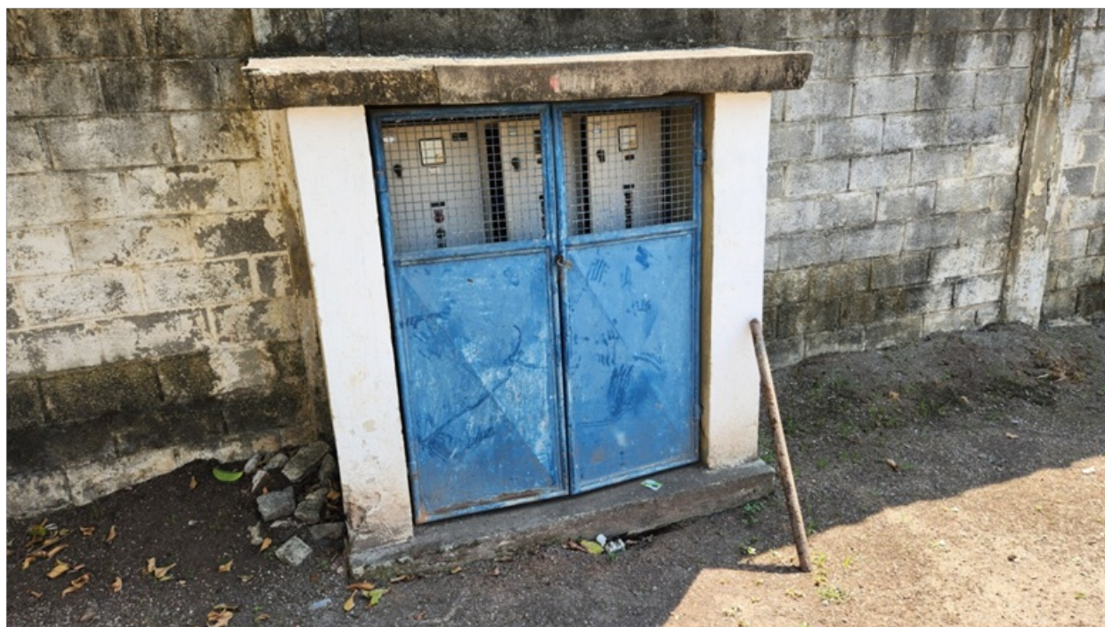
Foto 5 – Quadros de comando elétrico
