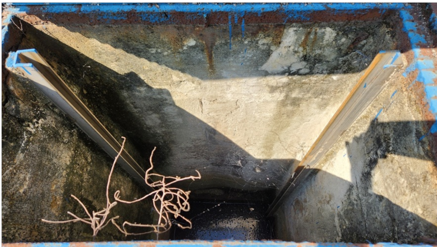
Foto 6 – Poço de chegada, sem gradeamento
