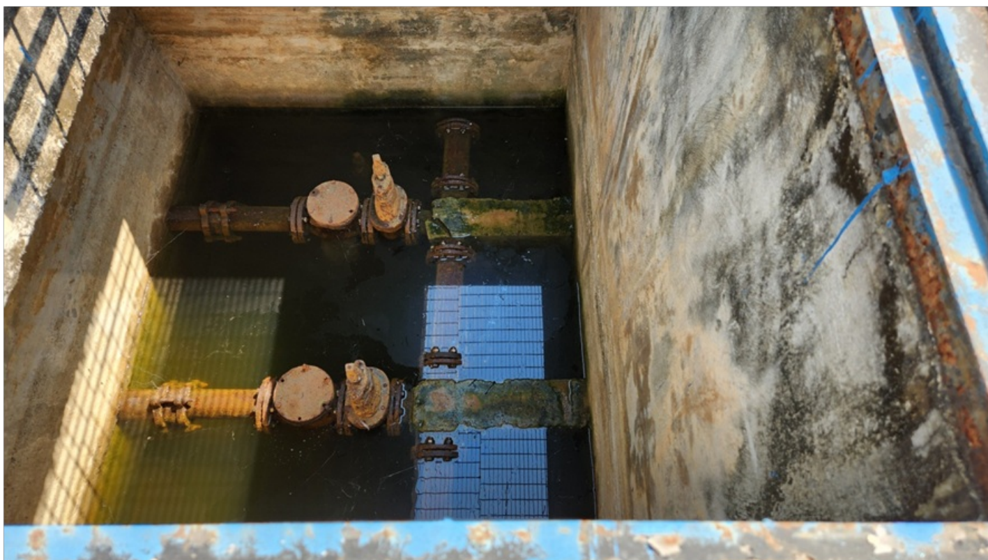
Foto 3 – Barrilete de recalque
