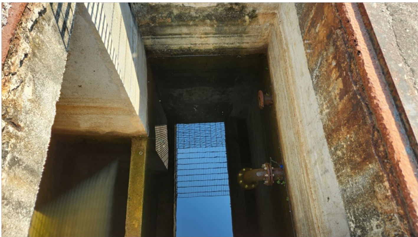
Foto 4 – Poço de sucção das bombas, sem bombas
