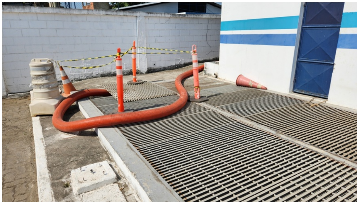
Foto 7 – Barrilete de recalque
