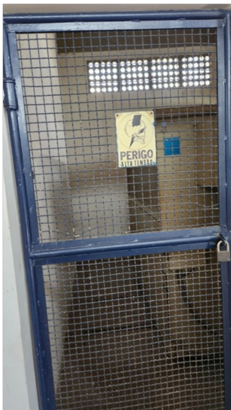
Foto 6 – Entrada da subestação
