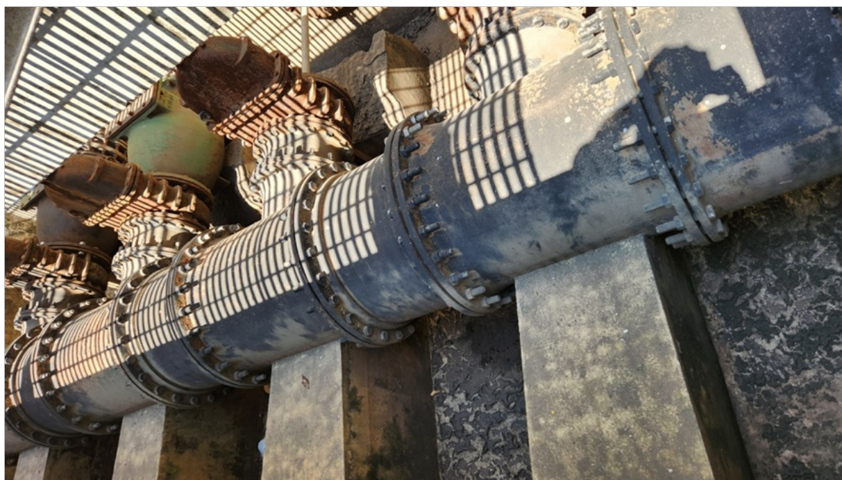
Foto 8 – Tubulação do barrilete de recalque
