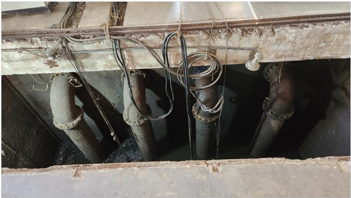
Foto 4 – Poço de sucção
