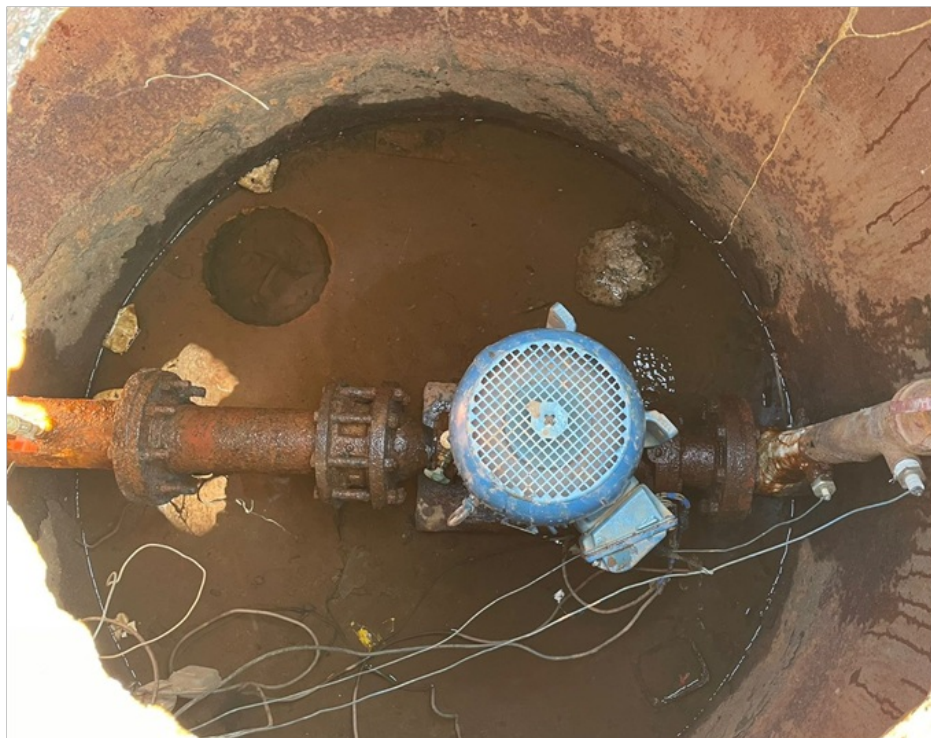
Foto 4 – Presença de água na caixa cilíndrica de aço
