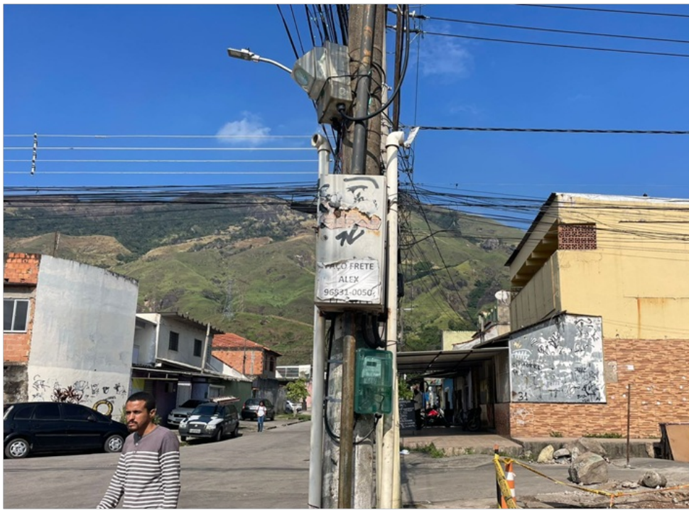
Foto 5 – Abrigo do painel de automação fechado, bastante deteriorado.
