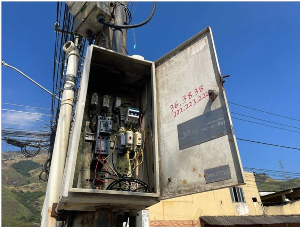
Foto 6 - Abrigo do painel de automação aberto, bastante deteriorado, sem sinalização de risco de choque elétrico.
