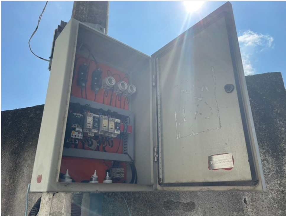
Foto 4 – Abrigo do painel de automação aberto, desativado.
