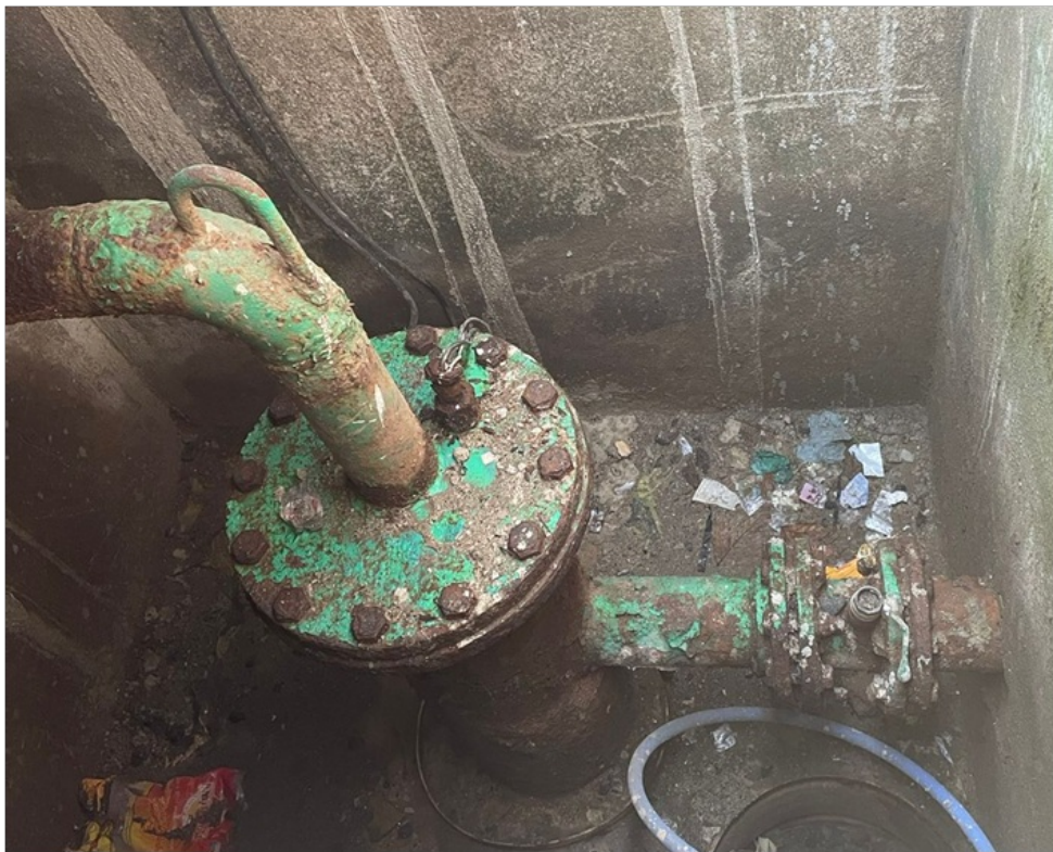
Foto 2 – Conjunto motobomba no abrigo subterrâneo.
