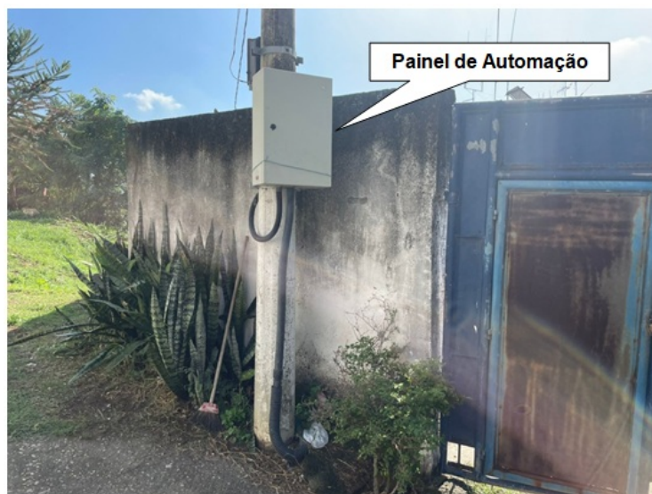
Foto 3 – Abrigo do painel de automação fechado e desativado.
