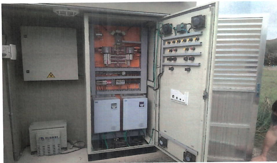
Foto 5 – Painel Elétrico de Comando das Bombas.
