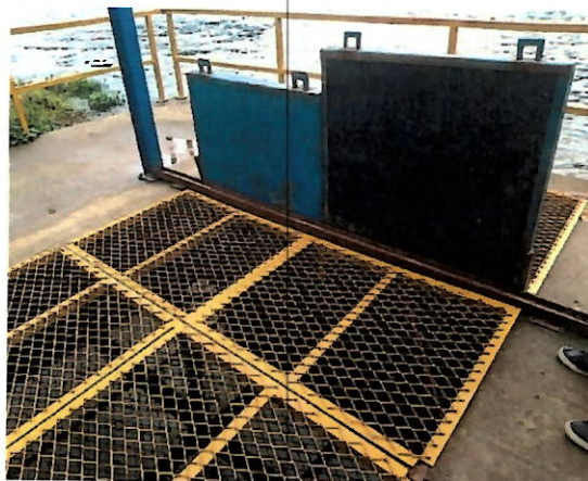
Foto 42- Grades para contenção de sólidos.
