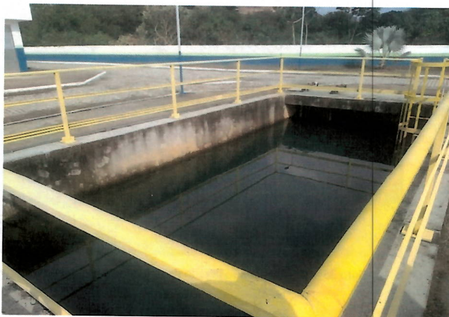
Foto 23 - Tanque de chegada da água residual de tratamento.
