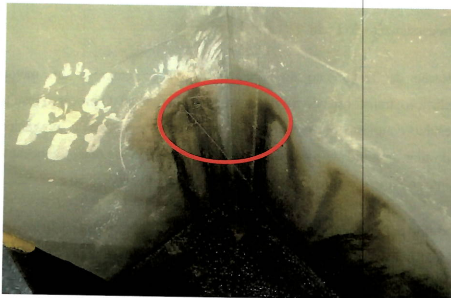
Foto 19 - vazamento em um dos tanques de descarga dos filtros.
