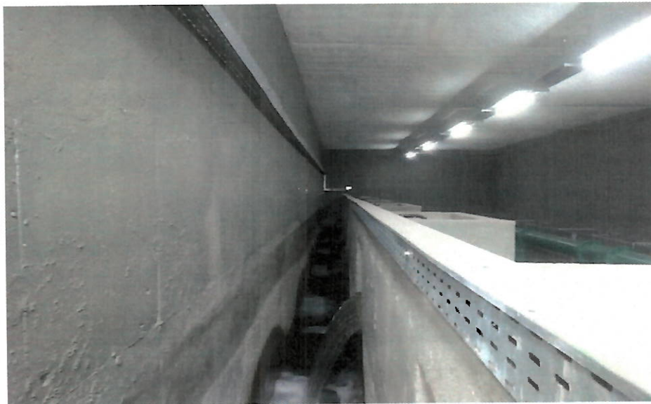
Foto 17 - Descargas dos filtros.
