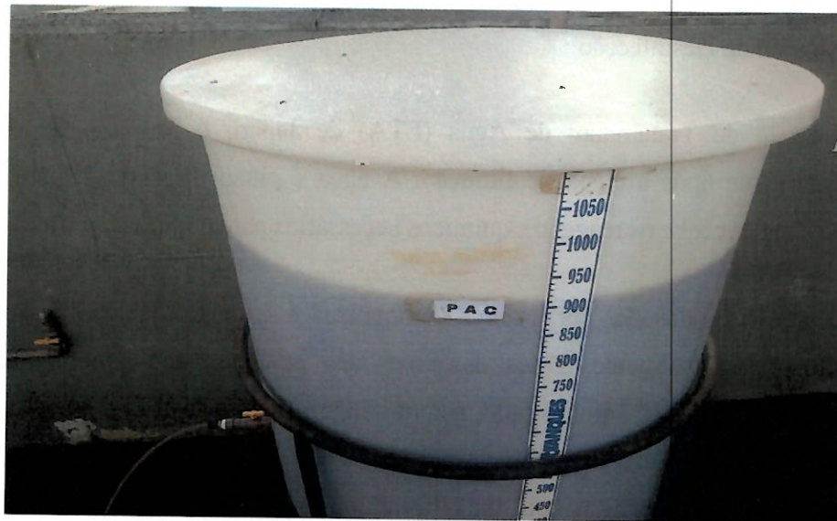
Foto 26 – Tanque de Policloreto de Alumínio (PAC).
