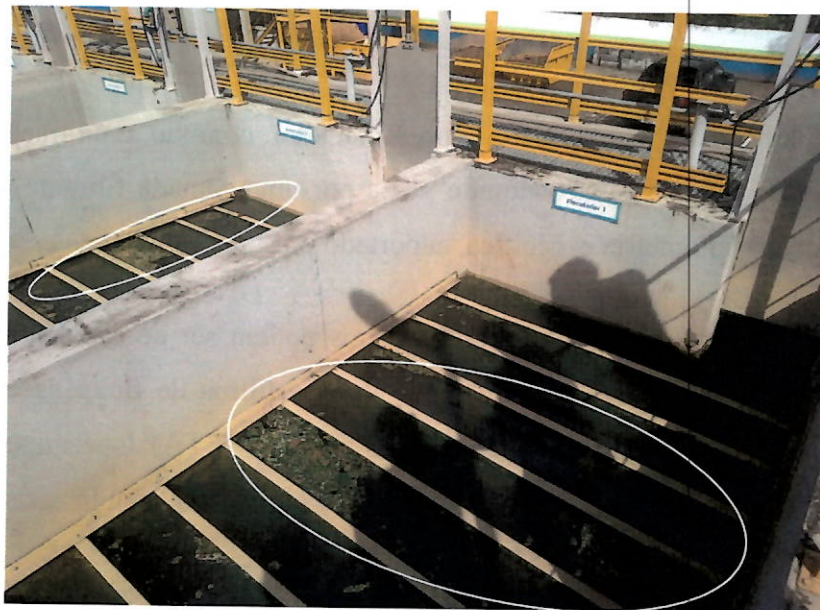
Foto 13 – acúmulo de microalgas nos floculadores.
