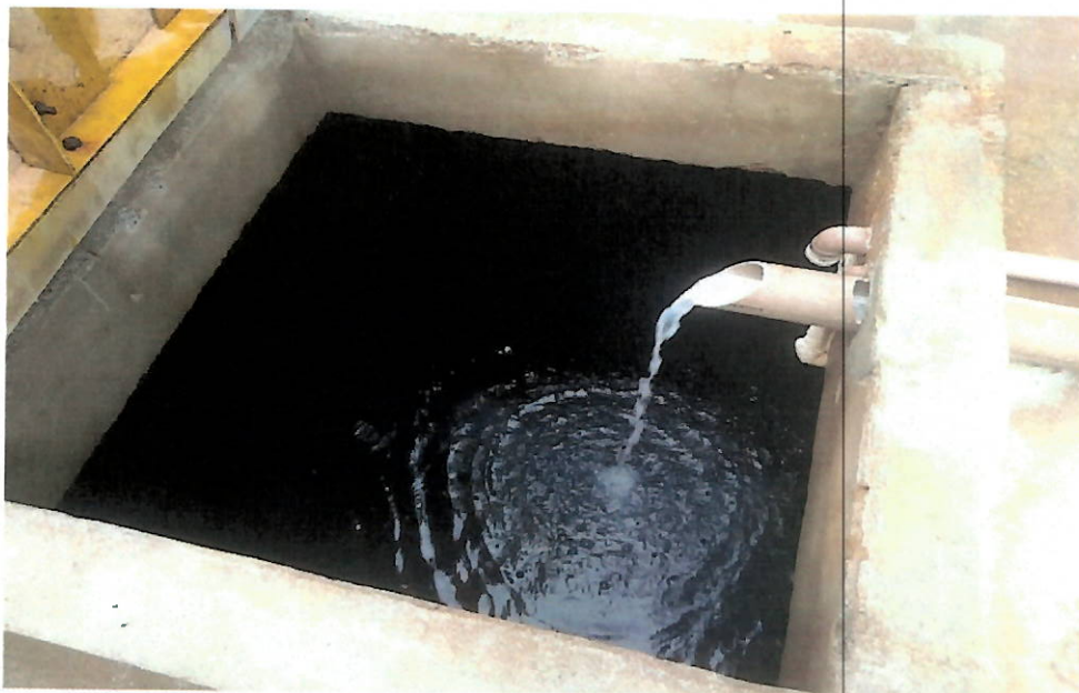
Foto 29 – Reservatório de contato com capacidade 200 m³.
