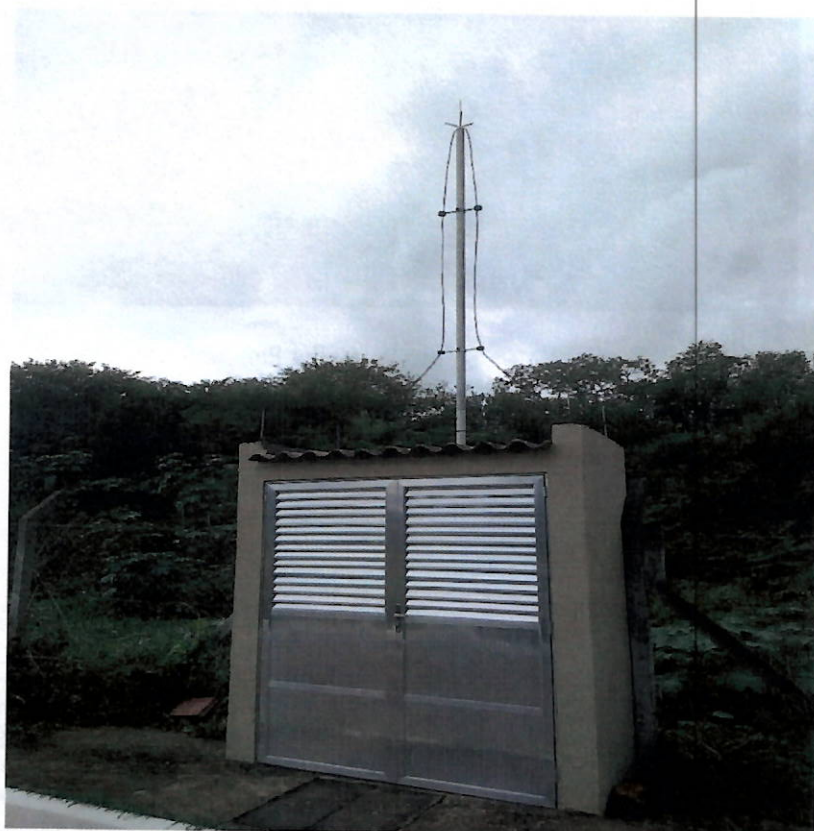
Foto 7 - Sistema de proteção contra descargas atmosféricas.
