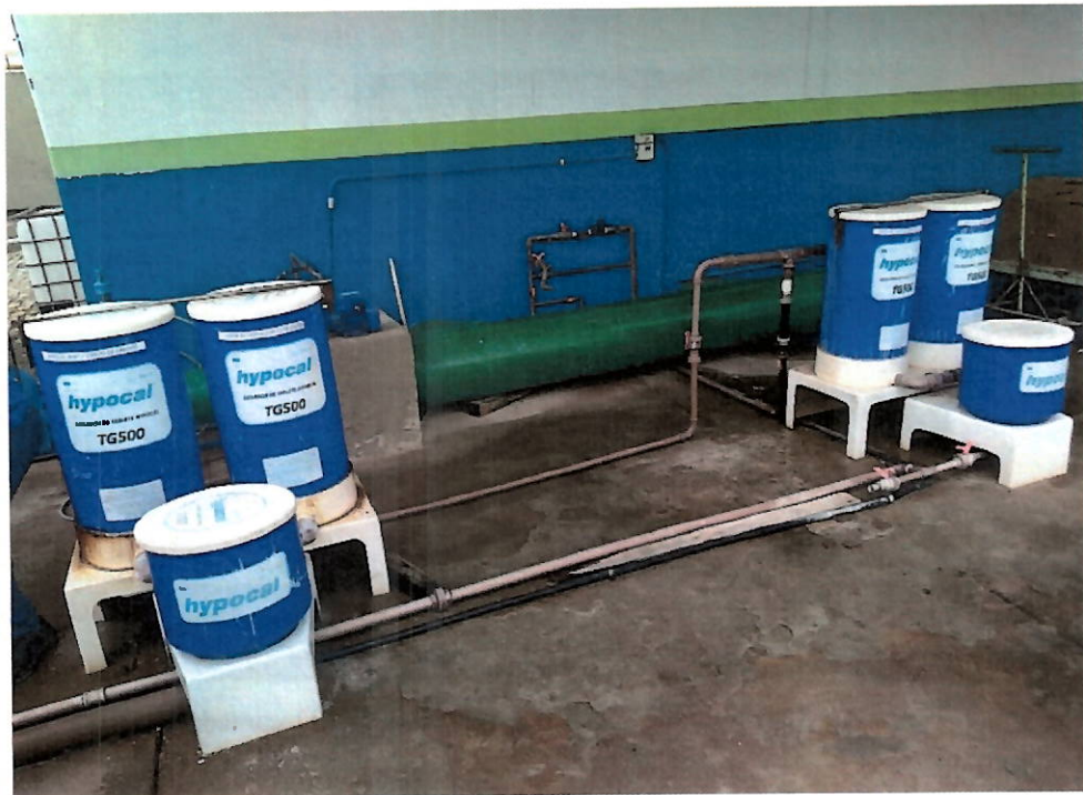
Foto 28 - Sistema de dosagem de hipoclorito de cálcio.
