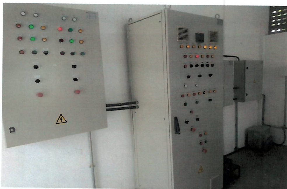
Foto 34 - Painelelétrico de Comando das Bombas.
