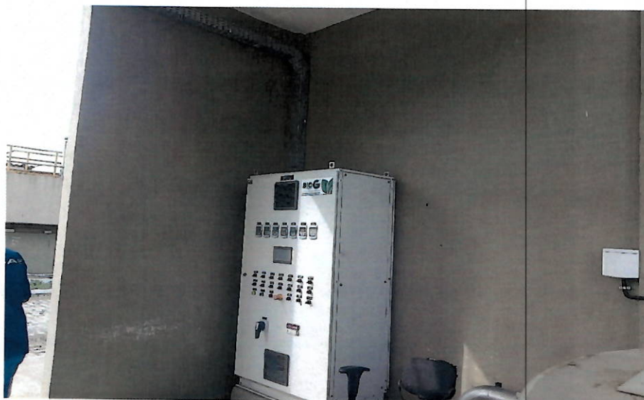
Foto 22 - Não foi identificado o número do IP do Painel Elétrico de Comando que identifica o grau de proteção contra sólidos e contra líquidos. O equipamento está sujeito a precipitação horizontal devido a ventos.
