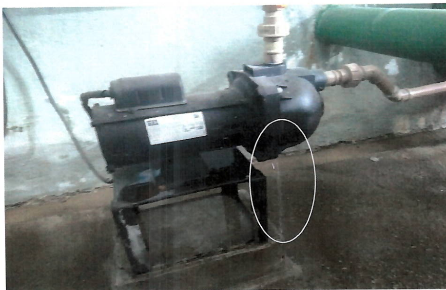
Foto 18 – vazamento em uma das bombas da saída dos filtros.
