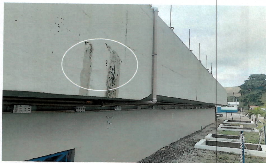
Foto 27 – Sinais de vazamento no Decantador 1.
