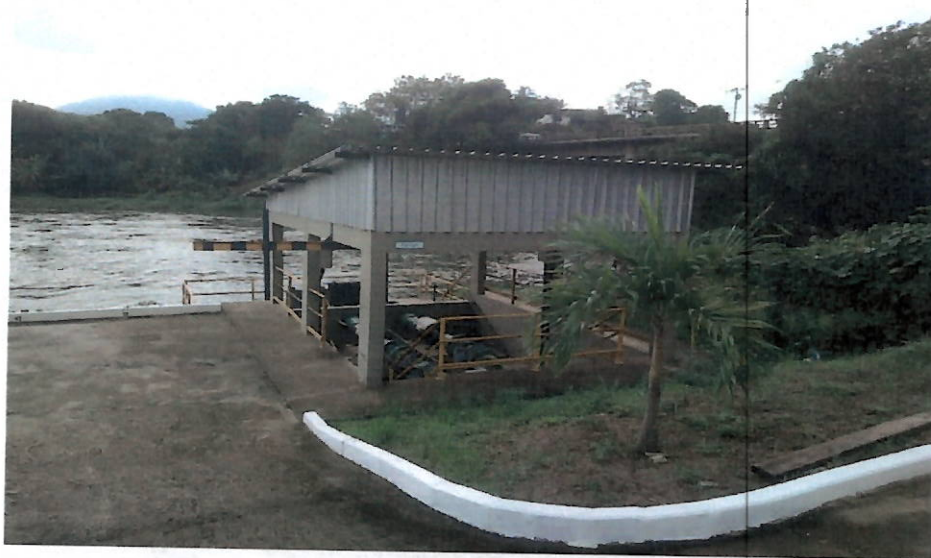
Foto 2 - Captação e sistema de bombeamento de água bruta.
