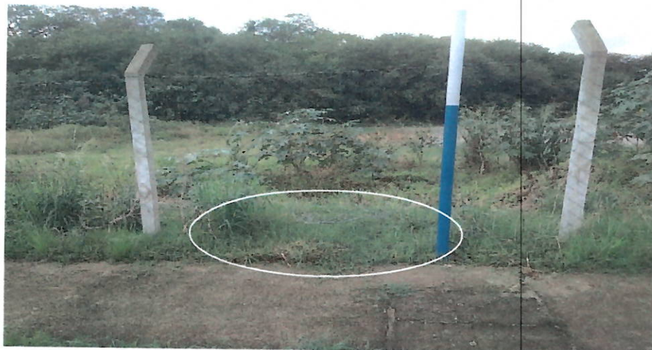
Foto 6 - Cercamento da E.T.A. Japeri danificado.
