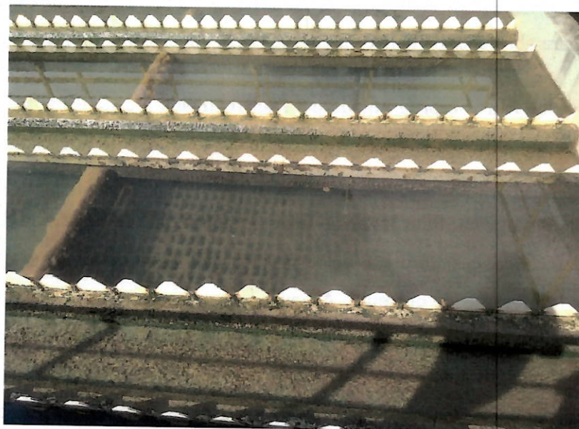
Foto 14 – decantadores necessitando de limpeza.
