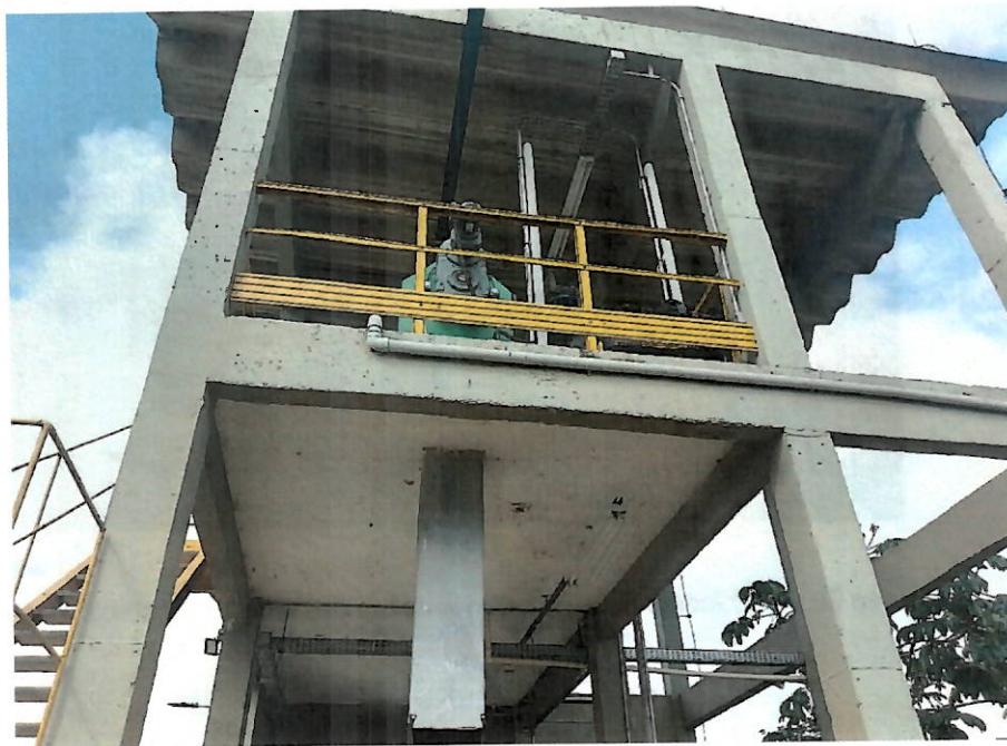
Foto 21 - Unidade de tratamento de lodo.
