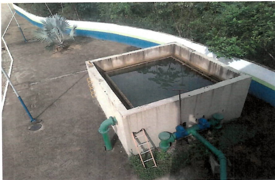
Foto 24 - Tanque de Decantação do Lodo Tratado.
