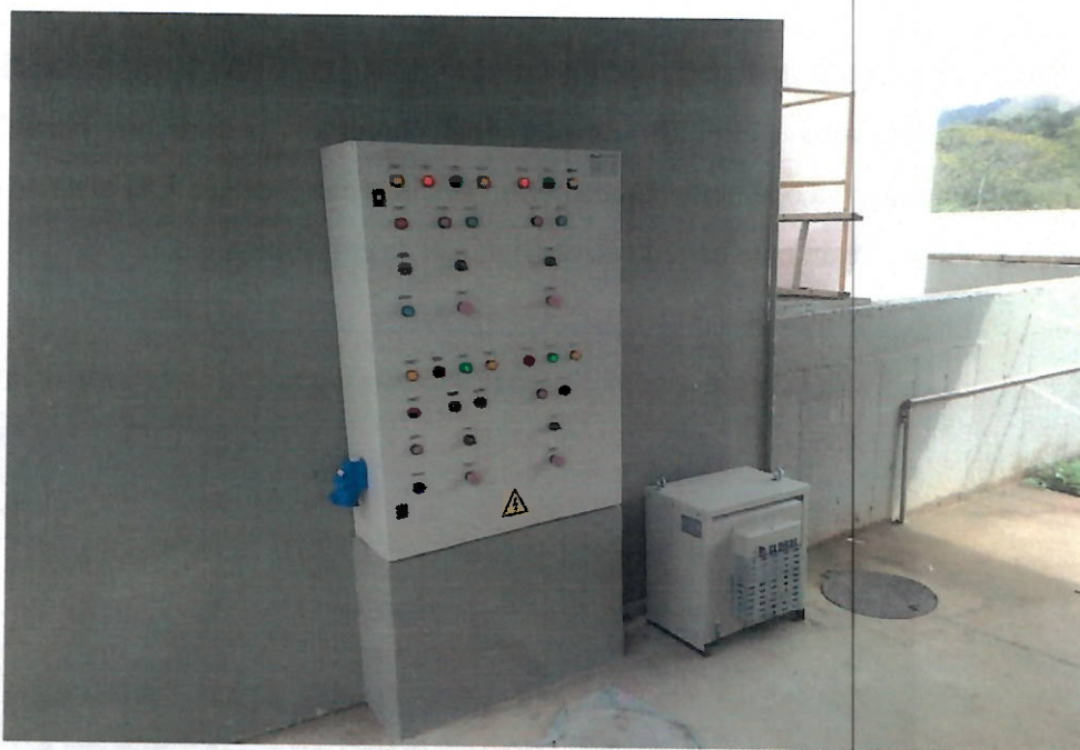
Foto 30 - Não foi identificado o número do IP do Painelelétrico de Comando que identifica o grau de proteção contra sólidos e contra líquidos. O equipamento está sujeito a precipitação horizontal devido a ventos.
