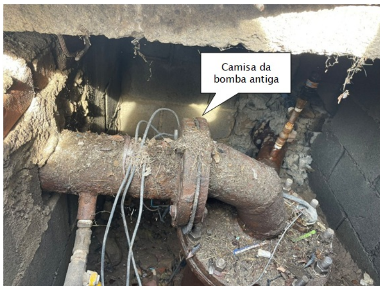
Foto 4 - Abrigo subterrâneo do conjunto motobomba.
