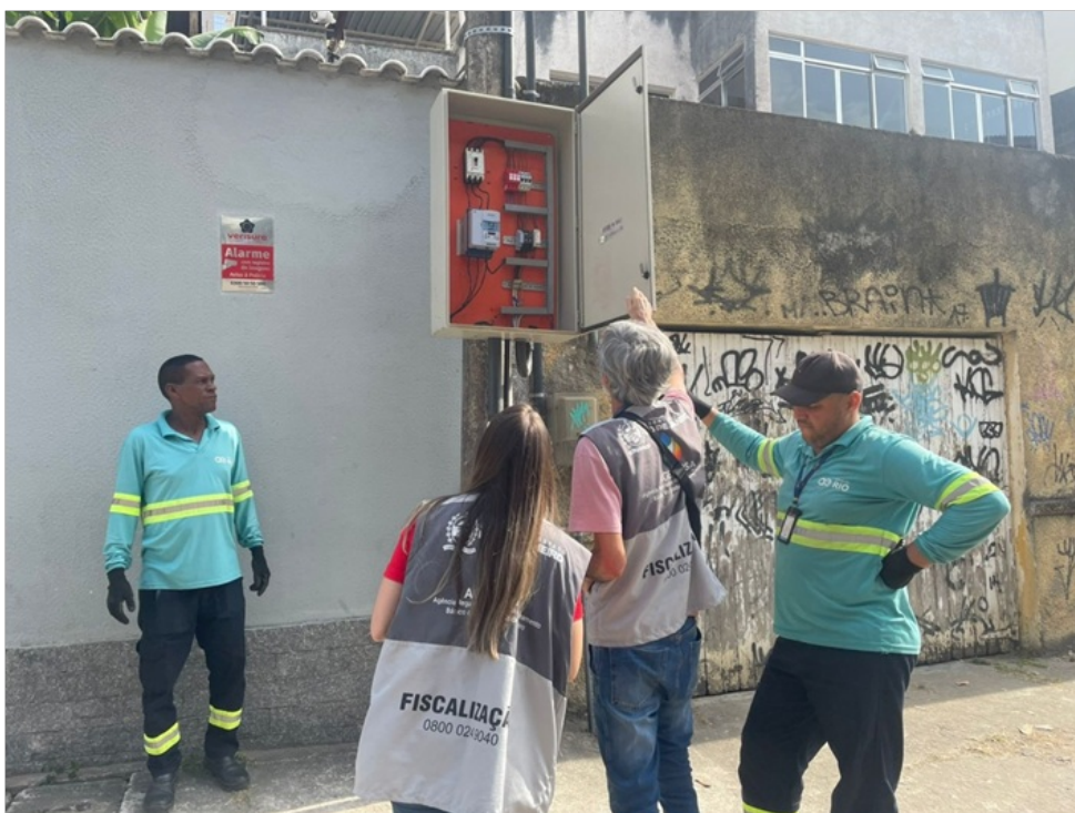
Foto 7 - Fiscalização do quadro elétrico da EEAT.
